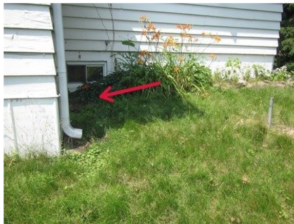
Pente négative à l'arrière gauche vers l'extension arrière
