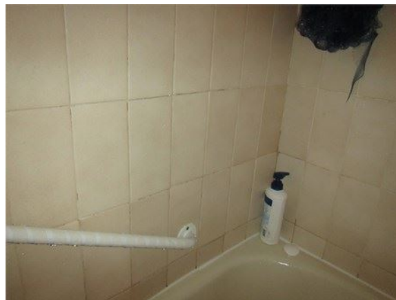
Joints de coulis foncés indiquant une perte d'étanchéité
