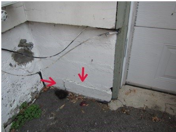
Fissure avec déplacement sur le mur avant du garage, côté gauche
