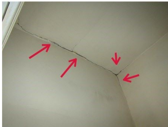
Fissures dans un placard
