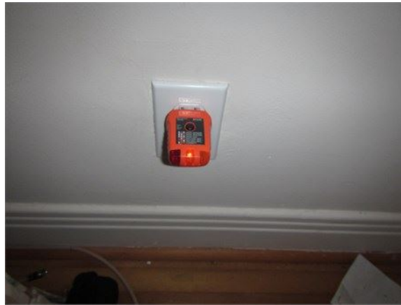
Exemple de prise sans mise à la terre dans la chambre avant
