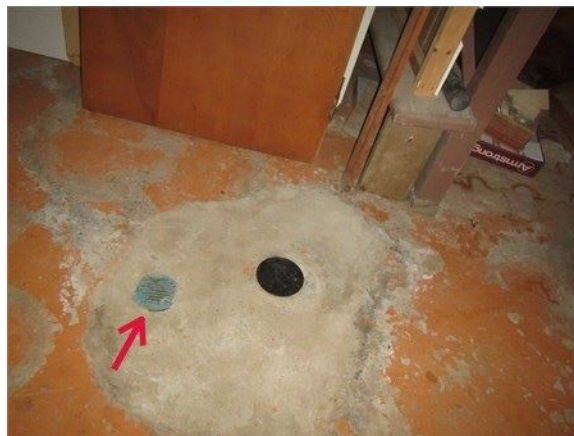
Le drain de plancher et la présence d'un clapet antiretour
