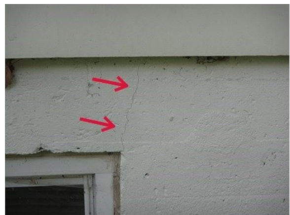
Fissure mineure au coin supérieur avant de la fenêtre la plus arrière du mur latéral gauche
