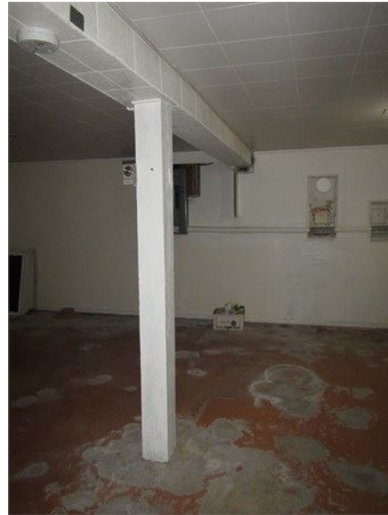
Peinture qui écaille sur la dalle du sous-sol et efflorescence
