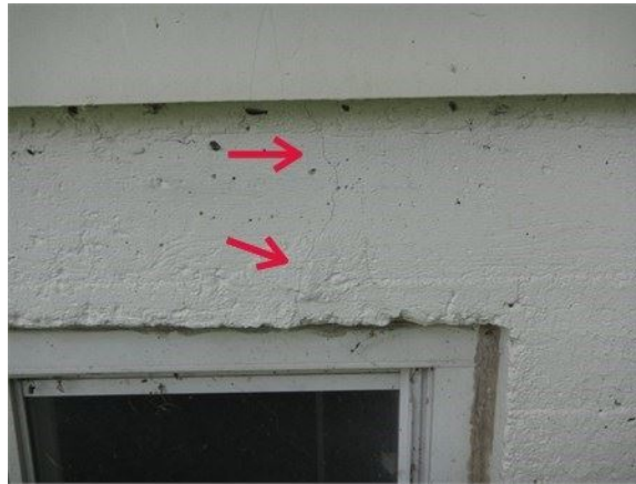
Fissure mineure au-dessus de la fenêtre la plus avant du mur latéral gauche
