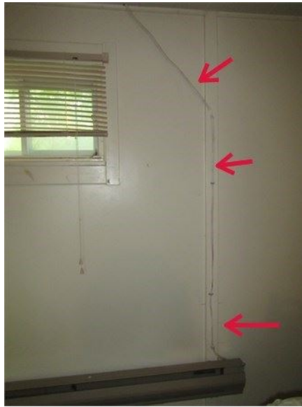
Câble à protéger
