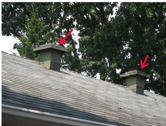
Les deux aérateurs sur la pente arrière du toit
