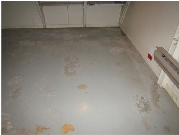
Peinture qui s'écaille et taches d'eau séchée et d'efflorescence indiquant la présence d'humidité
