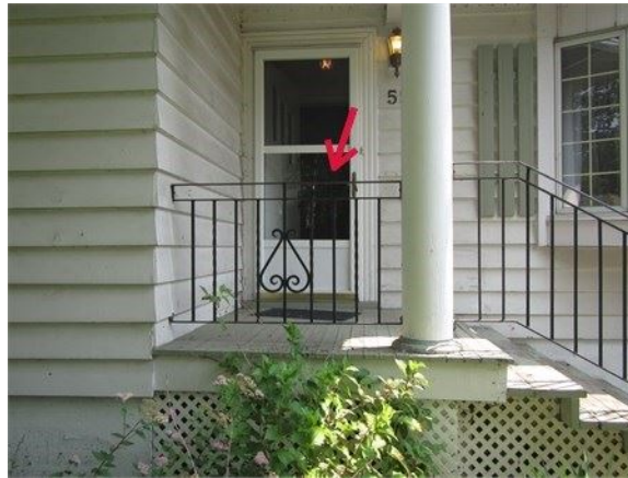
Garde-corps trop bas sur le perron avant et barrotins qui peuvent être escaladés
