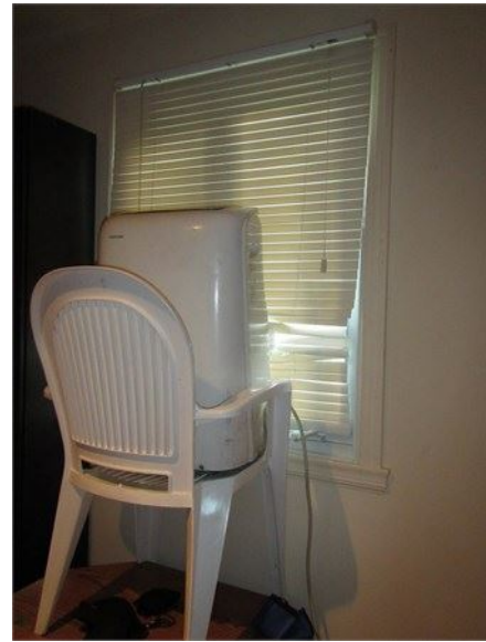
Unité de climatisation dans la fenêtre de la chambre arrière
