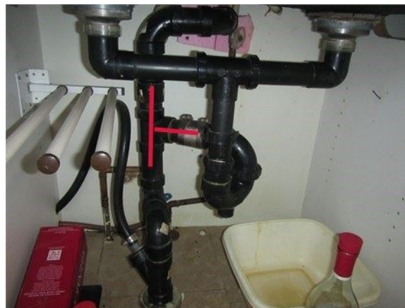
Connecteur en "T" à remplacer
