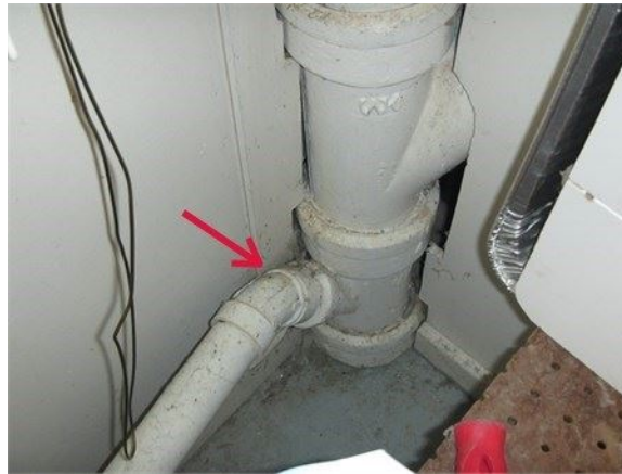
Regard de nettoyage remplacé par une conduite d'évacuation, ce qui est fautif
