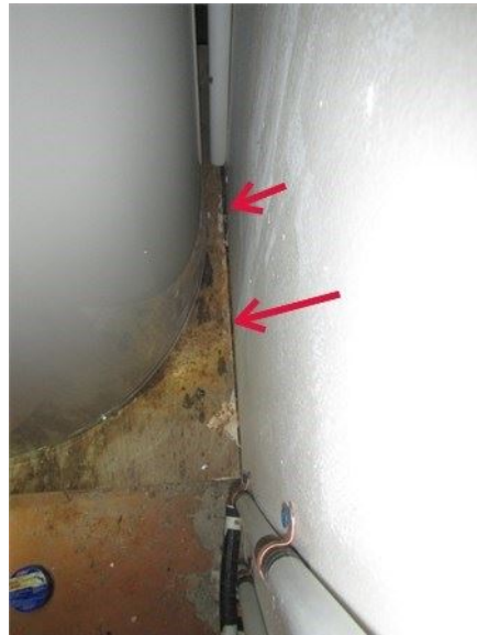
Contreplaqué souillé derrière le chauffe-eau
