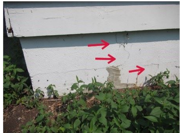
Fissures sur le mur latéral droit du garage
