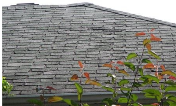
Bardeaux âgés sur la couverture à remplacer
