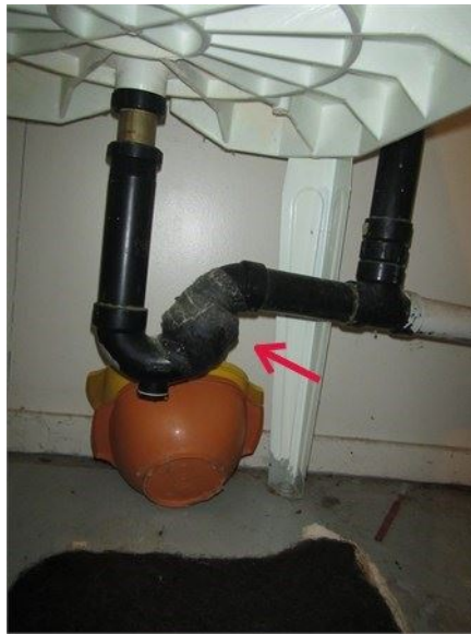
Réparation enrubannée à corriger sous la cuve de lavage au sous-sol
