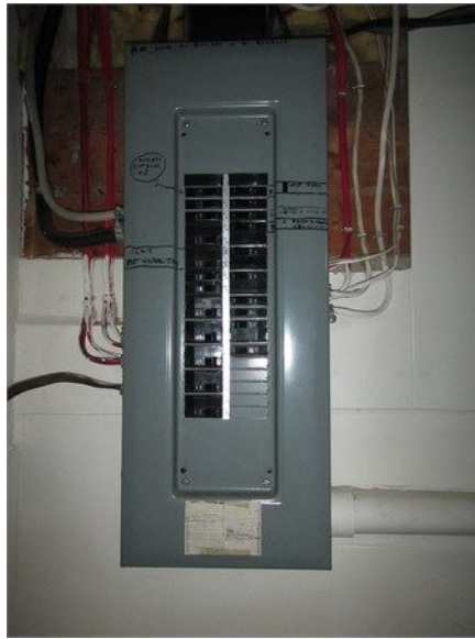
Le panneau de distribution électrique au sous-sol
