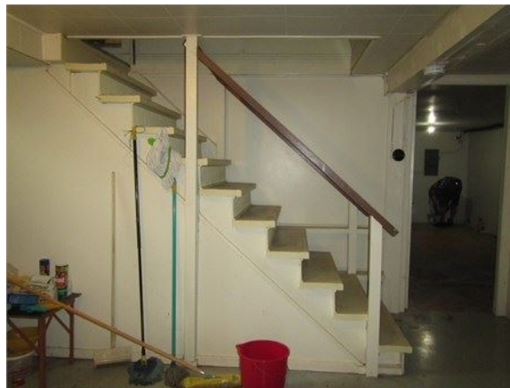
Installer un garde-corps du côté ouvert de l'escalier du sous-sol
