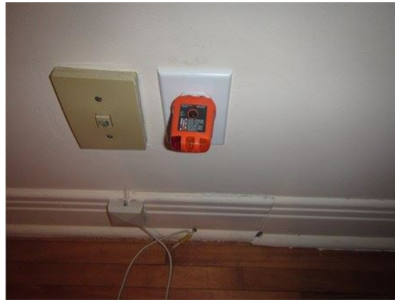
Prise non fonctionnelle dans la chambre avant à faire vérifier
