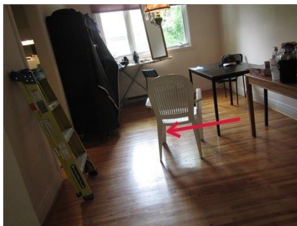
Le plancher de la salle à manger penche vers la gauche
