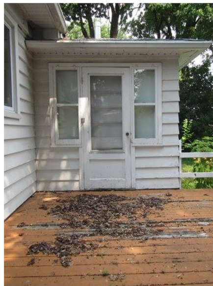
Vieille porte très énergivore dans l'extension arrière
