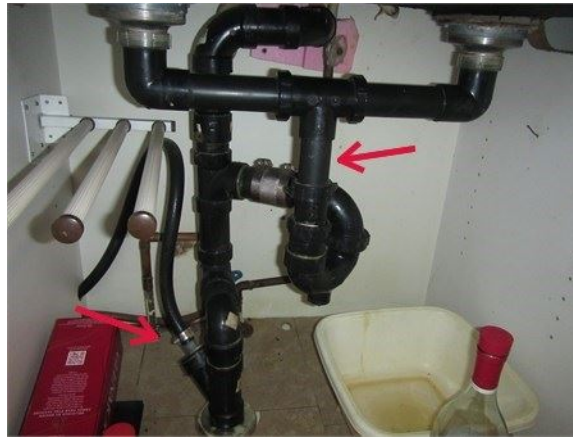
La conduite du lave-vaisselle (flèche du bas) doit être déplacée au-dessus du siphon (flèche du haut)
