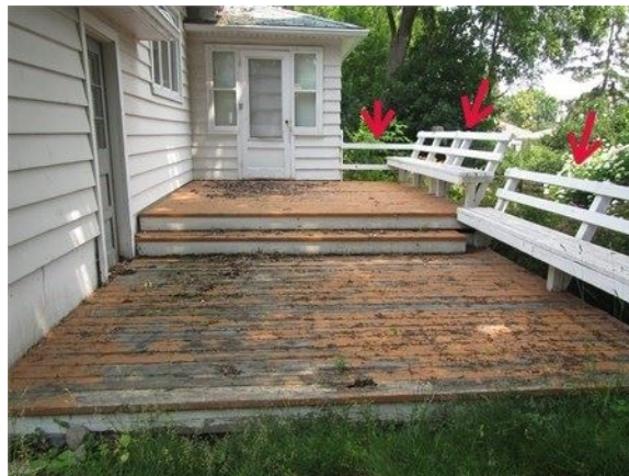
Garde-corps assurés par des bancs
