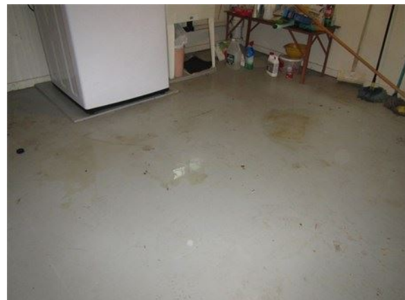
Eau au sol sous la salle de bains
