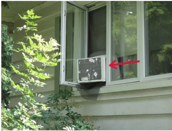
Unité de climatisation dans la fenêtre de la chambre avant
