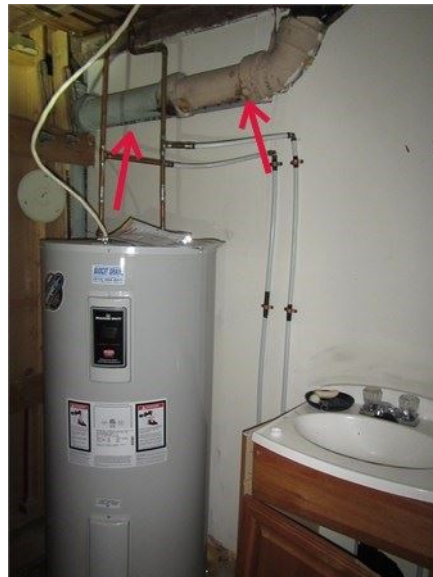
Début de fuite sous le collecteur en hauteur au sous-sol
