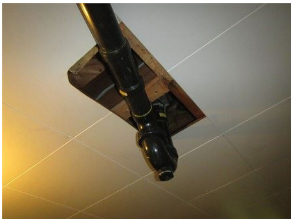
Fuite sous la salle de bains du rez-de-chaussée
