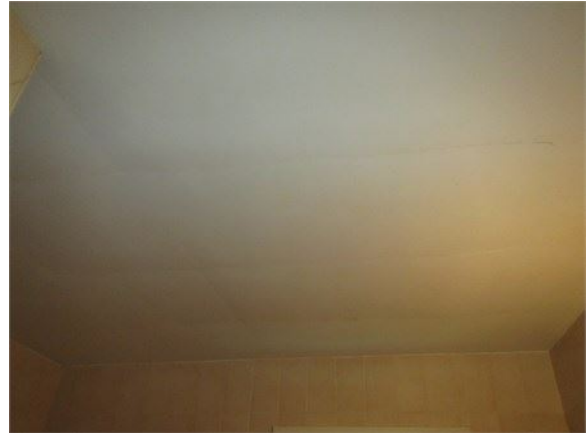
Gyplap ondulé au plafond de la salle de bains
