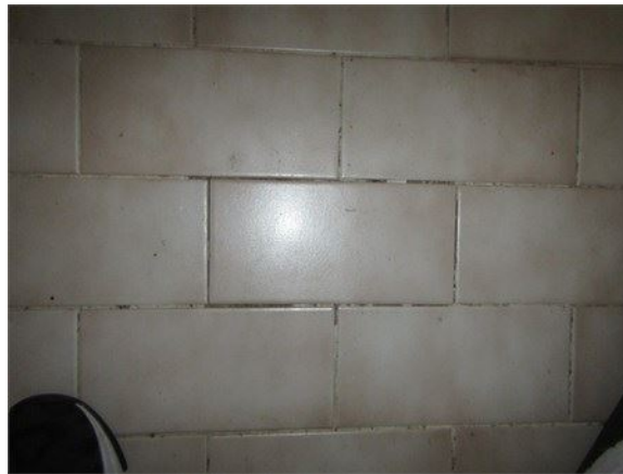
Joints de coulis à refaire dans le portique d'entrée
