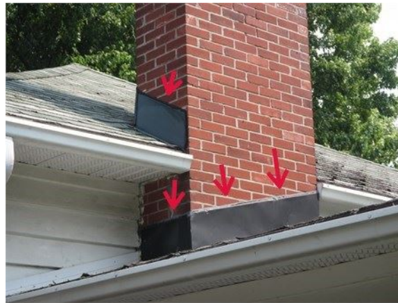
Les solins de cheminée sont posés en surface et simplement calfeutrés en place, ce qui est à risque d'infiltrations d'eau
