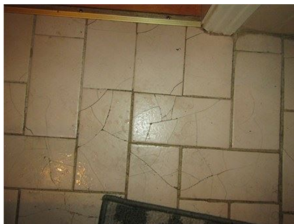
Carreaux largement fissurés dans la salle de bains
