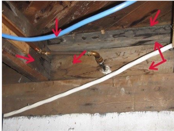
Traces d'infiltrations d'eau sur la solive de rive et sur une solive en appui sur le mur avant
