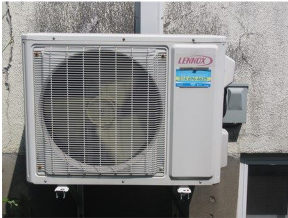
Le compresseur extérieur sur le mur latéral gauche
