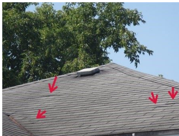
Pose irrégulière de bardeaux à surveiller et à corriger au besoin
