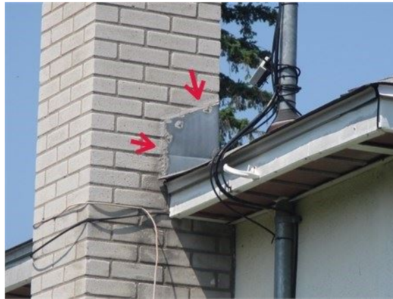
Solin calfeutré seulement en surface de la cheminée
