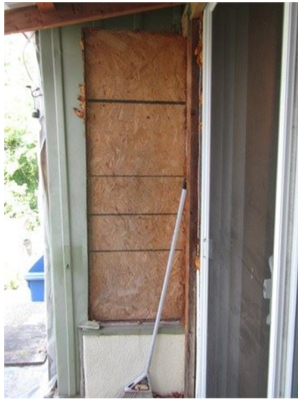
Finition incomplète sur un mur extérieur à l'arrière
