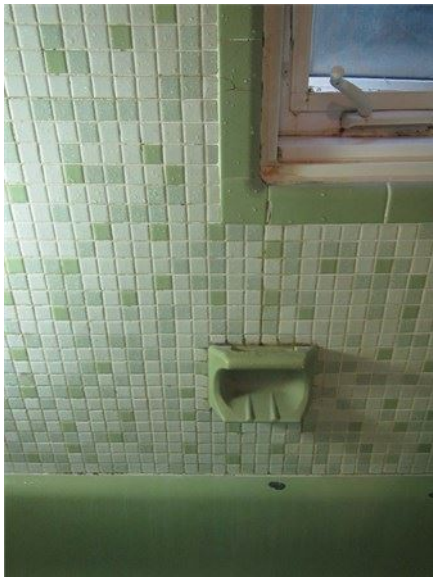
Carreaux de céramique non étanches autour de la baignoire
