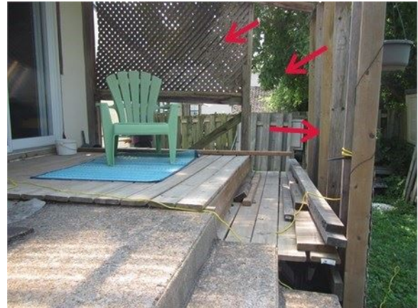
Garde-corps dangereux autour du balcon arrière
