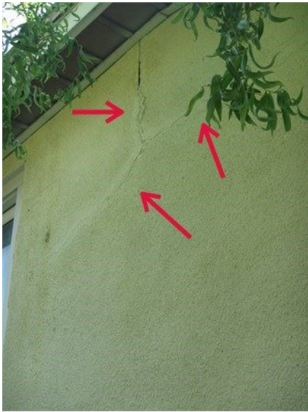
Fissures en hauteur et détachement du stuc sur le mur latéral droit
