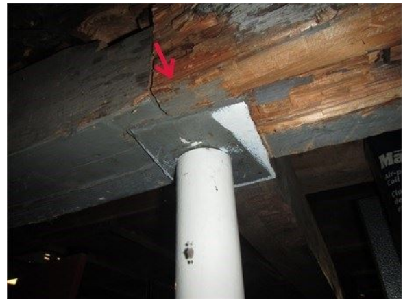
Plaquette trop petite sous un poteau et aucune fixation à corriger
