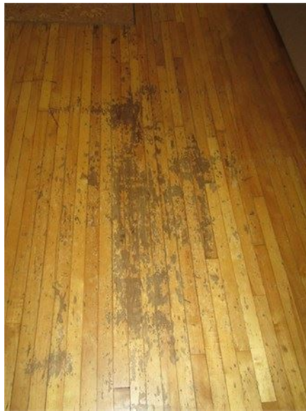
Vernis usé sur un parquet
