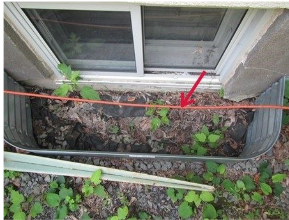
Exemple de margelle à nettoyer devant une fenêtre du sous-sol
