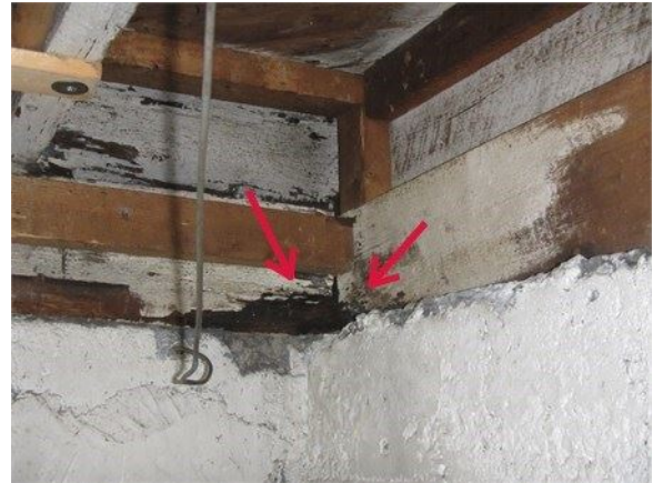
Pourriture de la solive de rive sur le coin avant droit
