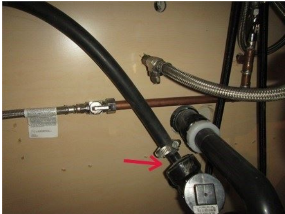
La connexion du lave-vaisselle n'est pas sur la conduite de l'évier de la cuisine
