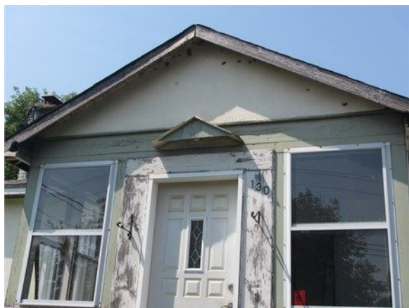
Absence de solins au-dessus de la porte et des fenêtres. Noter la moulure au-dessus de la porte qui doit aussi posséder un solin
