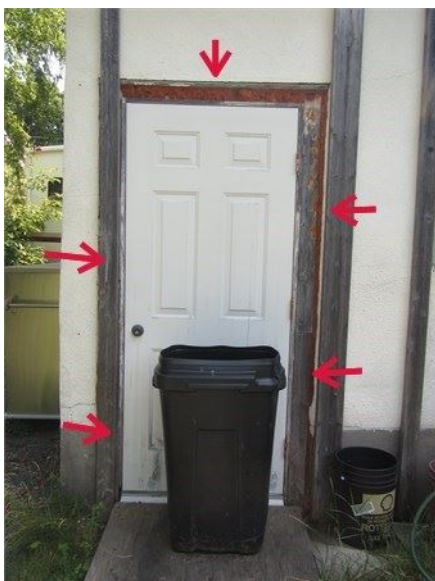
Finition incomplète autour de la porte du sous-sol sur le mur arrière, en guise d'exemple
