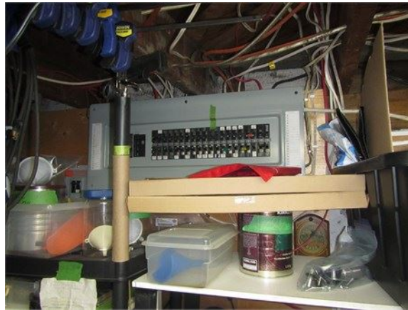
Enlever les étagères devant le panneau de distribution électrique
