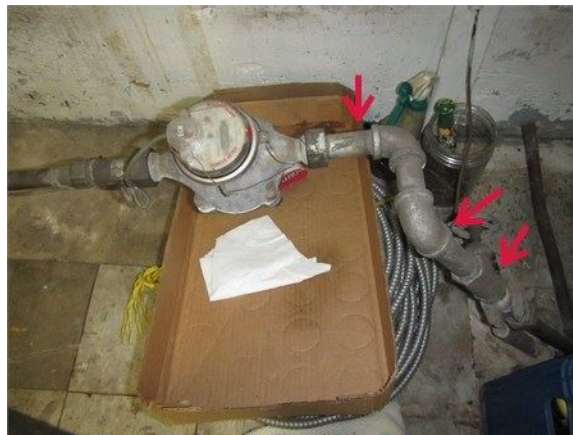
Section en acier galvanisé entre la valve d'entrée d'eau et le compteur d'eau
