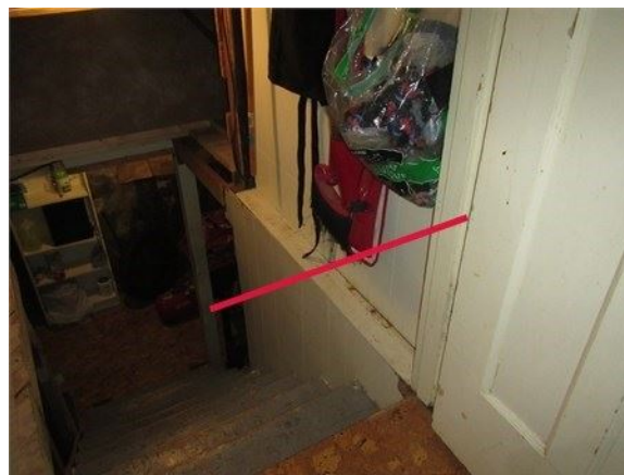
Installer une main courante dans l'escalier intérieur du sous-sol
