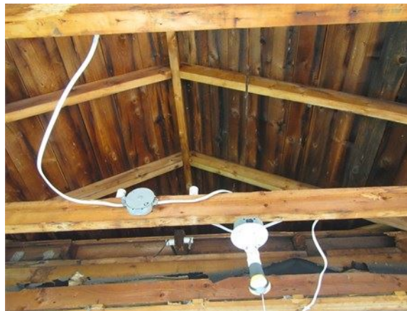
Faible structure du toit
