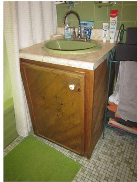
Le meuble lavabo à remplacer dans la salle de bains
