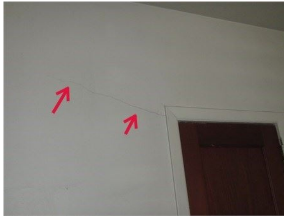
Fissure au coin supérieur gauche de la porte du placard de la chambre avant droite
