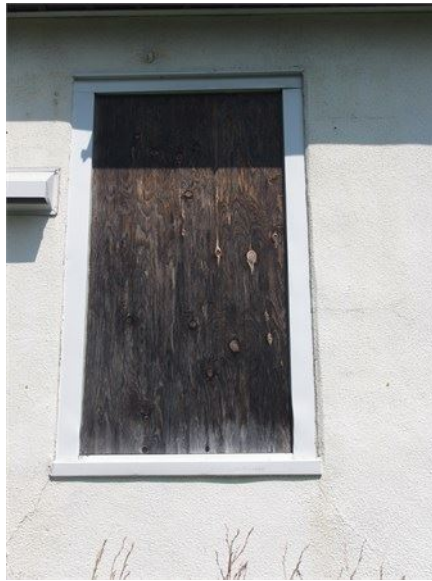
Fenêtre mal condamnée dans la cuisine, mur latéral gauche
