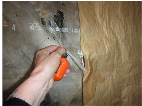
Polyéthylène trop mince sur le mur de fondation arrière à enlever
