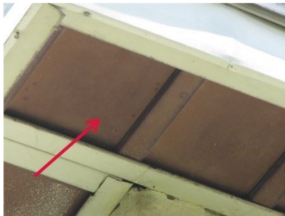
Soffites non ventilés sur un débord de toit
