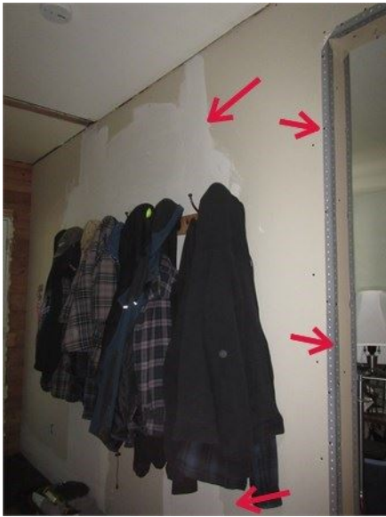
Travaux à compléter dans le portique d'entrée et autour d'une porte
