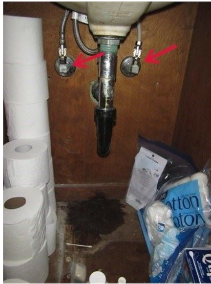
Absence d'anti-béliers sous un appareil de plomberie, ici le lavabo de la salle de bains
