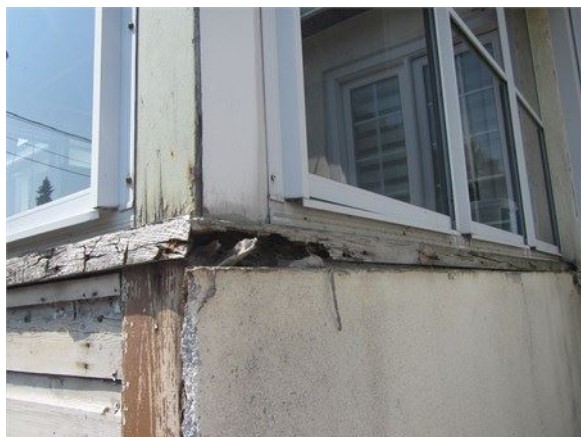
Bois pourri sur le coin avant droit du portique d'entrée
