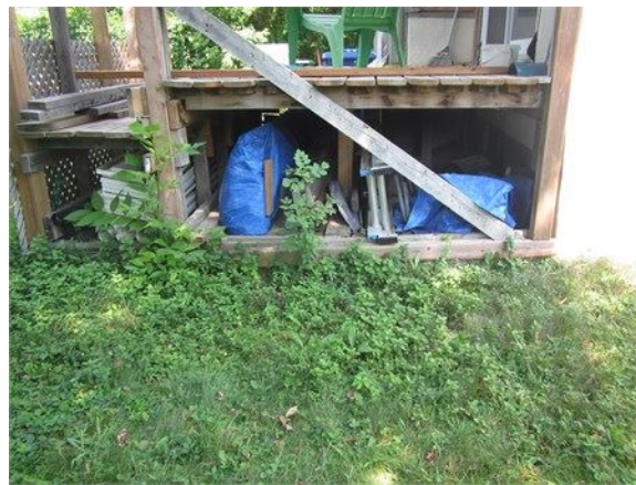
Les poteaux de soutien reposent dans le sol, ce qui peut les faire pourrir plus facilement
