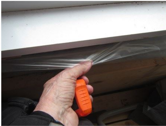
Polyéthylène trop mince sous la fenêtre de la salle à manger
