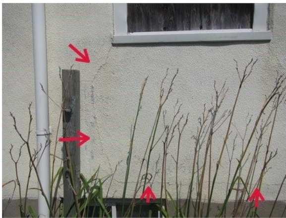
Fissures verticale et horizontale sous une fenêtre
