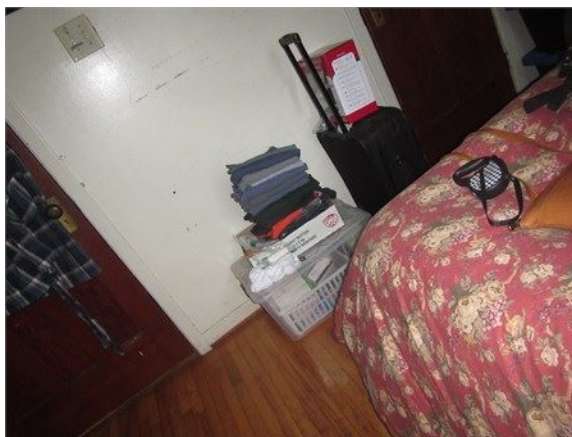
Le plancher de la chambre avant droite penche vers la gauche
