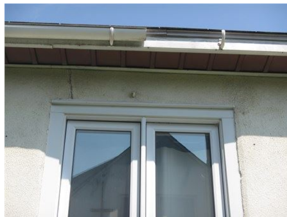
Autre exemple d'absence de solin au-dessus d'une fenêtre et au-dessus de la moulure décorative au-dessus de la fenêtre
