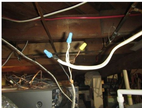
Câbles sans protection adéquate dans le sous-sol en guise d'exemple
