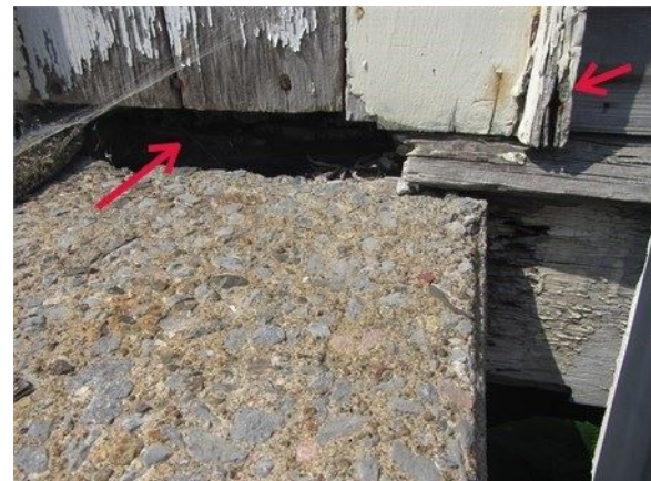
Bois pourri en partie d'un mur
