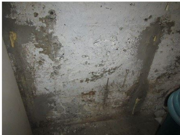
Peinture qui écaille sur un mur de fondation indiquant une humidité excessive
