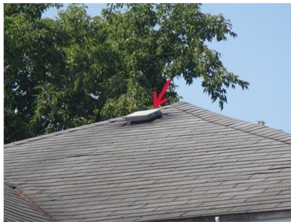
Aérateur plat sur la toiture
