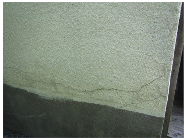
Fissure en partie inférieure du mur latéral droit
