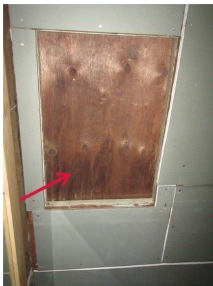
La trappe d'accès à l'entretoit au plafond de la salle de bains, ce qui n'est pas judicieux
