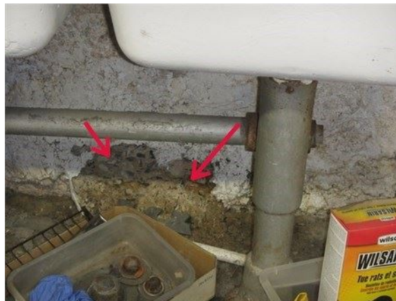
Effritement du mur de fondation latéral droit en raison de l'humidité excessive et de l'âge du béton (faible qualité)
