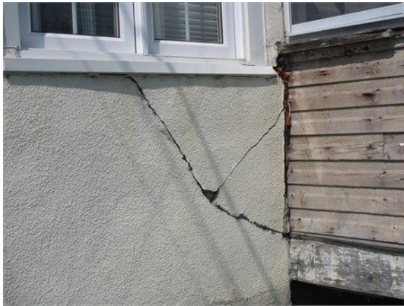
Fissures à gauche du portique d'entrée avant
