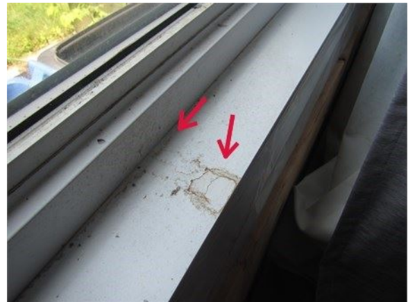
Taches d'eau séchées venant de plus haut
