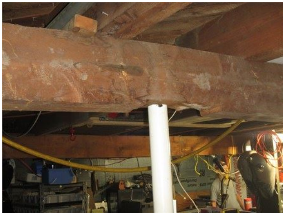
Absence de plaque d'appui sous la poutre et enfoncement du poteau dans la poutre, ce qui n'est pas souhaitable
