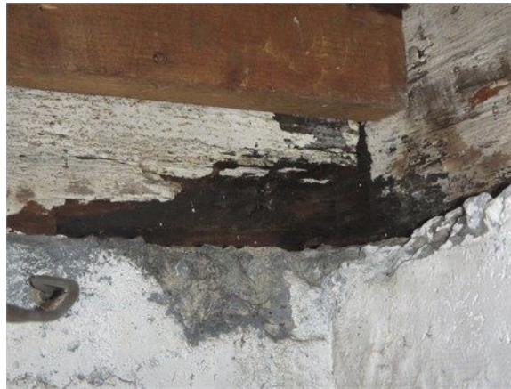
Pourriture de la solive de rive sur le coin avant droit, en rapproché
