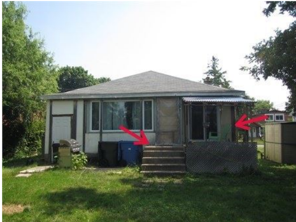
Absence de garde-corps et de main courante dans l'escalier arrière et garde-corps dangereux autour du balcon arrière
