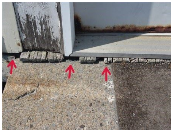
Absence d'étanchéité au bas du mur avant du portique d'entrée et bois pourri
