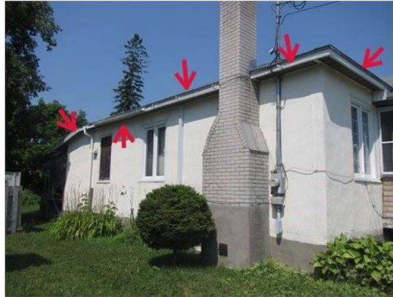
Exemple de gouttières manquantes et gouttière en PVC (flèche du bas)
