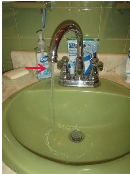
Faible pression d'eau dans le lavabo de la salle de bains
