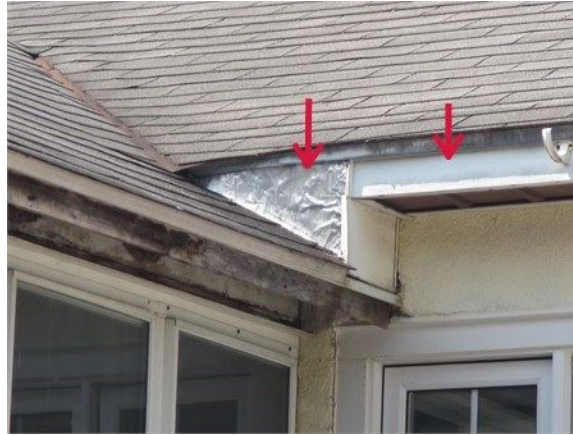
Fascia improvisé à l'avant, à droite du portique d'entrée
