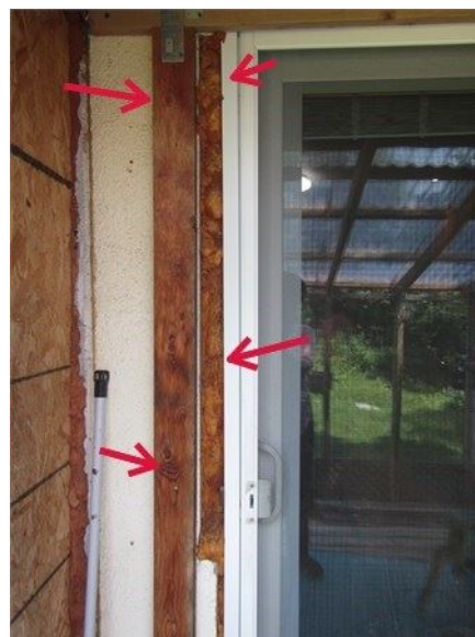
Finition incomplète le long de la porte-fenêtre arrière en guise d'exemple
