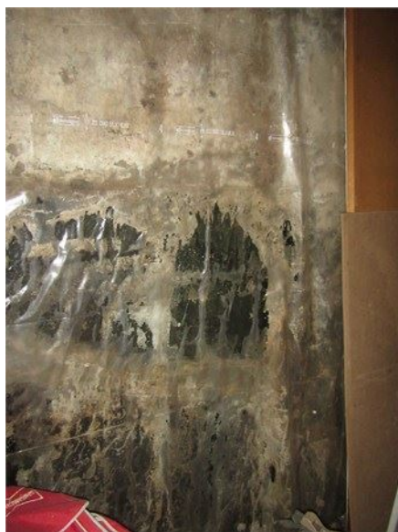
Polyéthylène mince sur le mur de fondation arrière / Les taches noires sont causées par une émulsion bitumineuse pour imperméabiliser le mur de fondation de l'intérieur
