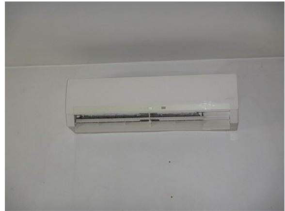
L'appareil au rez-de-chaussée
