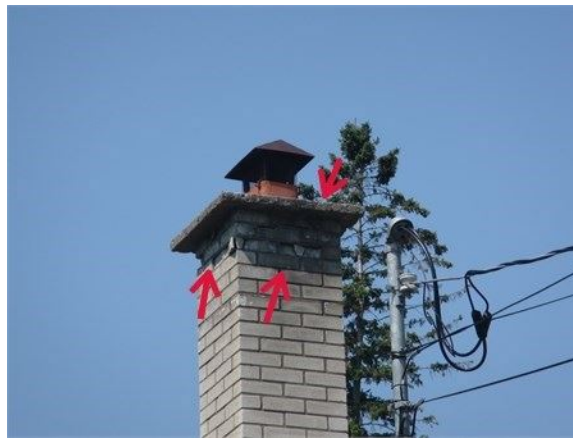
Le couronnement fissuré et en perte d'étanchéité et la maçonnerie endommagée sous le couronnement
