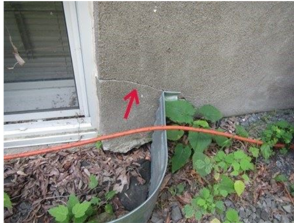
Fissure qui pourrait être liée à la fixation de la margelle
