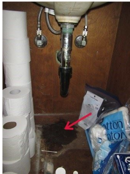
Dessous du meuble-lavabo souillé
