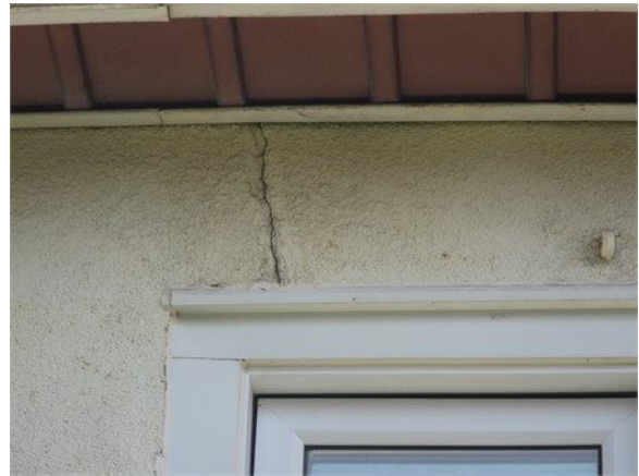
Fissure au-dessus d'une fenêtre sur le mur latéral gauche
