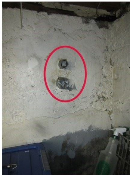
Ancienne entrée de mazout abandonnée sur le mur latéral gauche du sous-sol
