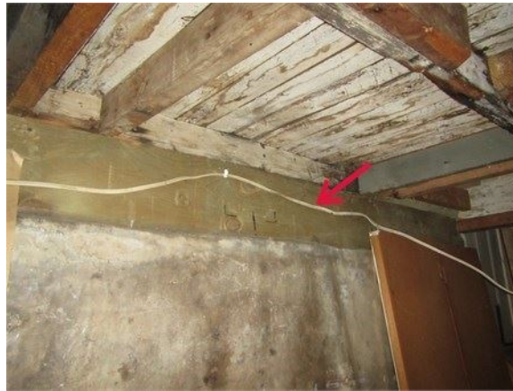
Solive de bois traité le long du mur arrière à remplacer
