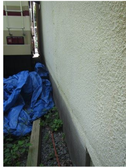
Absence de ventilation au bas d'un des murs ce qui cause des infiltrations d'eau dans la structure du mur, au-dessus du mur de fondation
