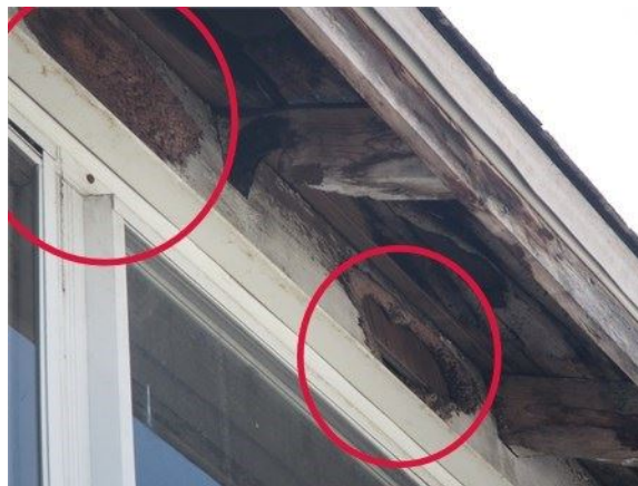
Trous dans le fascia au-dessus du mur latéral droit du portique d'entrée avant
