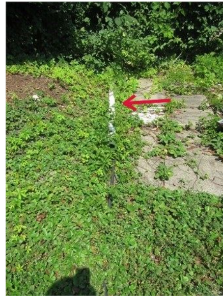
Une conduite au niveau du sol semble évacuer les eaux du puits perdu vers l'arrière droit
