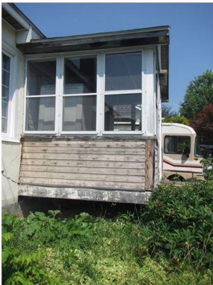
Revêtement à refaire sur le portique d'entrée avant
