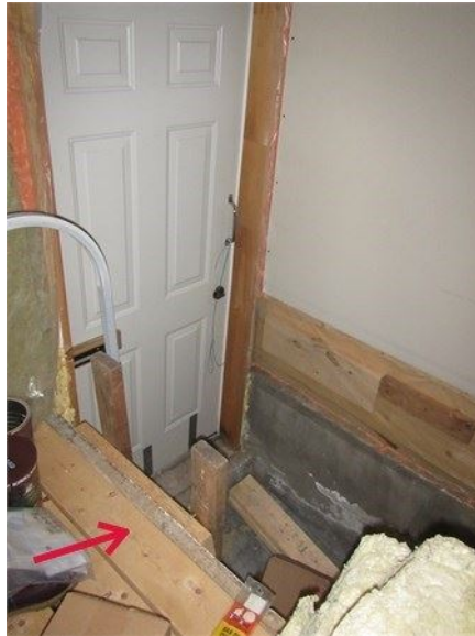
Absence de protection entre le plancher du rez-de-chaussée et l'escalier extérieur du sous-sol qui se trouve plus bas
