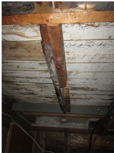
Structure faible d'une partie du plancher (sous la salle à manger)
