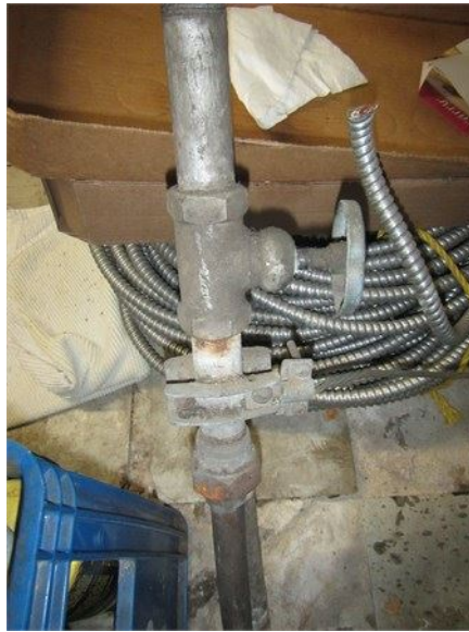
La valve principale d'entrée d'eau dont la conduite de part et d'autre de la valve est en acier
