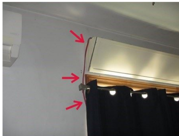
Câble apparent au rez-de-chaussée à protéger
