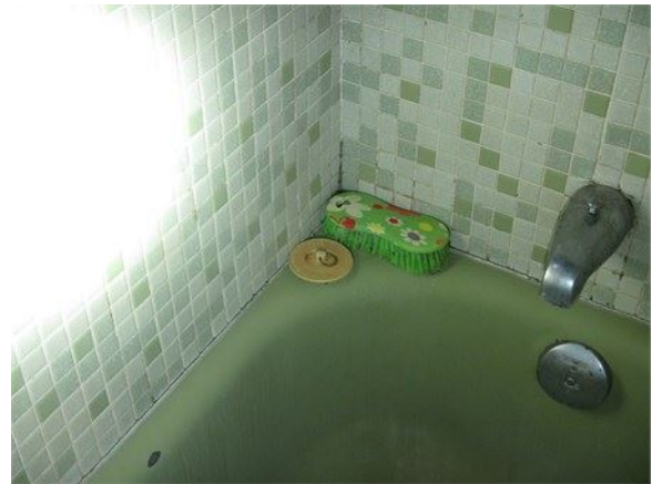
Carreaux de céramique non étanches autour de la baignoire
