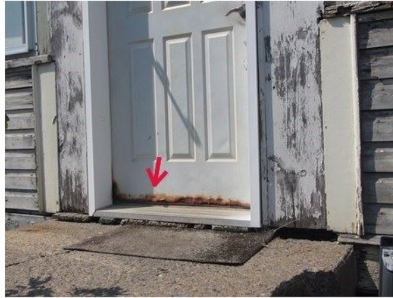
Porte avant rouillée à remplacer
