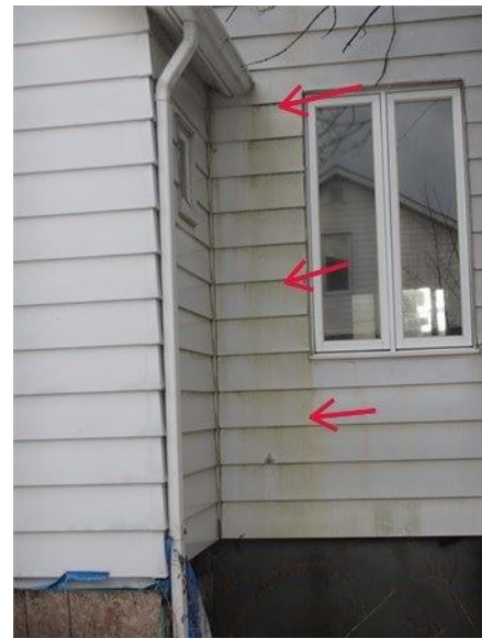
Taches d'écoulement sur le mur arrière en raison d'une gouttière qui n'est pas étanche avec le mur adjacent : Il est probable que des dommages soient présents sur la structure du mur, derrière le revêtement d'aluminium
