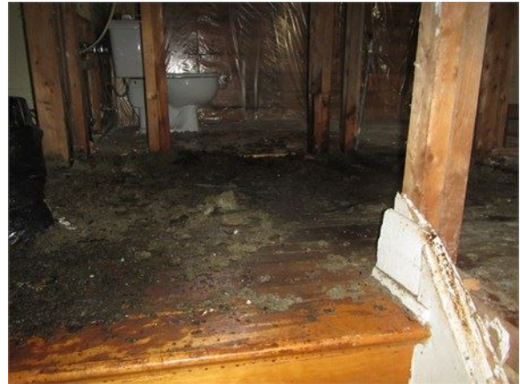
Le plancher de l'étage sous la fuite
