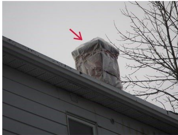
Cheminée condamnée de manière temporaire sur le toit
