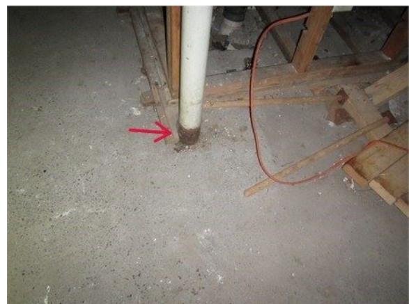
Base d'un poteau à vérifier qui a commencé à rouiller
