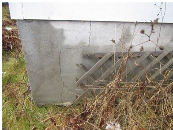
Fissure en escalier sur le mur latéral droit, près de l'avant
