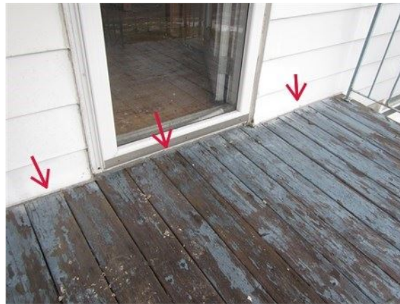
Absence de solin entre le perron avant et le mur extérieur
