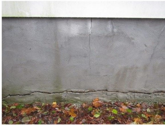
Fissures multiples dont une fissure horizontale près du sol qui indique un mouvement latéral du mur
