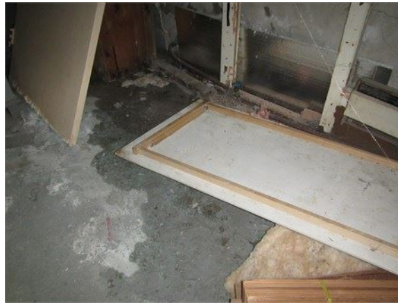
Infiltration d'eau sur la dalle du sous-sol
