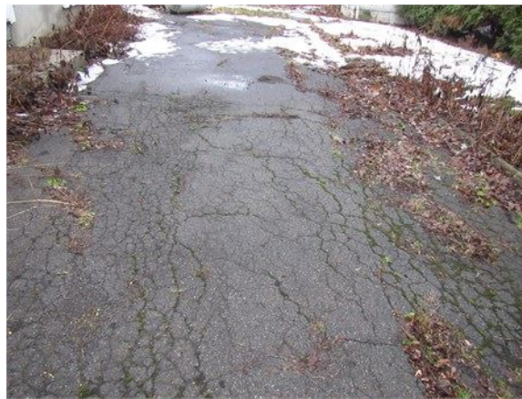
Entrée d'asphalte fissurée et affaissée à refaire
