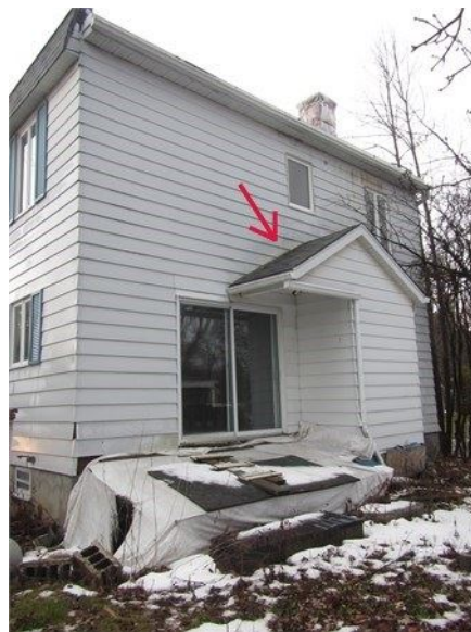
Exemple de bardage trop près d'une toiture
