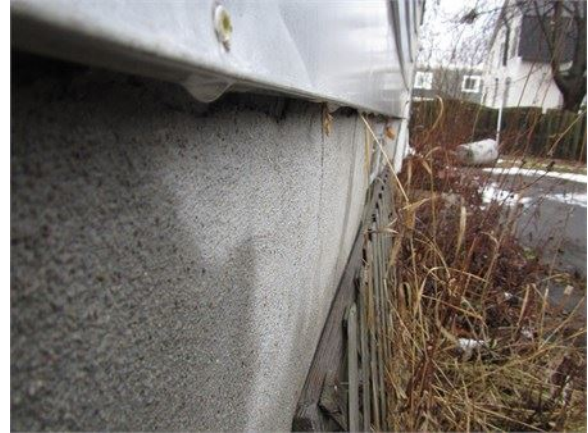
Le bardage n'est pas ventilé en partie inférieure en raison d'une fourrure de bois posée à l'horizontale
