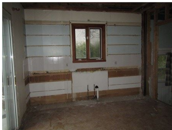
La cuisine a été démolie
