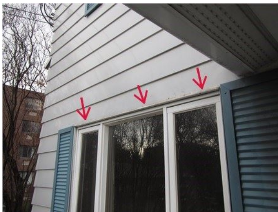
Exemple de fenêtre sans solin pour assurer l'étanchéité. Au contraire, un joint de scellement a été posé. Ce joint de scellement emprisonne l'eau qui pourrait s'infiltrer
