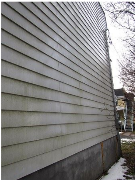
Bardage du mur latéral gauche non ventilé et irrégulier
