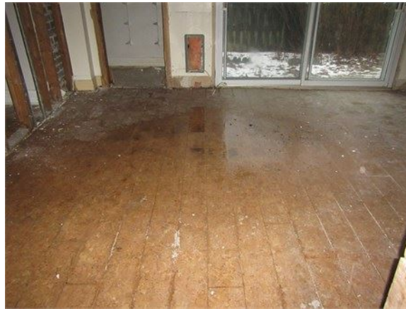
Le plancher de la cuisine affecté par les infiltrations d'eau venant du toit
