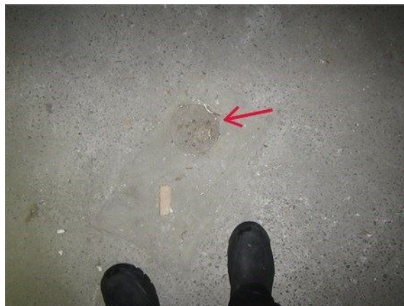
Vieux drain de plancher à remplacer
