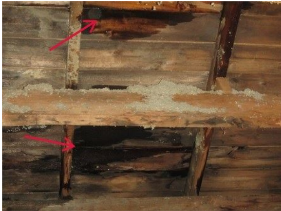
Fuite d'eau du toit
