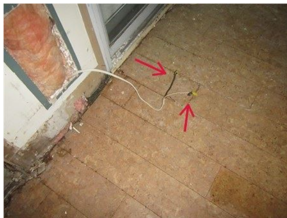
Câbles sans protection adéquate dans la cuisine
