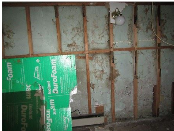
Mur de fondation fissuré et déformé sous l'ossature murale laissée en place : Le mur est dangereux
