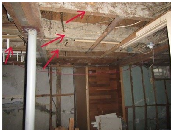
Taches sur des solives qui pourraient comporter des moisissures
