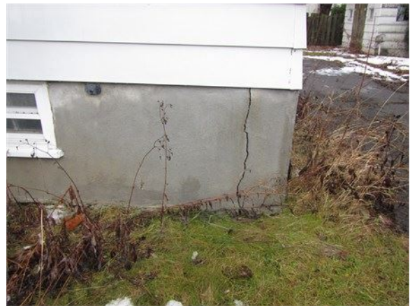
Fissure sur le mur de fondation avant
