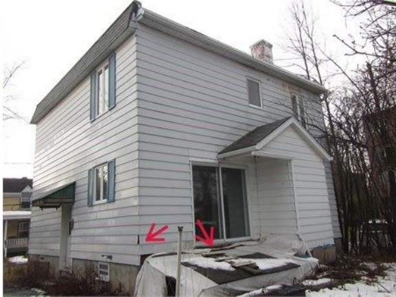
Bardage d'aluminium sur les murs extérieurs avec section manquante en partie inférieure du mur arrière
