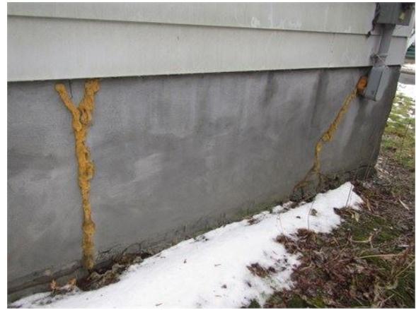
Réparations à l'aide d'uréthane, ce qui est inapproprié
