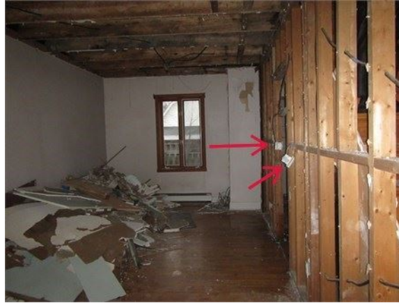
Exemple d'interrupteurs enlevés
