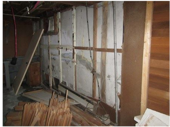
Mur de fondation déformé par des blocs de béton instables et de mauvaise qualité
