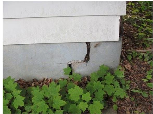
Fissures avec déplacement important, mur arrière, coin gauche à réparer rapidement
