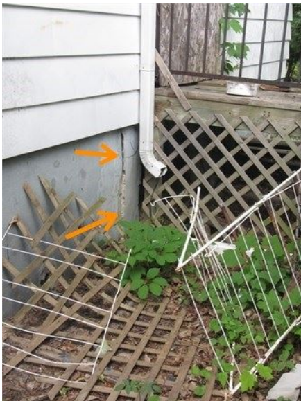
Fissure à la limite de l'extension arrière, mur latéral droit
