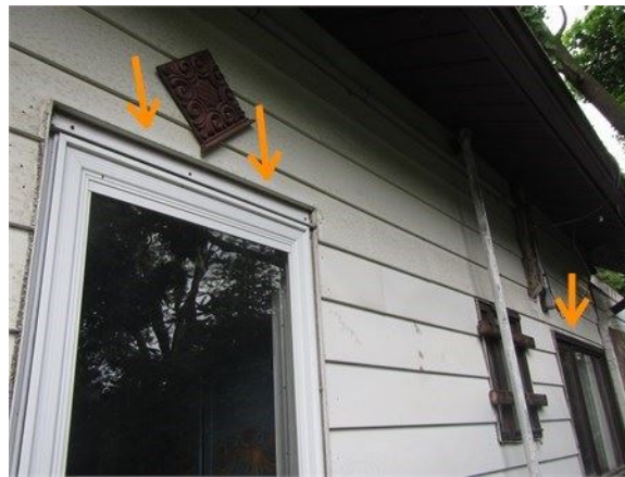
Absence de solins au-dessus des ouvertures
