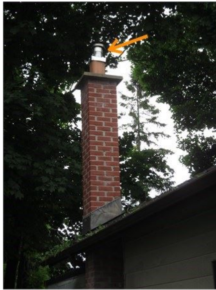
Chemisage visible au sommet du boisseau d'argile
