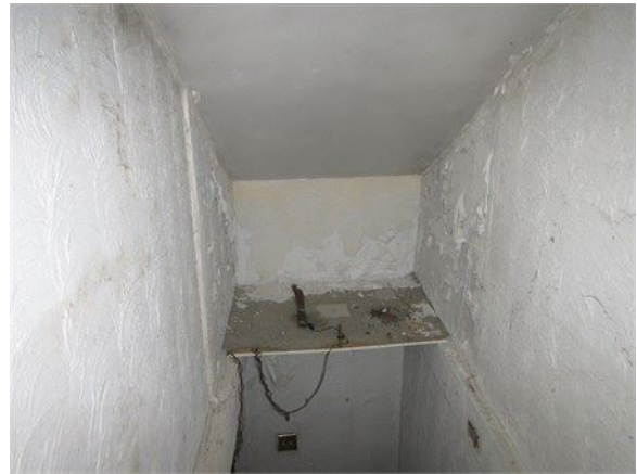
Finis dégradés au haut de l'escalier de l'étage
