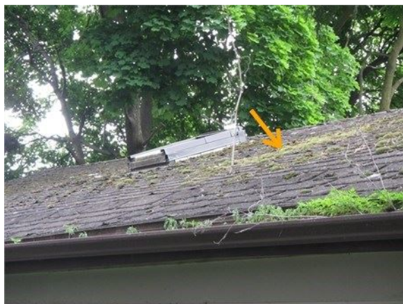
Bardeaux dans un état de détérioration avancé
