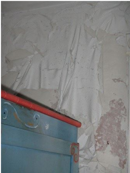
Peinture qui s'écaille en larges plaques au rez-de-chaussée
