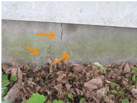
Fissures mineures sur le mur latéral gauche
