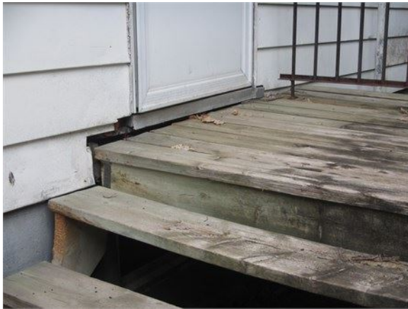
Revêtement non étanche sous la porte d'entrée principale et devant la porte
