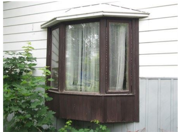
Vieille fenêtre en bois à l'avant à remplacer
