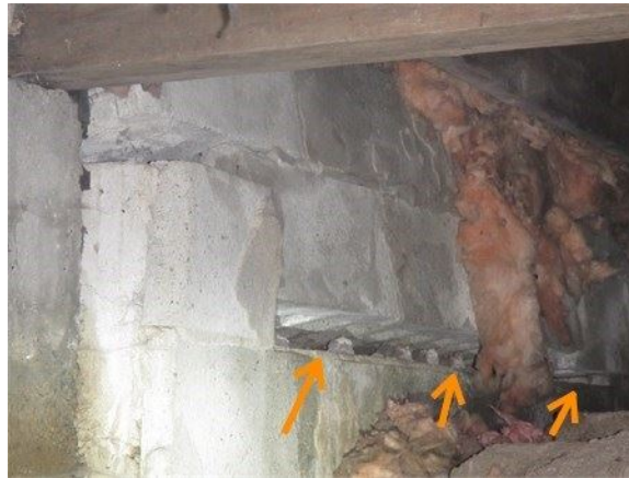
Déplacements importants de blocs de béton sur le mur latéral gauche de l'extension arrière à réparer rapidement
