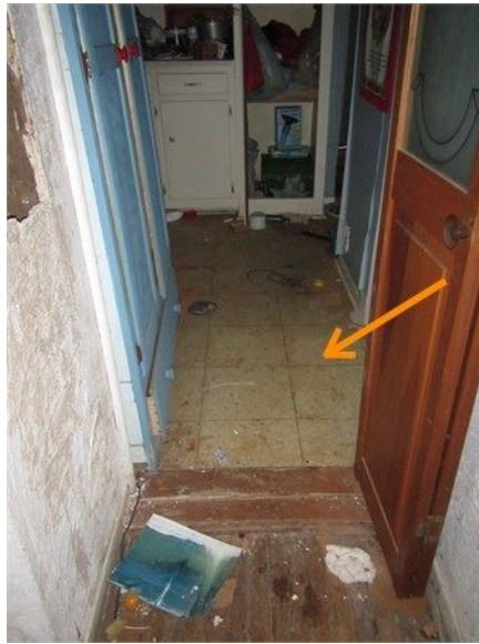
Tuiles pouvant contenir de l'amiante à faire expertiser
