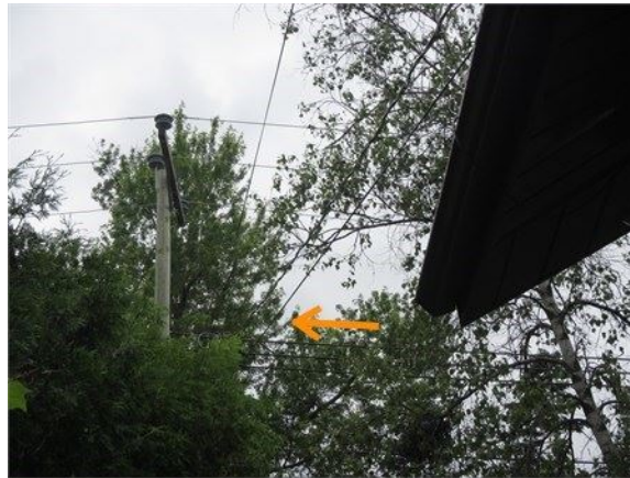
Câbles dans les arbres à l'avant à élaguer
