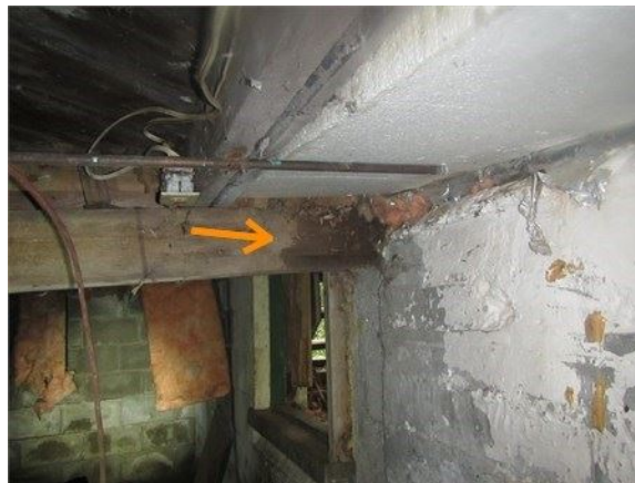
Taches d'infiltration d'eau sur l'extrémité d'une poutre
