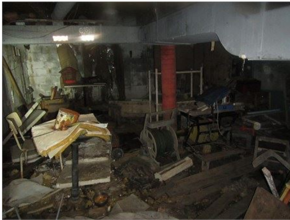
Le vide sanitaire à nettoyer et à décontaminer
