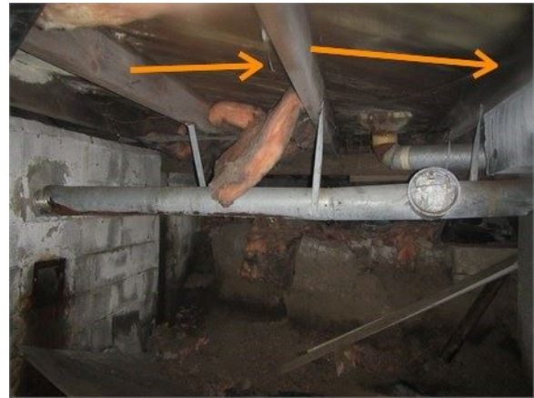
Structure de plancher faible
