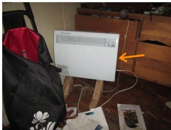
Installation bricolée d'un convecteur dans la chambre arrière
