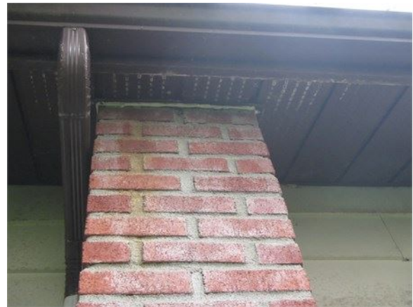
Traces d'infiltration d'eau dans les soffites et sur la cheminée (efflorescence)
