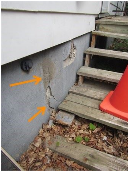
Fissure sur le mur latéral droit devant l'escalier d'entrée principale
