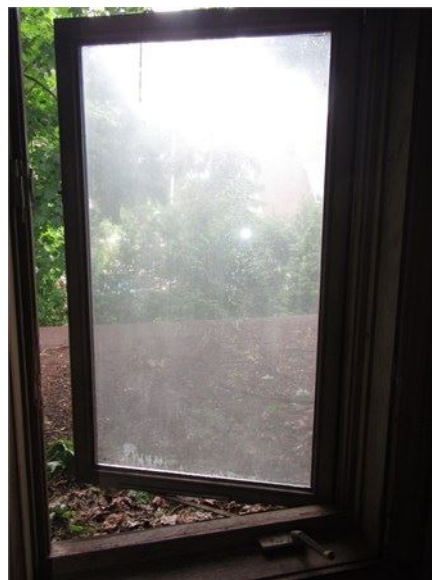
Double vitrage descellé sur une vieille fenêtre en bois à l'arrière et à l'étage
