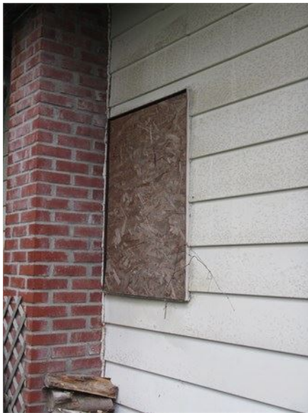
Exemple de fenêtre condamnée
