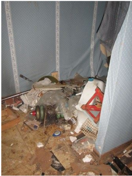
Insalubrité générale au rez-de-chaussée
