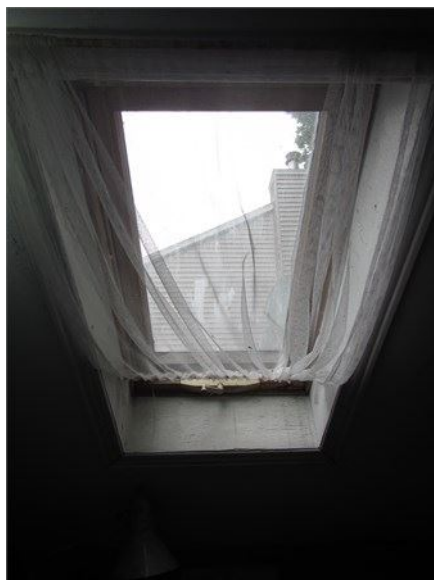
Traces d'écoulement autour du puits de lumière à l'étage
