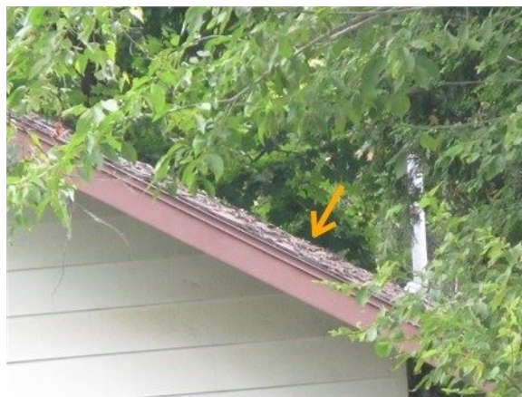
Bardeaux dans un état de détérioration avancé sur la pente droite
