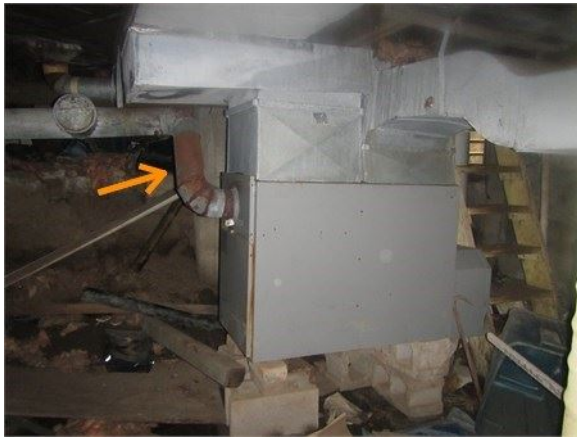
Le conduit d'évacuation des gaz rouillé à la sortie de la fournaise
