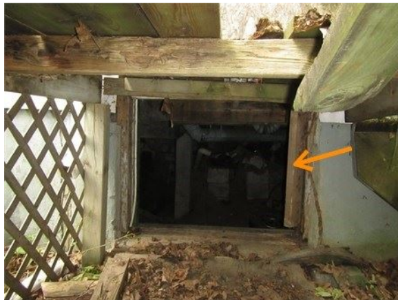
Large ouverture à refermer sur le mur latéral droit
