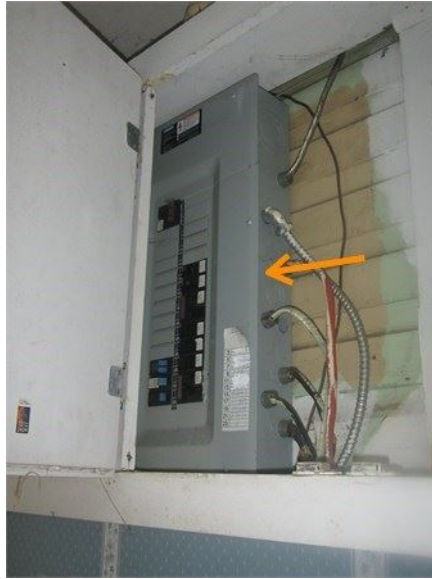
Le panneau de distribution électrique
