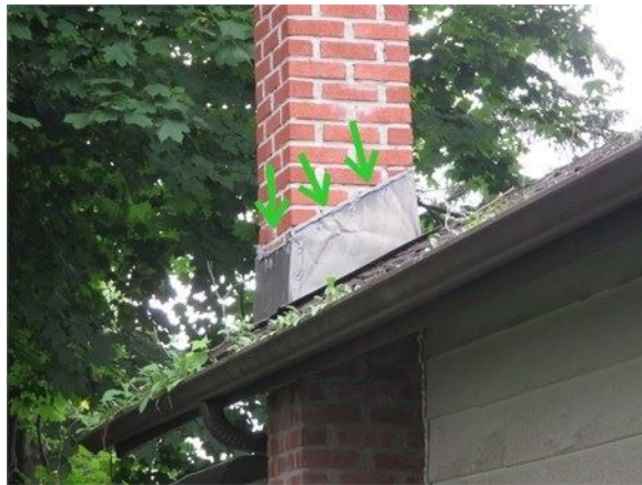
Le contre-solin n'est que calfeutré en surface de la maçonnerie de la cheminée
