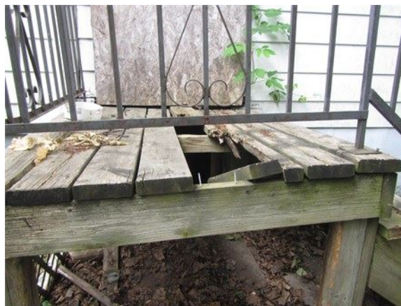
Perron le plus arrière dangereux
