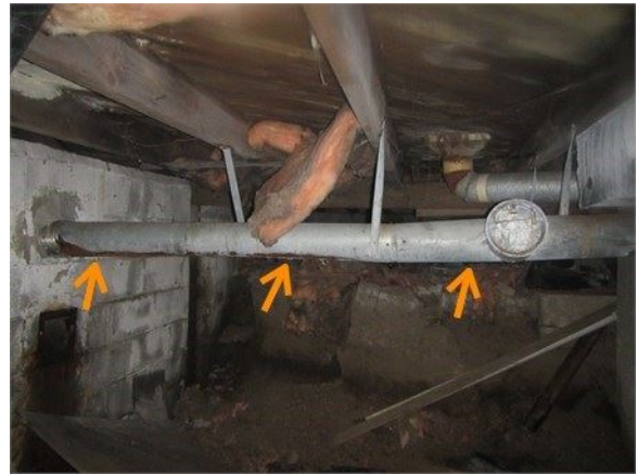
Le dessous du conduit de fumée est rouillé et la pente est négative vers la cheminée
