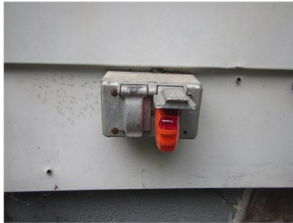
Prise extérieure standard à remplacer
