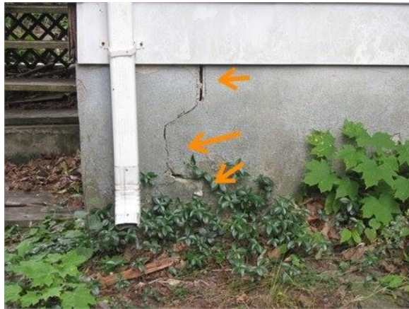
Fissure importante sur le mur arrière, coin droit
