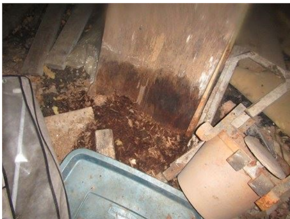
Bois qui pourri en contact avec l'humidité du sol
