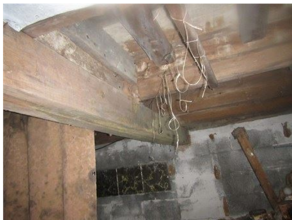
Taches sur la structure qui pourrait comporter des moisissures dans le vide sanitaire
