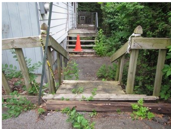
Escalier à l'entrée dangereux et garde-corps inadéquat
