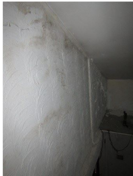
Moisissures probables au haut des murs de l'escalier de l'étage
