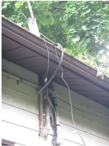
Vieux mâts à enlever sur le mur latéral droit
