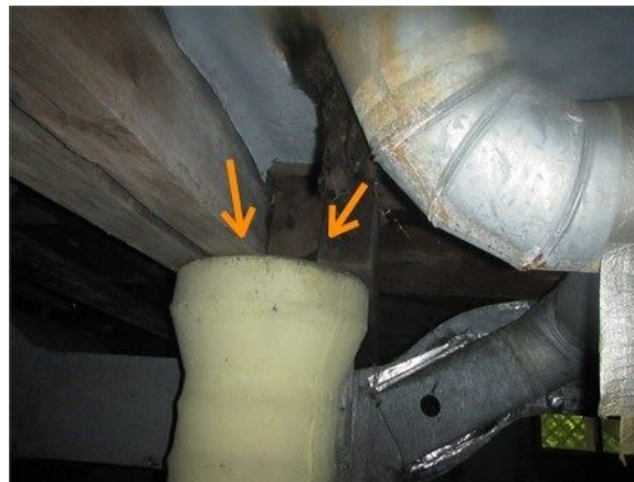
Poutres non fixées à une colonne de béton
