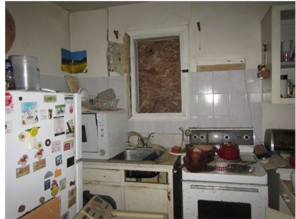
Réfection de la cuisine à prévoir
