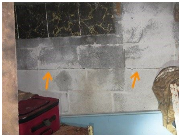
Fissure horizontale sur le mur latéral gauche à vérifier et à corriger (il pourrait s'agir d'un déplacement du mur vers l'intérieur)
