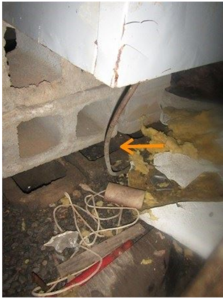
Conduite de mazout sous l'appareil
