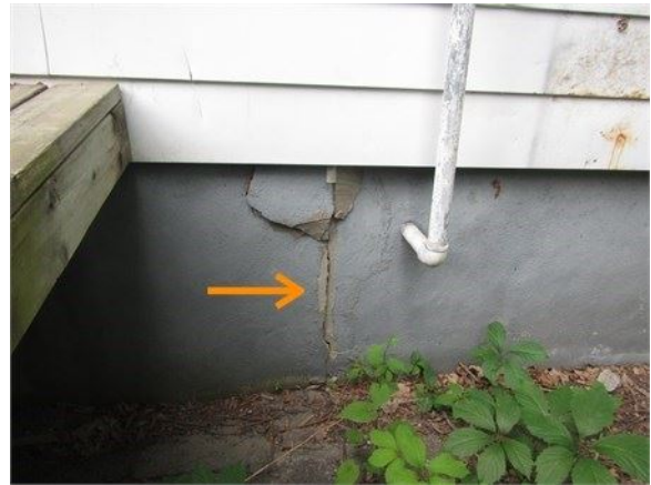
Fissure verticale entre les deux perrons
