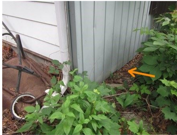
Revêtement trop près du sol à l'avant gauche
