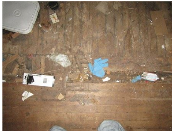
Exemple de fini de plancher en mauvais état
