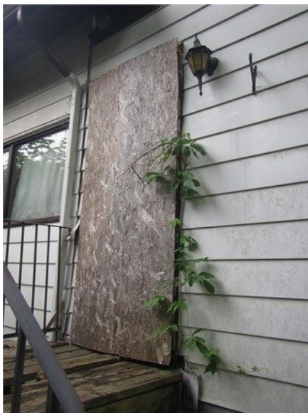
La porte condamnée de l'extérieur
