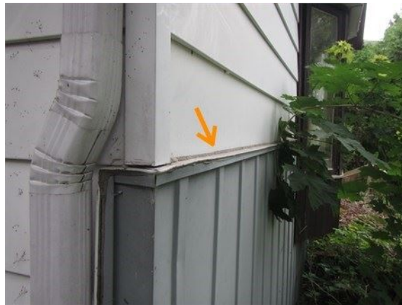
Absence de ventilation derrière le revêtement, visible au bas des diverses sections de bardage
