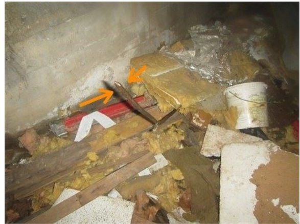
Conduite abandonnée (sectionnée) près du mur latéral droit du vide sanitaire
