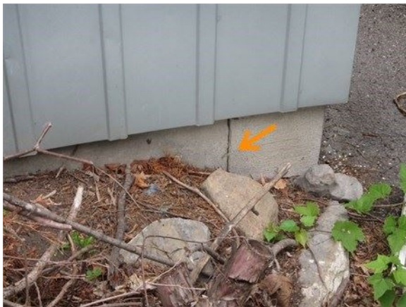
Fissure sur le mur avant, côté droit
