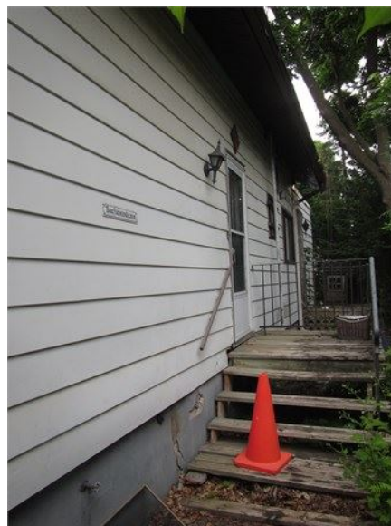
Escalier et perron principal à reconstruire
