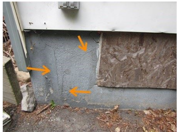
Fissures sur le mur latéral droit près de l'avant
