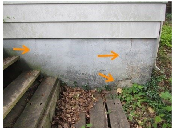
Fissures sur le mur latéral droit, coin arrière droit
