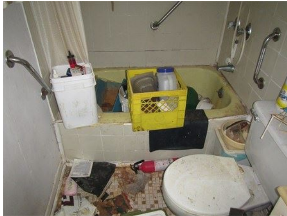
Réfection de la salle de bains à prévoir
