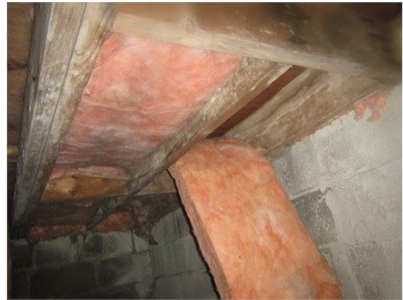
Taches sur la structure qui pourrait comporter des moisissures dans le vide sanitaire
