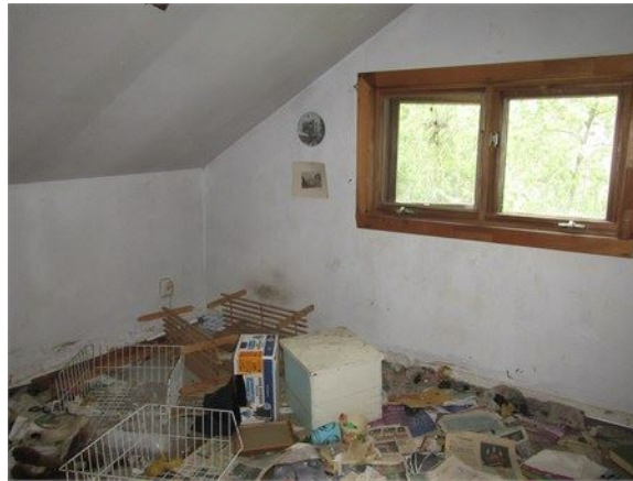
Moisissures probables sur les murs de l'étage
