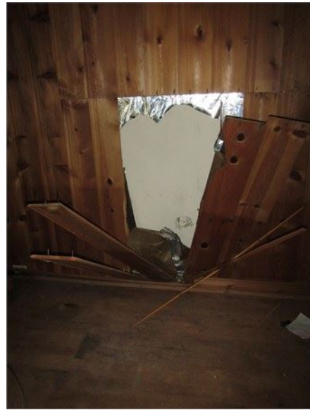
Lattes de bois arrachées sur un mur du séjour
