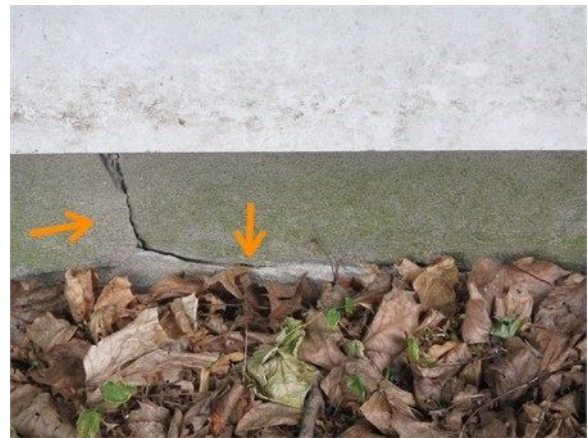
Fissures avec déplacement sur le mur latéral gauche
