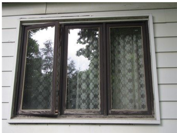
Exemple de vieille fenêtre en bois à remplacer à l'arrière
