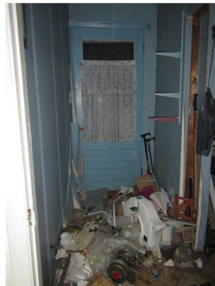
La porte condamnée vue de l'intérieur
