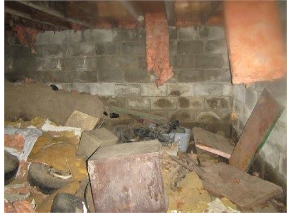
Efflorescence et humidité importante sur les murs de fondation en blocs de béton
