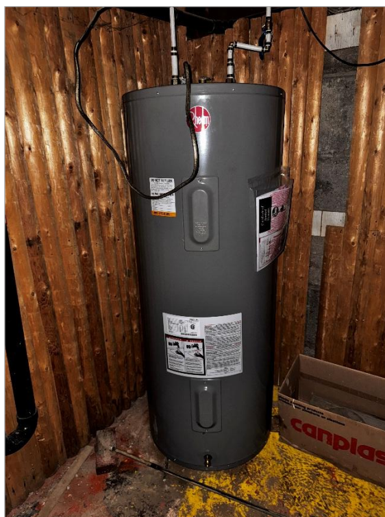
Réservoir à eau chaude
