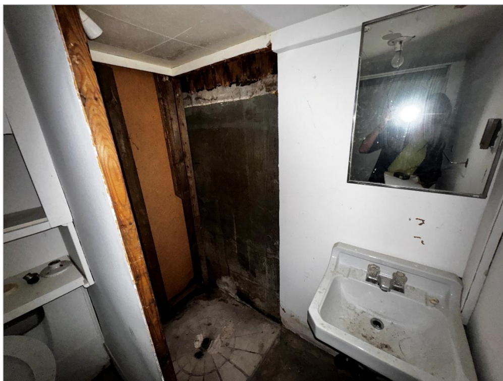
Salle de bain non fonctionnelle au sous-sol
