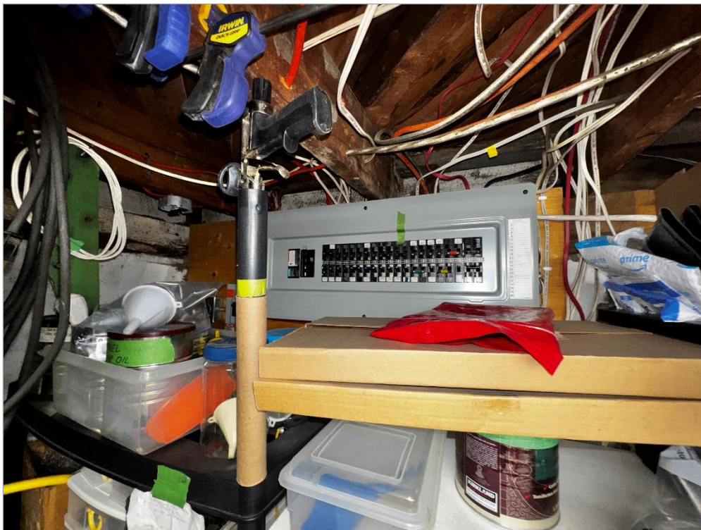
Panneau électrique (sous-sol)
