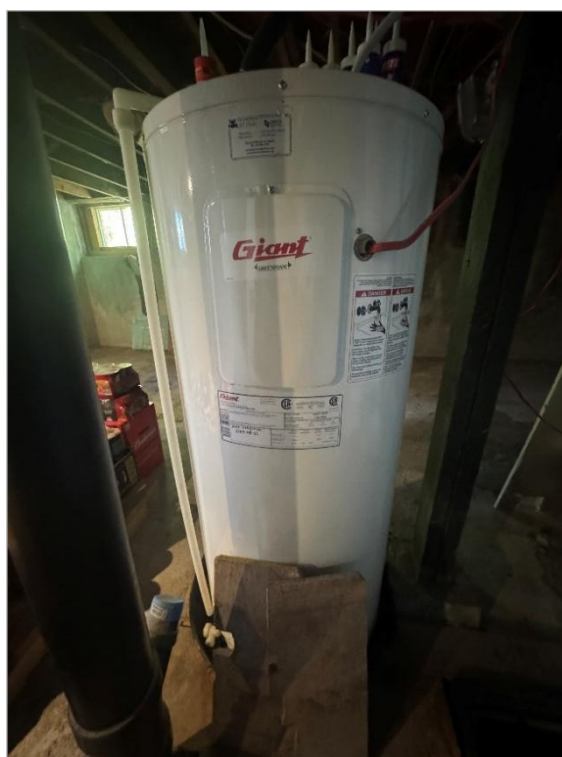
Réservoir à eau chaude
