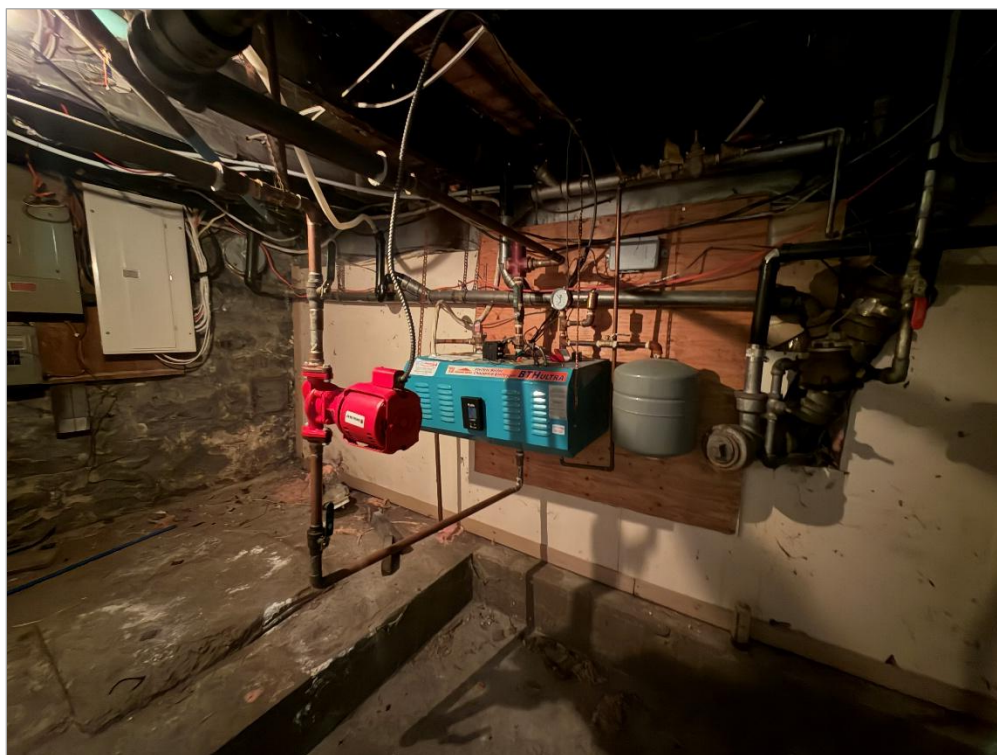
Système de chauffage à eau chaude
