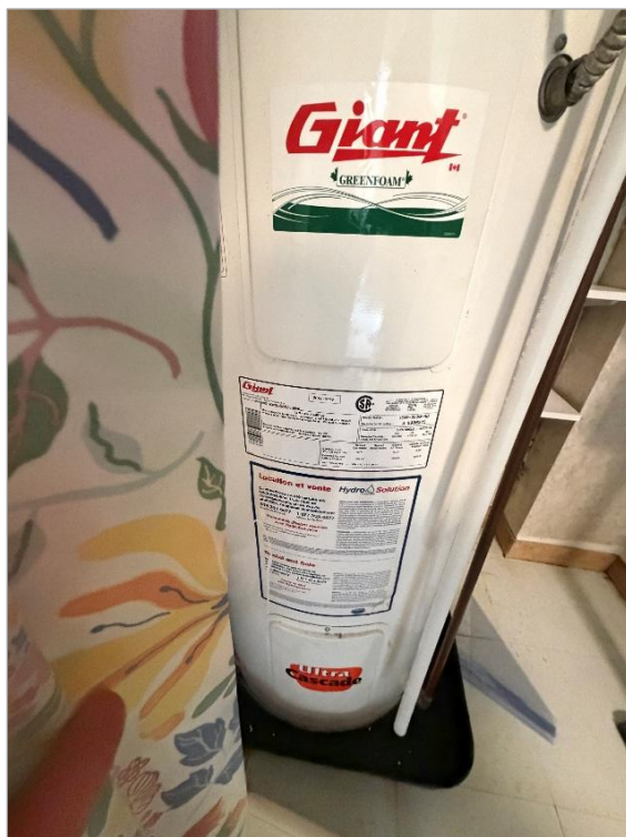
Réservoir à eau chaude
