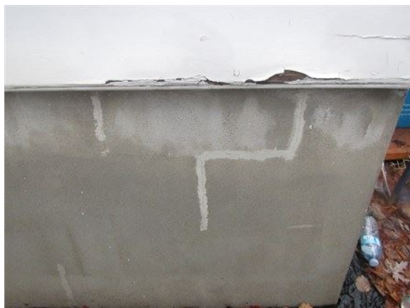
Fissures réparées et réouvertes
