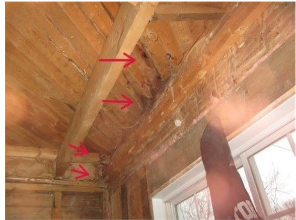
Traces d'infiltration d'eau sous le plancher de l'étage près d'un mur extérieur qui n'est pas étanche
