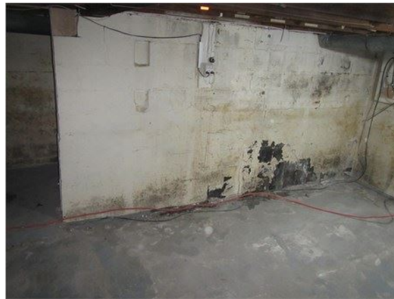
Infiltration d'eau et peinture qui écaille sur un mur de fondation / Noter les taches foncées sur les murs qui pourraient être des moisissures
