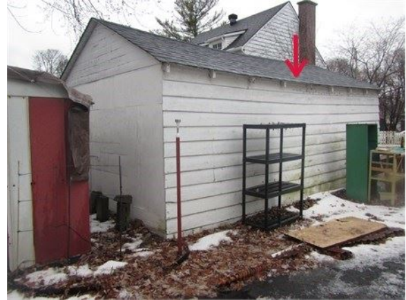
Le mur latéral gauche est affaissé en son centre
