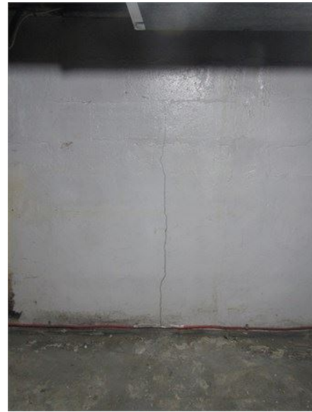
Vissure verticale à réparer au sous-sol
