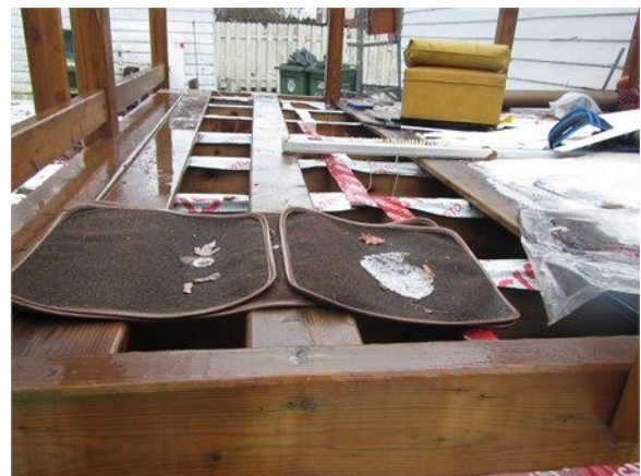
Des lattes du platelage de la terrasse sont manquantes
