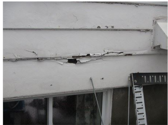
Revêtement qui pourri par endroits
