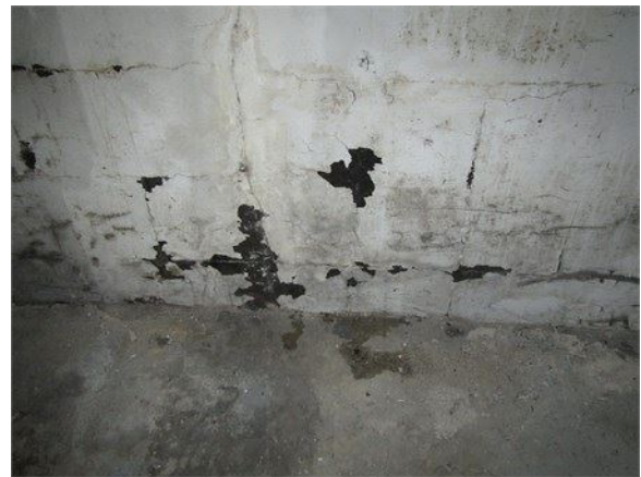
Infiltrations d'eau et peinture qui écaille sur un mur de fondation
