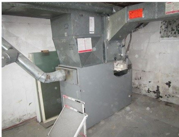
La fournaise à air pulsé dans le sous-sol
