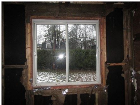
Vieille fenêtre coulissante à remplacer
