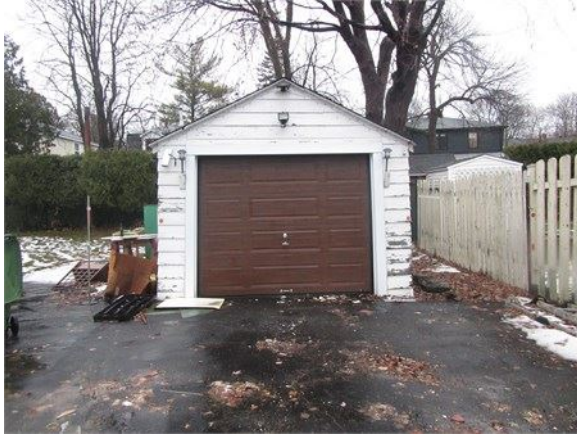
La porte n'est pas d'équerre dans le cadre du garage
