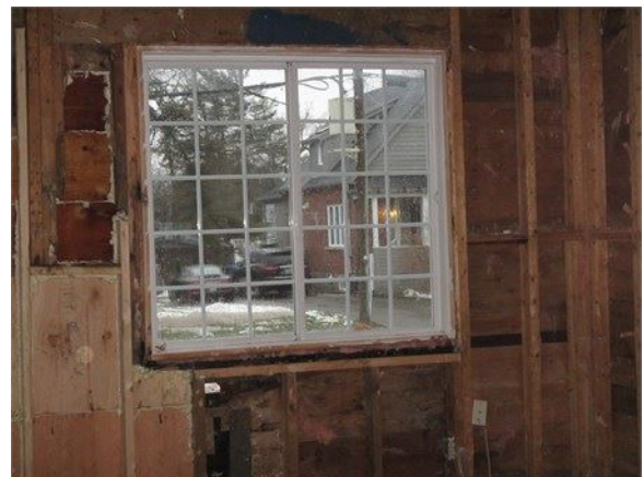
Autre vieille fenêtre coulissante à remplacer
