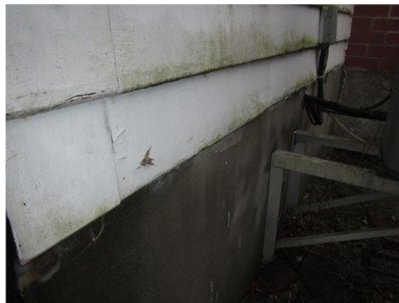
Revêtement collé sur le mur de fondation latéral gauche, ce qui n'est pas souhaitable
