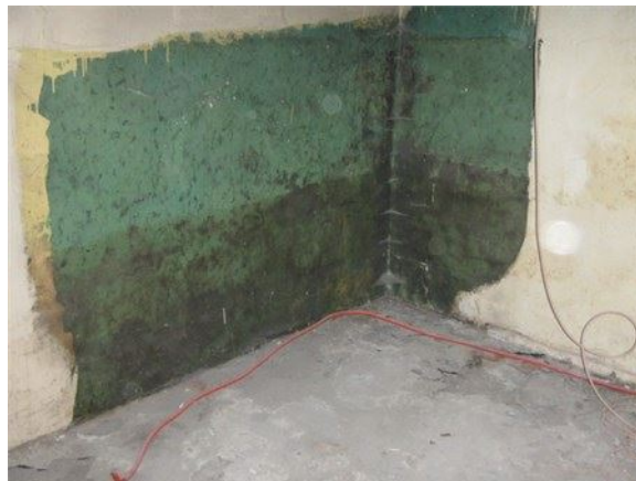
Taches qui pourraient comporter des moisissures dans le sous-sol
