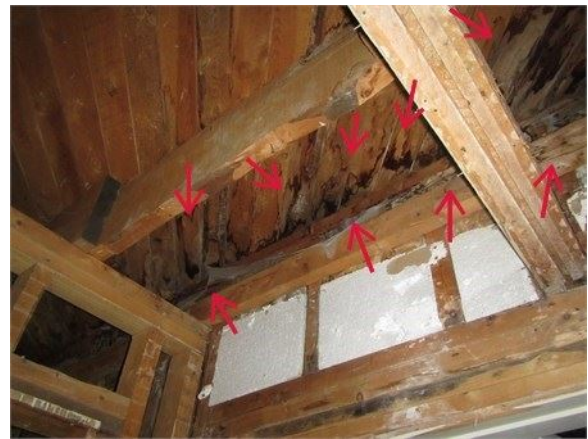
Traces d'infiltration d'eau le long d'un mur extérieur
