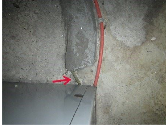
Conduite ancienne sous une bande de béton à faire expertiser au besoin
