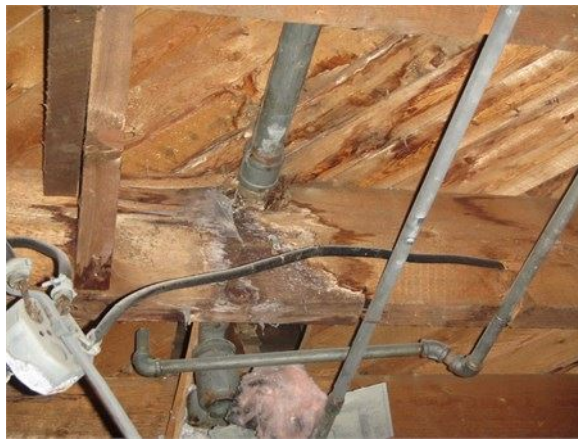
Traces d'infiltrations d'eau sur une solive et sous le sous-plancher de l'étage
