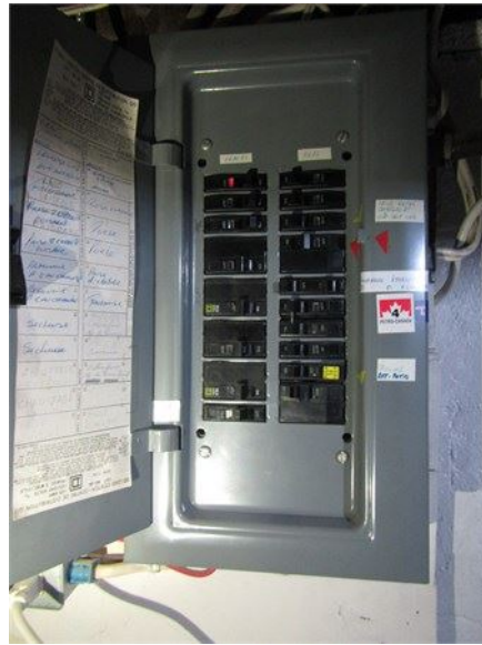
Le panneau de distribution électrique principal
