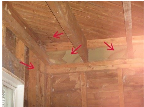
Traces d'eau le long de murs extérieurs
