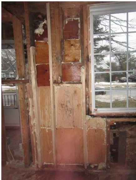
Infiltration d'eau importante sur le mur avant à gauche de l'entrée
