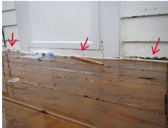
Absence de solin entre le mur avant et le perron à corriger
