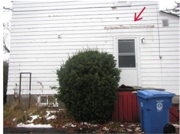
Revêtement endommagé et peinture qui écaille sur le mur latéral droit
