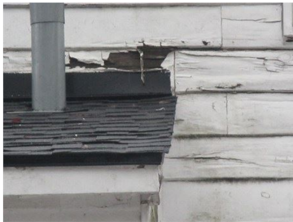
Revêtement endommagé par l'eau autour du coin supérieur gauche de l'extension arrière
