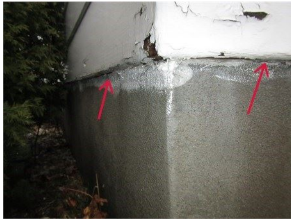
Le revêtement extérieur est collé sur les murs de fondation, ce qui n'est pas souhaitable
