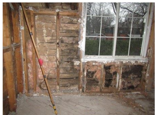
Traces d'infiltration d'eau sous une fenêtre
