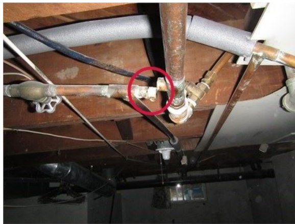
Joint d'une conduite qui a cédé au plafond du sous-sol
