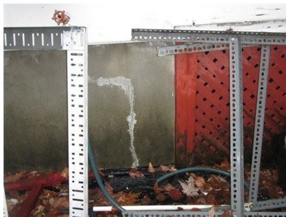
Autre fissure en escalier à réparer
