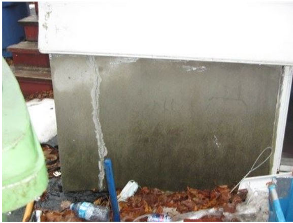
Fissure réparée et ouverte à nouveau à réparer
