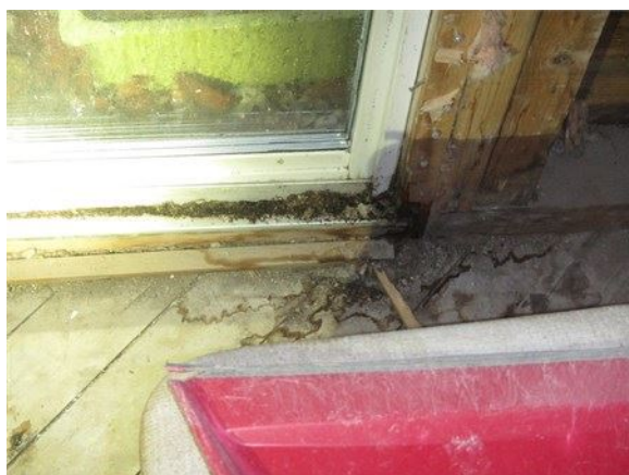
Traces d'infiltration d'eau sur le coin inférieur de la porte-fenêtre
