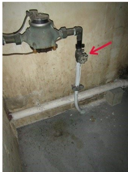
Vieux robinet d'urgence à remplacer
