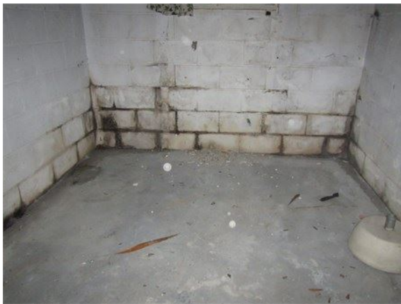
Infiltration d'eau par des blocs de béton au bas de certains murs de fondation
