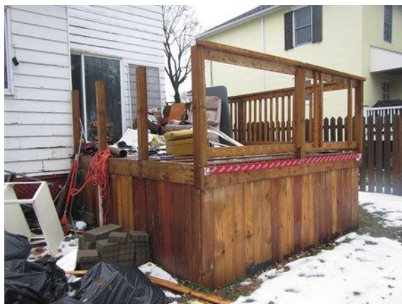
Terrasse en travaux à l'arrière sans garde-corps sécuritaire
