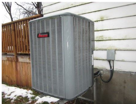
Thermopompe/climatiseur sur le mur gauche du bâtiment
