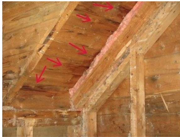
Traces d'eau actives le long d'une rive à maîtriser
