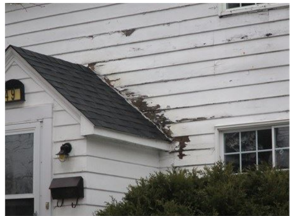
Revêtement de bois endommagé par l'eau près de la marquise d'entrée
