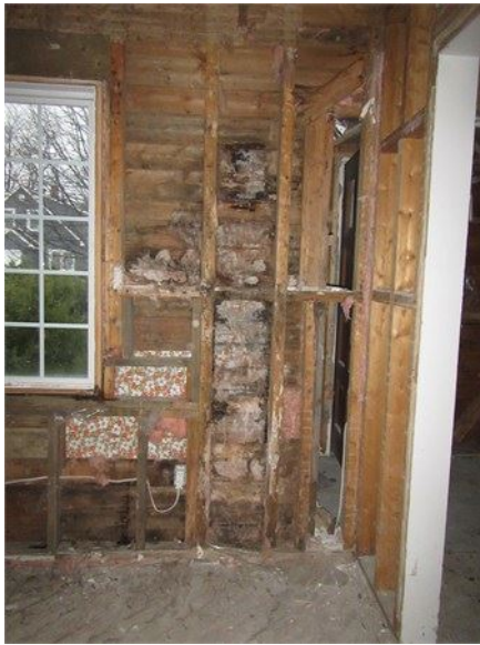
Traces d'infiltration d'eau sur un mur extérieur
