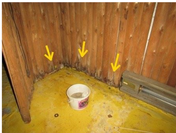
Traces d'infiltration d'eau au bas d'un mur recouvert de bois dans le sous-sol
