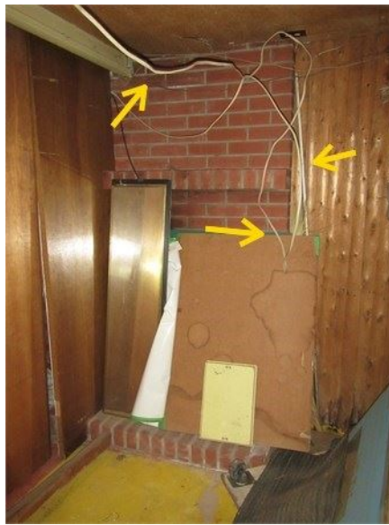
Câblage électrique à fixer au sous-sol
