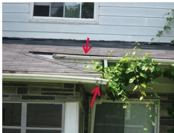
Exemple de gouttières en PVC déformées à l'avant
