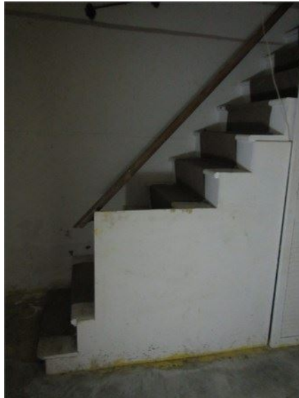
Escalier du sous-sol sans garde-corps du côté ouvert et main courante en place à installer
