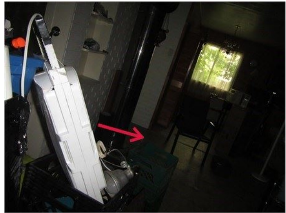
Le plancher de l'espace central du rez-de-chaussée penche vers le centre de la pièce, ici vers l'avant
