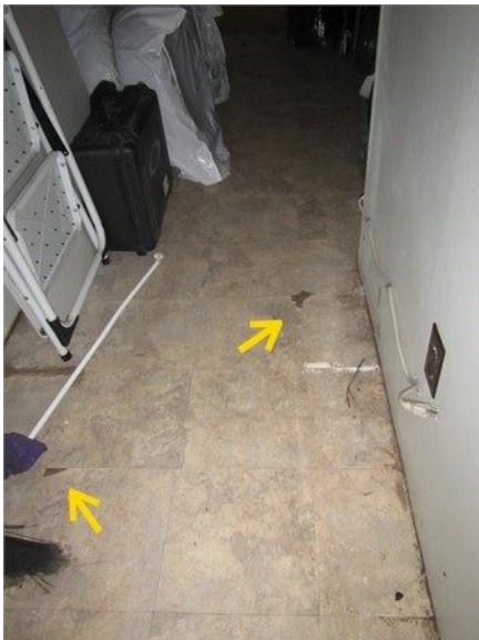
Tuiles endommagées dans le couloir d'entrée du rez-de-chaussée
