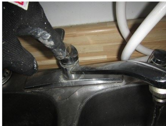
Robinet de l'évier à fixer en place pour maîtriser la fuite
