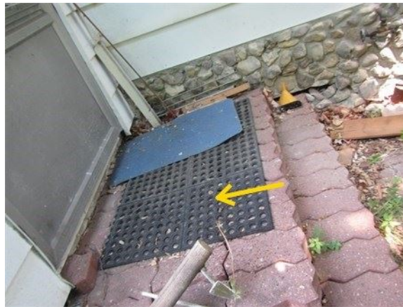
Pente négative du perron arrière en pavé uni (exagéré par la photo)
