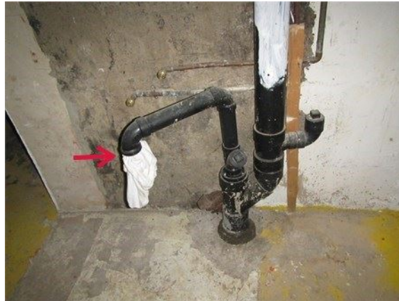
Conduite abandonnée à sceller correctement, au bas de l'escalier
