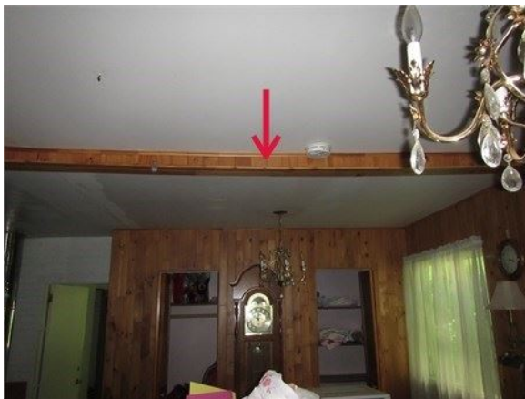
La "poutre" au plafond du rez-de-chaussée, pièce avant et centre droit est affaissée en son centre
