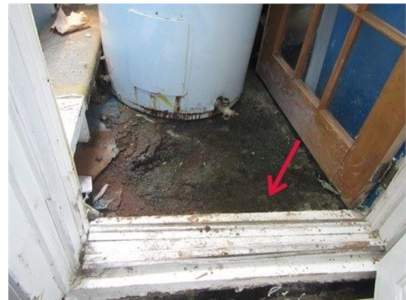
Humidité excessive au bas du palier du sous-sol, côté extérieur de la porte
