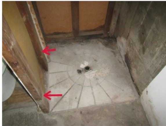
2 x 4 dans le mauvais sens sur un mur de la douche du sous-sol
