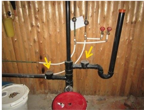
Les deux clapets antiretour observés dans le sous-sol
