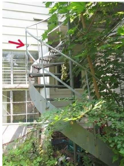
Garde-corps non conforme dans l'escalier arrière
