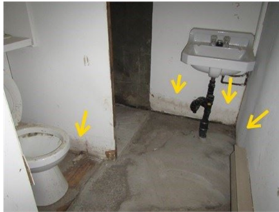
Traces d'infiltration d'eau au bas des murs de la salle de douches au sous-sol
