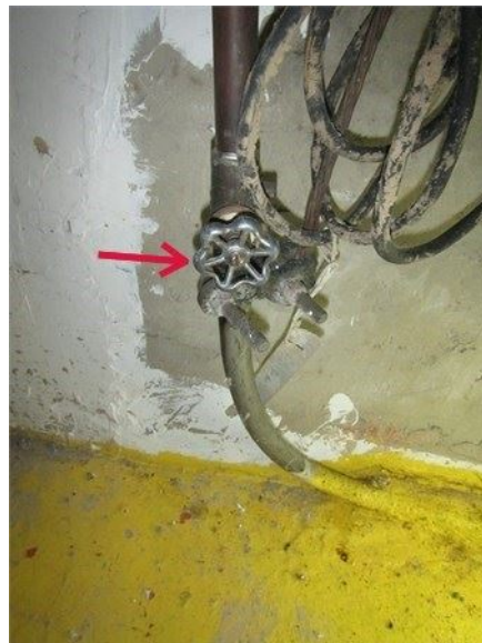
Robinet ancien à remplacer
