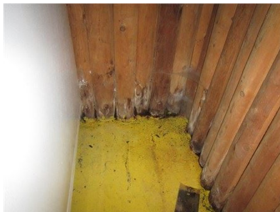
Traces d'infiltration d'eau au bas de murs recouverts de bois dans le sous-sol
