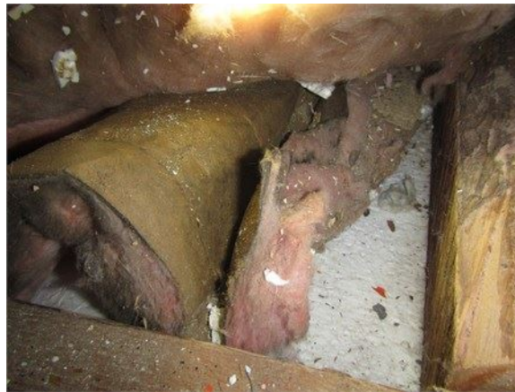
Nattes d'isolant sur du polystyrène expansé (blanc) : Noter les souillures dans l'isolant en nattes
