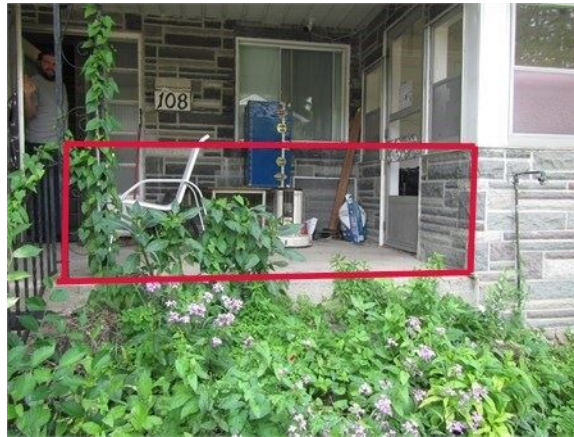
Garde-corps manquant à l'avant
