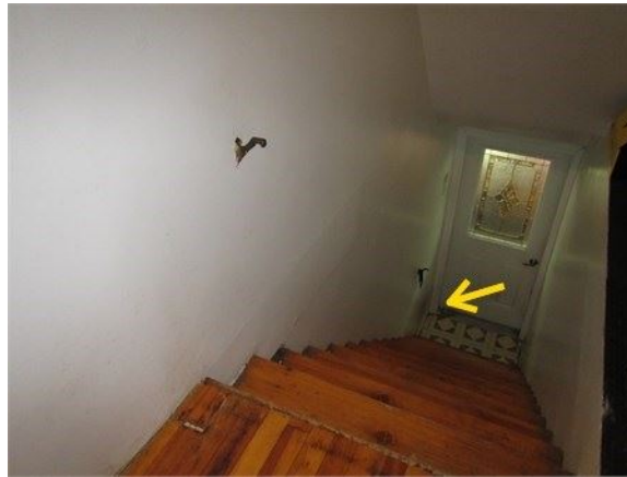
Absence de chauffage dans le portique d'entrée de l'escalier avant droit
