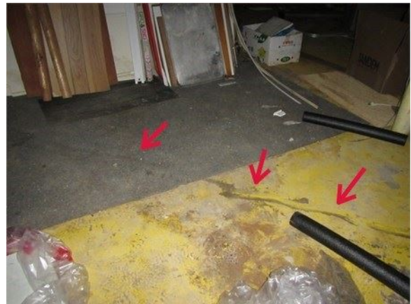
Rigole sur la dalle de béton du sous-sol : Infiltrations d'eau périodiques ? A surveiller
