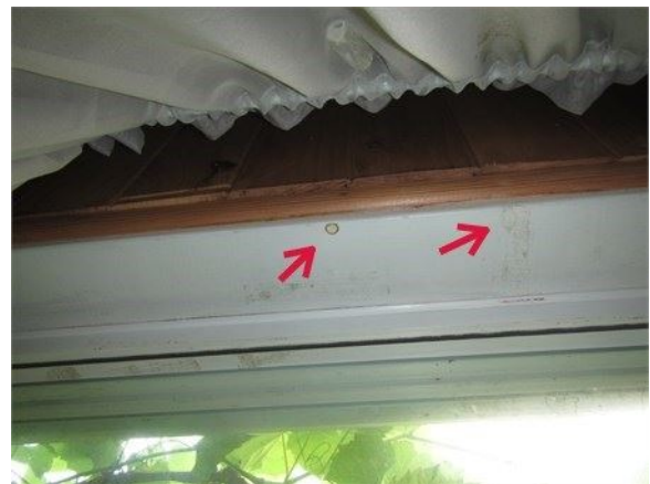
Taches d'infiltration d'eau au-dessus d'une fenêtre en guise d'exemple
