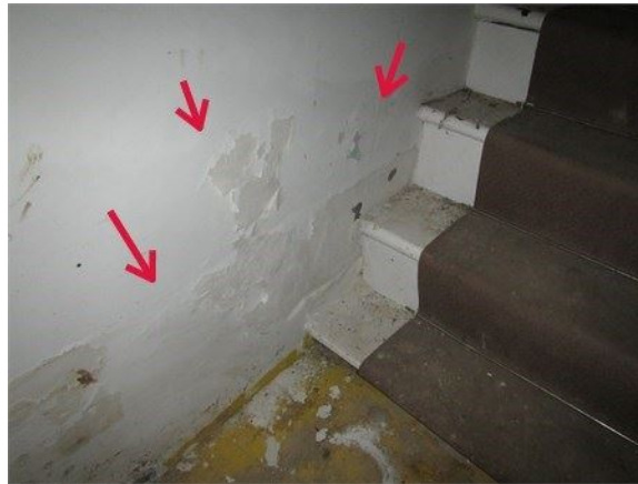
La peinture qui s'écaille sur le mur du garage au bas de l'escalier du sous-sol
