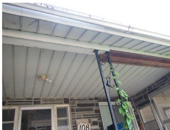
Sous-face du toit du perron avant à ventiler
