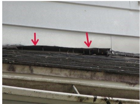
Solin largement soulevé sur le toit du perron avant et de la véranda
