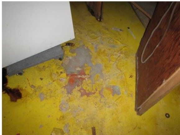
Peinture qui s'écaille en présence d'humidité
