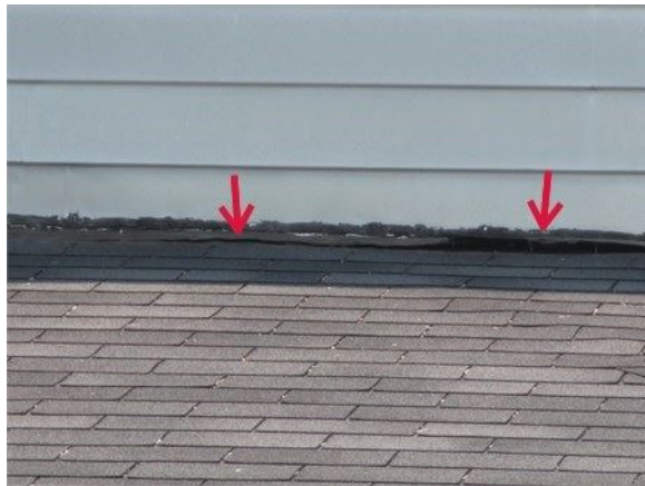
Solin soulevé sur le toit du perron avant et de la véranda
