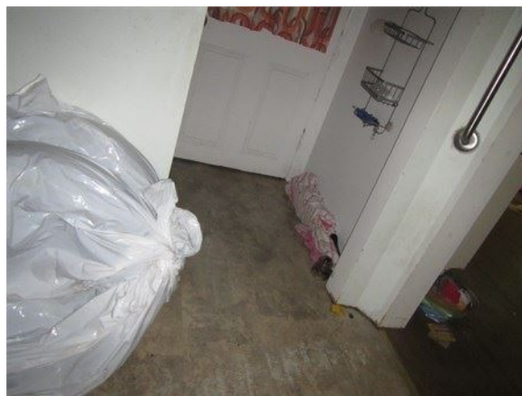
Le plancher de l'espace devant la cuisine, toujours au rez-de-chaussée penche vers l'arrière droit
