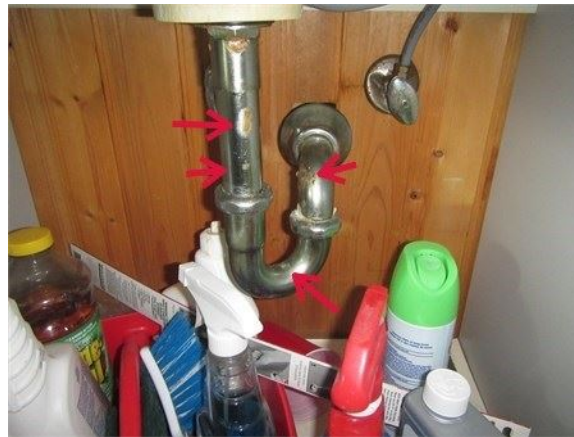
Siphon et tubulure associée à remplacer sous le lavabo de l'étage
