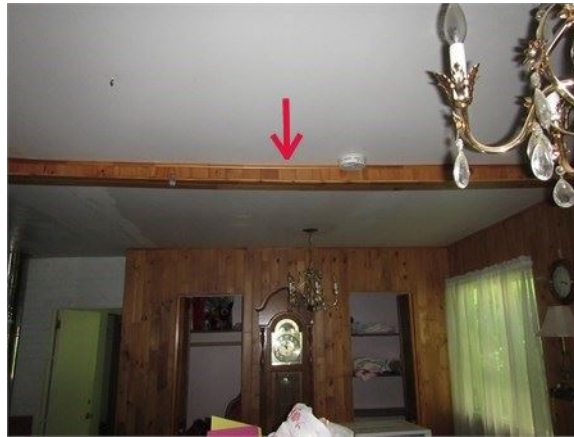
Affaissement de la "poutre" entre les pièces à l'avant droit du rez-de-chaussée
