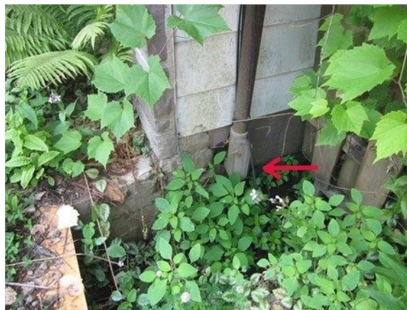
Base du mât électrique trop près du sol
