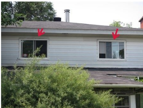
Absence de solins au-dessus des fenêtres de l'étage à l'avant en guise d'exemple
