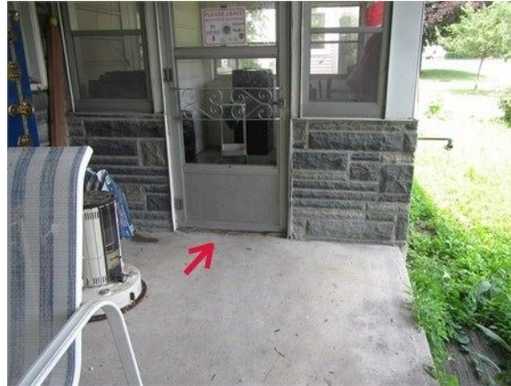
Seuil de la porte de la véranda au niveau de la dalle du perron avant
