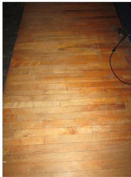
Exemple de parquet à revernir dans la chambre avant gauche de l'étage
