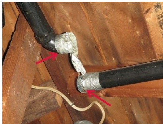
Sceller adéquatement les sections de l'évent de plomberie ensemble
