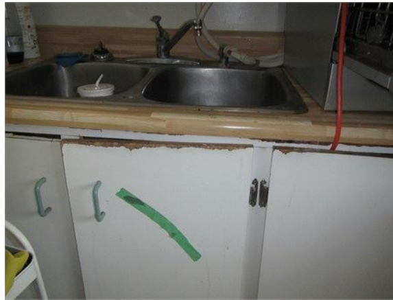
Portes d'armoire et cadre endommagés dans la cuisine de l'étage
