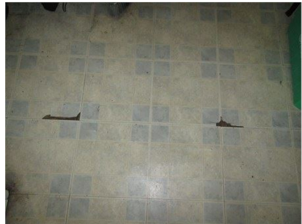
Tuiles endommagées dans la cuisine de l'étage
