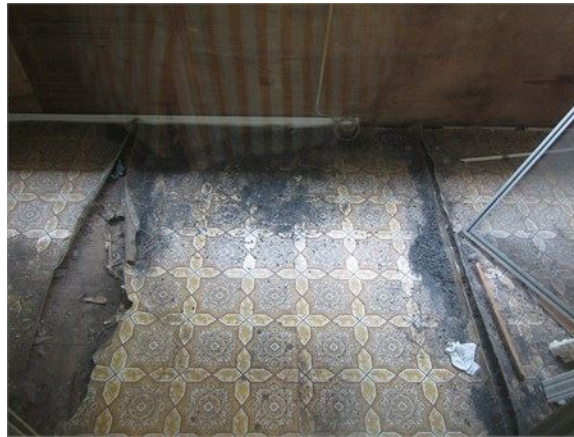
Prélat très endommagé dans la véranda arrière de l'étage : Photo prise au travers de la porte-fenêtre qui ne s'ouvrait pas.
