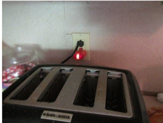
Prise sans mise à la terre sur le comptoir de la cuisine
