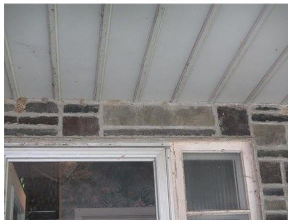
Traces d'infiltration d'eau sur les pierres sous le toit du perron
