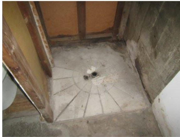
Travaux de la douche à refaire au sous-sol
