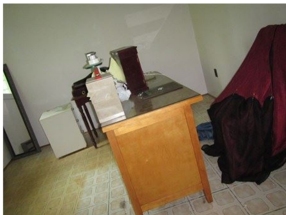
Le plancher de la chambre arrière droite penche vers l'arrière
