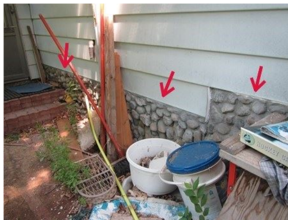
Exemple de bardage d'aluminium directement sur les pierres posées sur les murs de fondation
