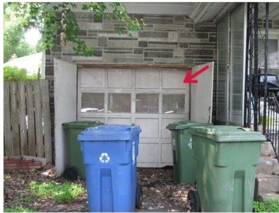
Vieille porte de garage à remplacer
