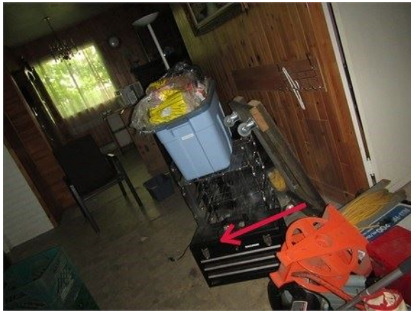
Le plancher de l'espace central du rez-de-chaussée penche vers le centre de la pièce, ici vers l'arrière
