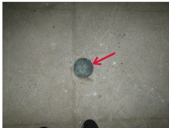
Drain avec bouchon au sous-sol
