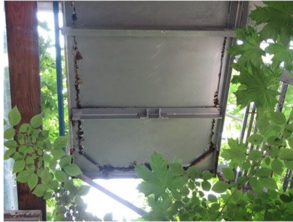
Rouille sous le palier supérieur à l'arrière
