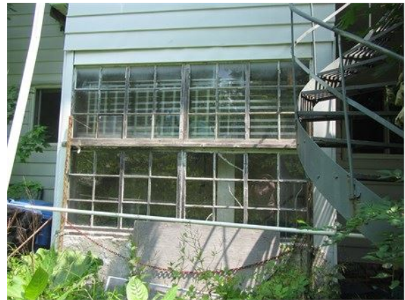
Vieilles fenêtres dans l'escalier du sous-sol à l'arrière
