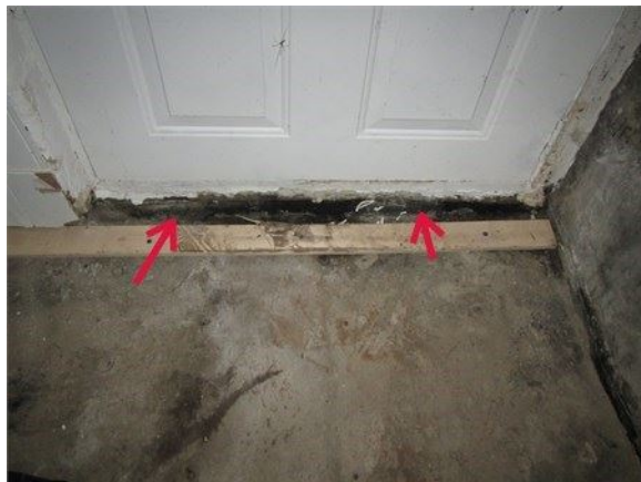
Mouillage sous le seuil de la porte du sous-sol, côté intérieur
