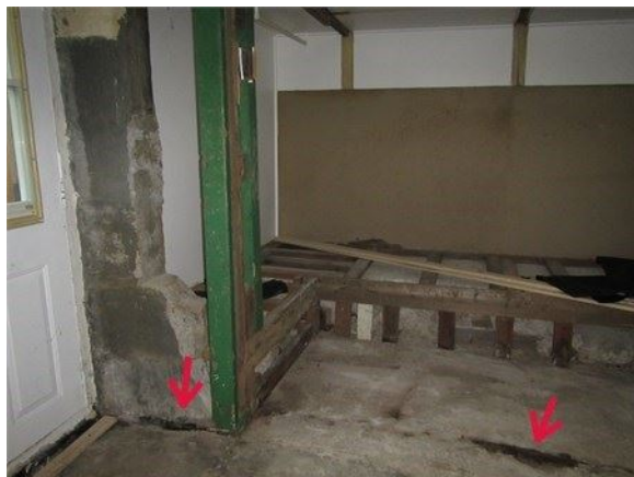
Humidité sur la dalle du sous-sol
