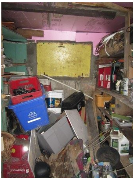
Encombrement sous le perron et la véranda avant
