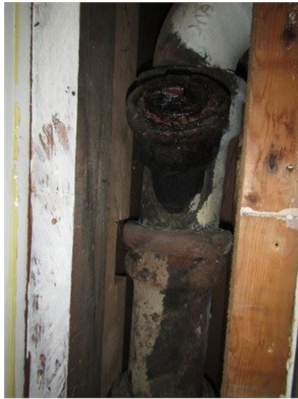
Début de fuite sur la colonne de chute de plomberie
