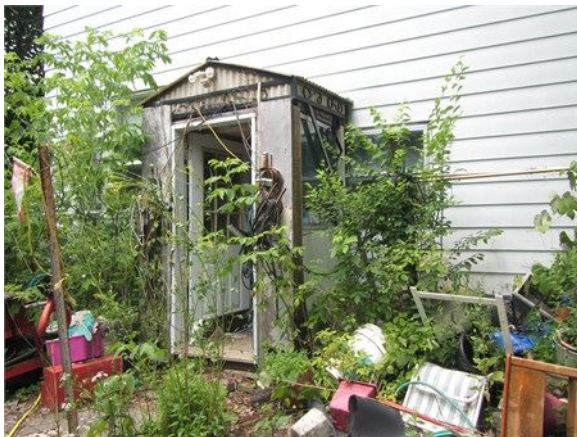
Entrée latérale construite sans respect d'aucune règle de construction
