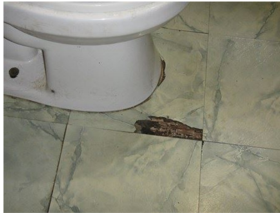
Tuiles endommagées autour de la toilette de l'étage : Vérifier l'état du sous-plancher avant d'installer de nouvelles tuiles
