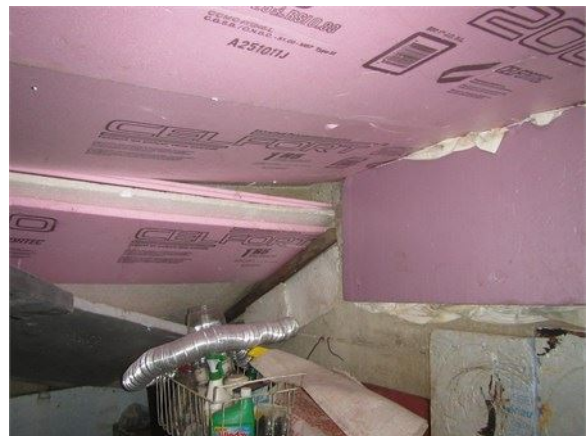
Isolant qui se détache du perron de béton
