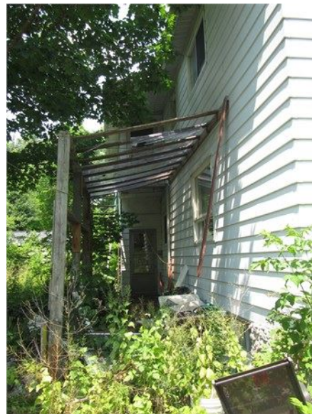
Abri arrière et escalier du sous-sol couvert et véranda arrière de l'étage construits par des amateurs
