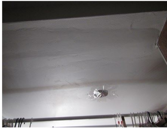
Réparation artisanale au plafond de la salle de bains à corriger
