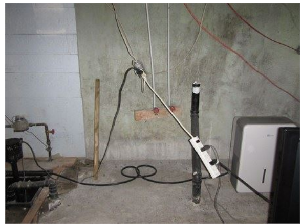
Exemple d'installation non sécuritaire au sous-sol
