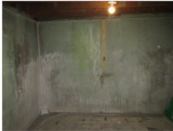
Les murs de fondation ne sont pas isolés
