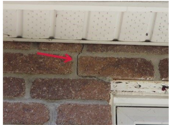
Autre fissure au coin supérieur gauche d'une fenêtre à l'avant centre
