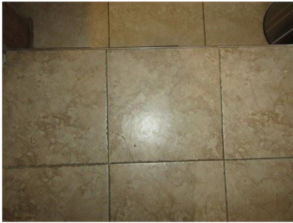
Carreaux fissurés dans la salle de bains et joints de coulis détériorés : prévoir une réfection du revêtement de sol
