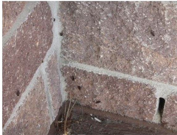
Insectes sur la façade avant à surveiller
