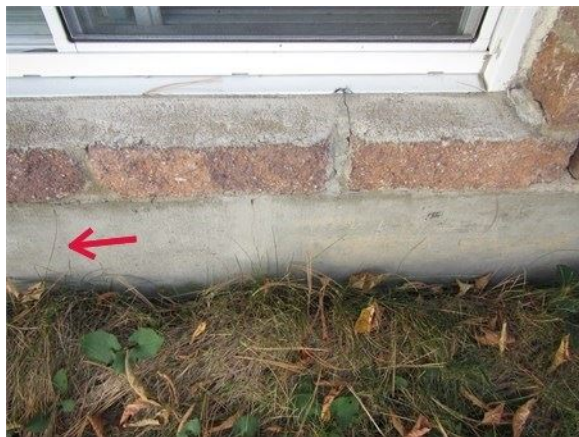
Fissure sous la fenêtre arrière droite
