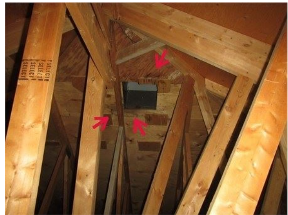
Autres traces d'infiltration d'eau autour de l'aérateur surélevé, pente arrière du toit du garage
