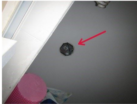
Boîte de jonction ouverte au plafond du placard à refermer
