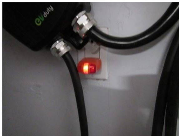
Prise sans mise à la terre dans le garage
