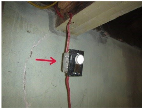
Exemple d'installation non sécuritaire au sous-sol
