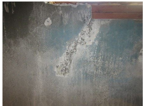
Fissure à surveiller sous une fenêtre
