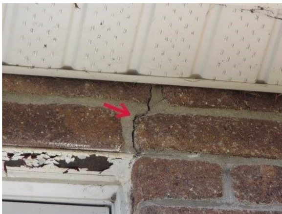
Fissure au coin supérieur droit d'une fenêtre à l'avant centre
