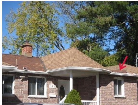
Section élastomère où la pente doit être corrigée au-dessus de la salle de bains
