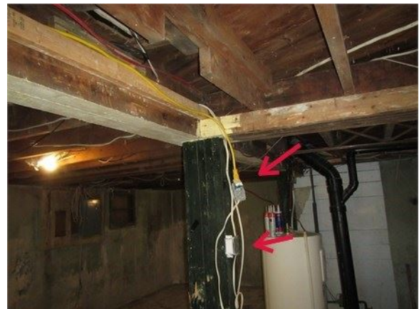
Exemple d'installation non sécuritaire au sous-sol
