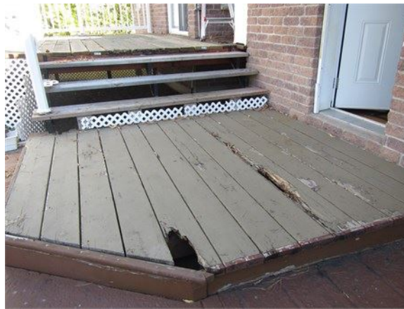
Exemple de lattes du platelage pourries à l'arrière du garage
