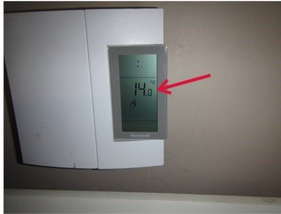
Chauffage à 14°C ce qui est insuffisant
