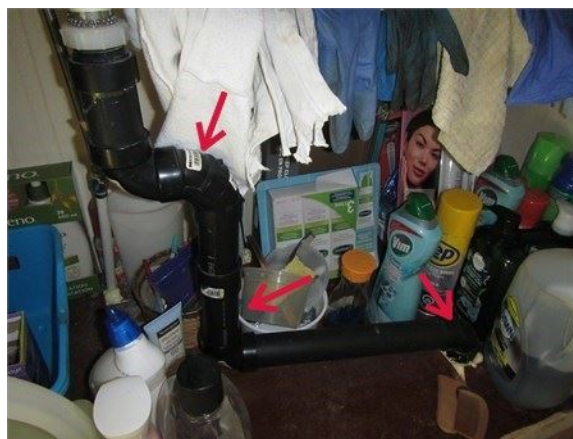
Absence de siphon visible sous le lavabo de la salle de bains
