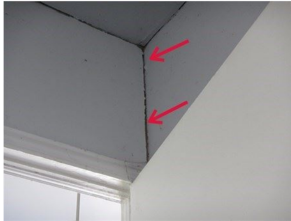
Coin de murs qui n'est pas étanche au-dessus de la porte entre le garage et la maison
