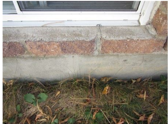
Exemple d'absence d'appui sous une fenêtre du sous-sol, mur arrière en rapproché : seule une couche de ciment qui s'est fissurée a été posée
