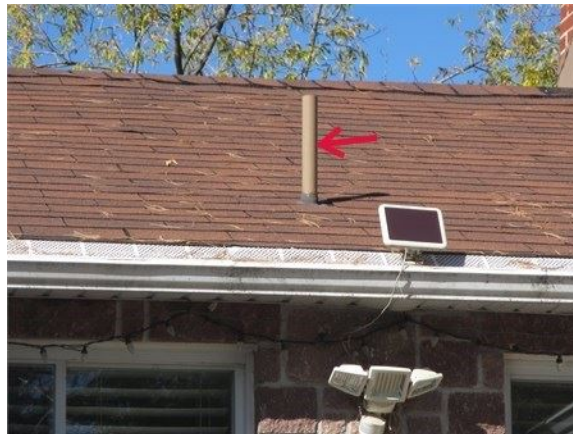
Event de faible diamètre et trop long sur une pente du toit
