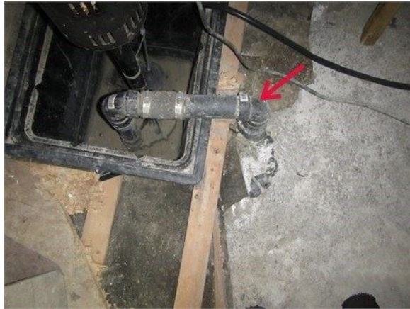
Absence de clapet sur la conduite d'évacuation du puisard du sous-sol
