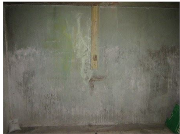
Fissures diverses sur le mur avant droit à faire vérifier par un ingénieur en structure
