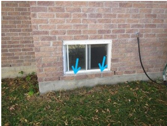
Exemple d'absence d'appui sous une fenêtre du sous-sol, mur latéral arrière
