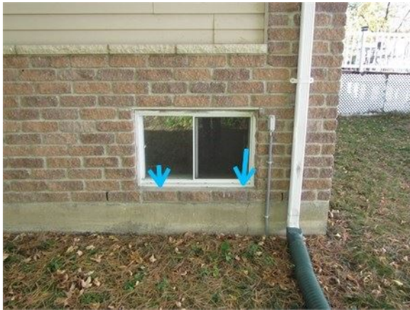
Exemple d'absence d'appui sous une fenêtre du sous-sol, mur latéral droit
