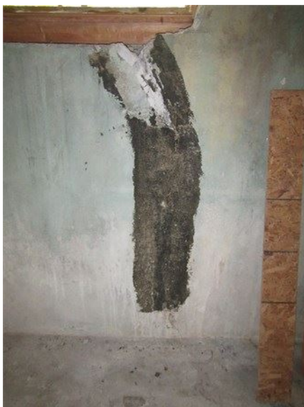
Fissure réparée à surveiller sur le mur latéral droit (il est possible que ce soit la même fissure de l'extérieur)
