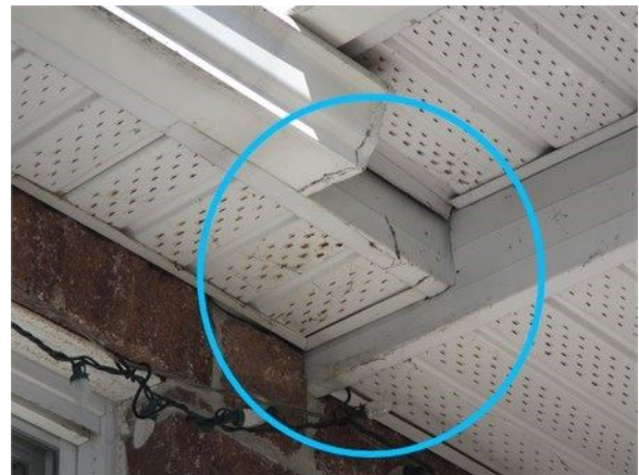
Traces d'infiltration d'eau dans les soffites
