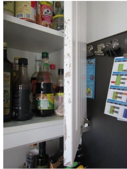
Rive d'une porte d'armoire à réparer dans la cuisine
