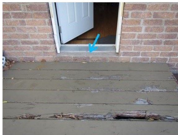
Absence de seuil sous la porte arrière
