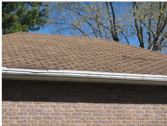
Bardeaux vieillissants à remplacer / noter que certains ont déjà été remplacés
