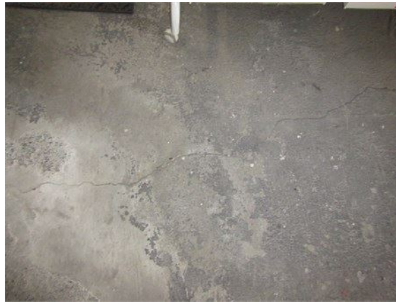
Fissure sur la dalle du garage
