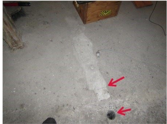
Absence de clapet sur la conduite d'évacuation du drain de plancher à proximité
