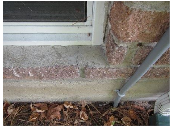
Exemple d'absence d'appui sous une fenêtre du sous-sol, mur latéral droit en rapproché : seule une couche de ciment qui s'est fissurée a été posée
