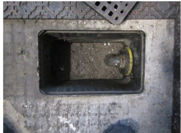
L'intérieur de la fosse à nettoyer
