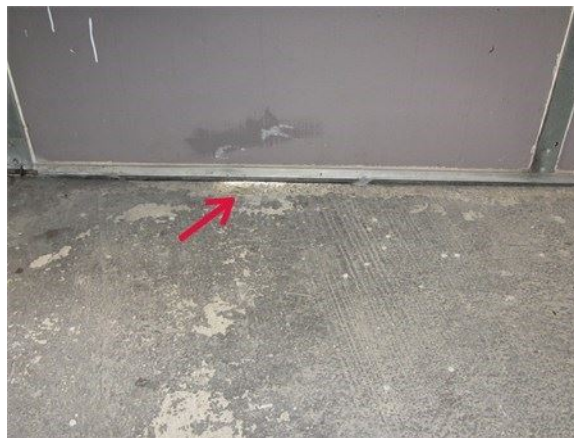
Creu en surface de la dalle sous la porte de garage
