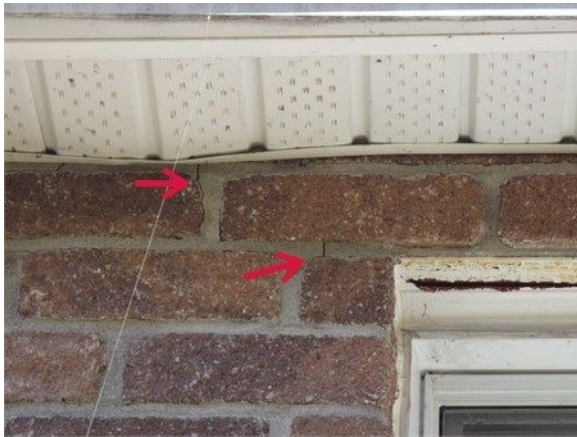
Fissure au coin supérieur d'une fenêtre à l'avant centre
