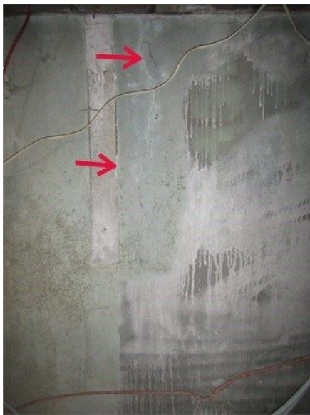
Autre fissure verticale sur le mur avant centre
