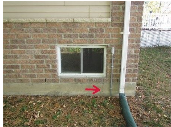
Autre fissure sous la fenêtre latérale droite près de l'arrière
