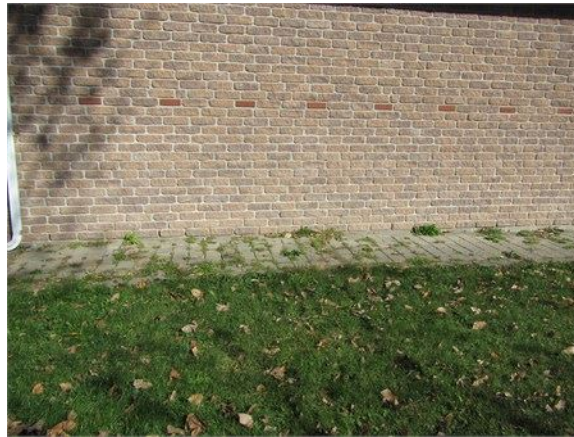
Pavé trop haut sur le parement latéral gauche
