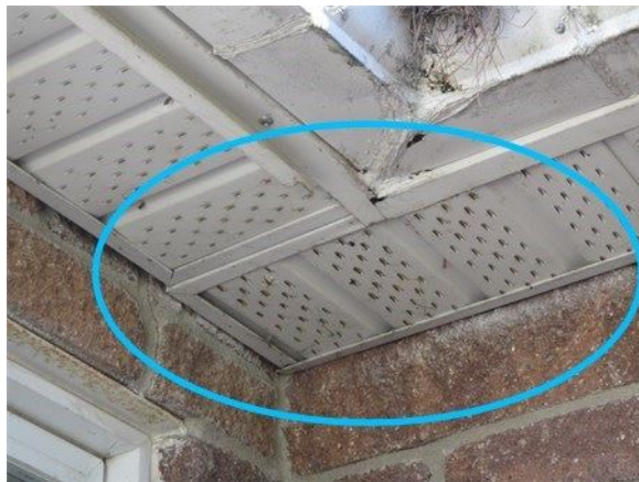
Traces d'infiltration d'eau dans les soffites
