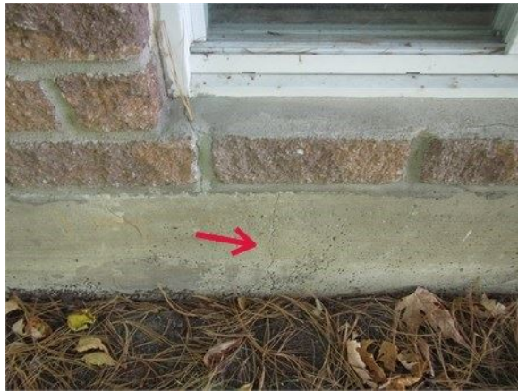
Fissure mineure sous la fenêtre latérale droite
