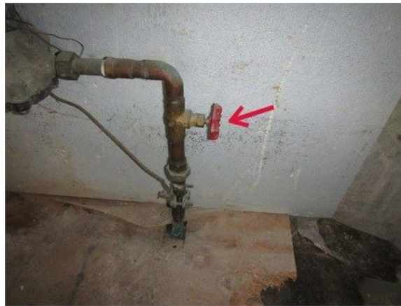
La valve principale d'entrée d'eau près du mur avant du sous-sol
