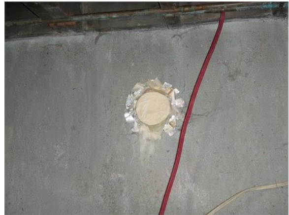
La cheminée condamnée de manière artisanale au sous-sol
