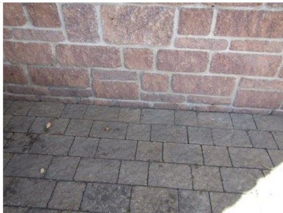
Pavé trop haut sur le parement avant centre
