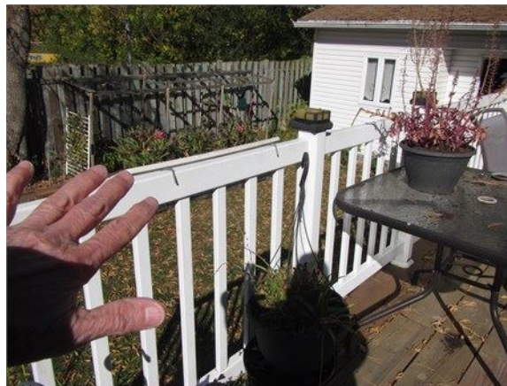
Exemple de garde-corps à solidifier
