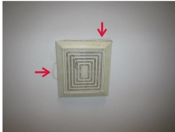
Le ventilateur dans la salle de bains et les taches de condensation
