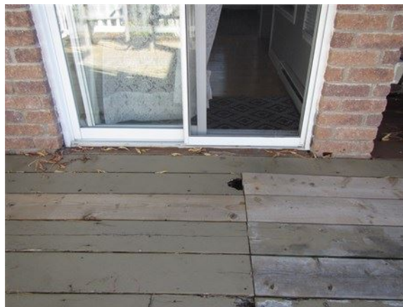
Le seuil de la porte-fenêtre est trop près de la terrasse : Dégager vers le bas d'au moins 4 à 6 po.
