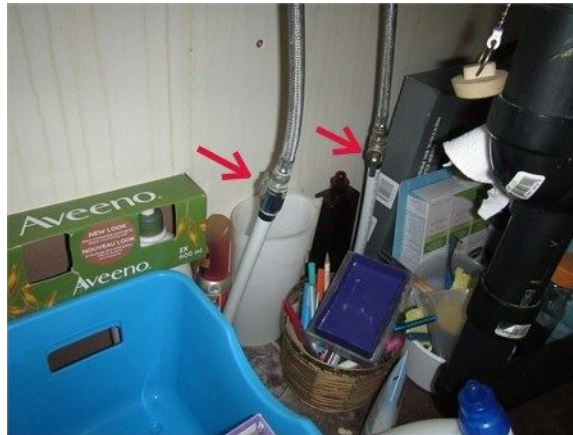
Exemple d'absence d'anti-béliers sous un appareil de plomberie
