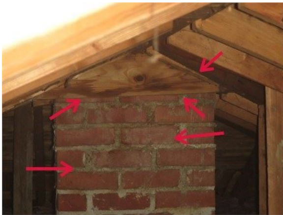
Traces d'infiltration d'eau autour de la cheminée dans l'entretroit
