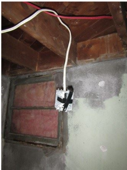
Exemple d'installation non sécuritaire au sous-sol
