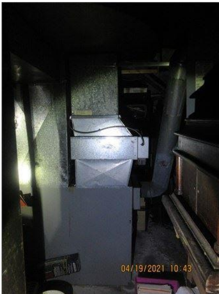
Vue de la fournaise électrique
