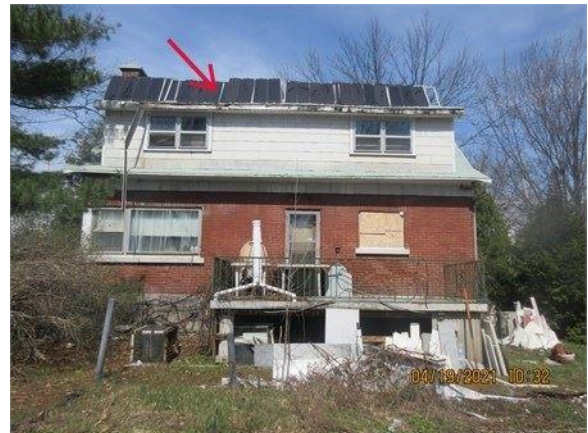
Vue des panneaux solaire installés sur l'élévation avant
