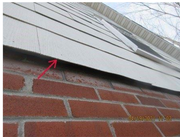
Aucune ventilation du revêtement extérieur
