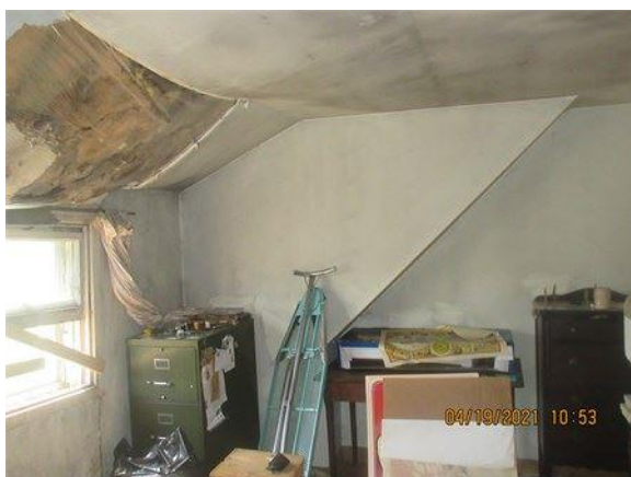
Vue des dégâts d'infiltration d'eau de la toiture
