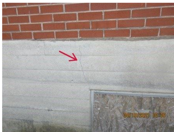
Exemple de fissures sur le mur de fondation
