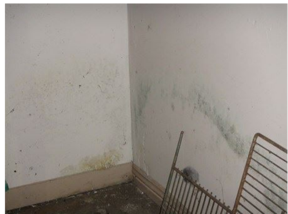
Autres taches qui pourraient comporter des moisissures sur des murs au sous-sol
