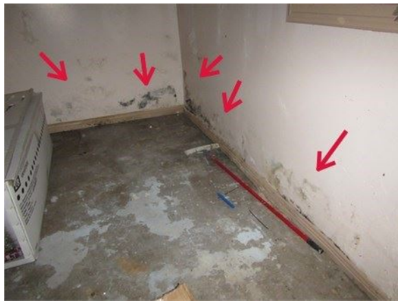
Taches qui pourraient comporter des moisissures au bas de murs dans le sous-sol
