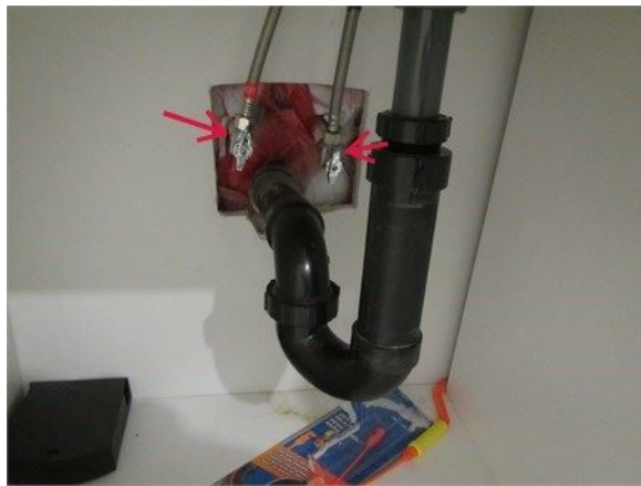
Absence d'anti-béliers sous un appareil de plomberie
