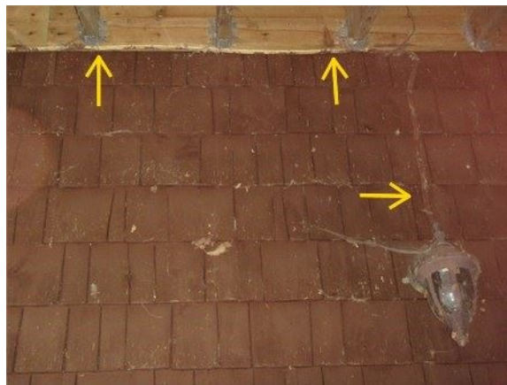
Exemple de câble à protéger à l'extérieur, ici dans l'abri d'auto
