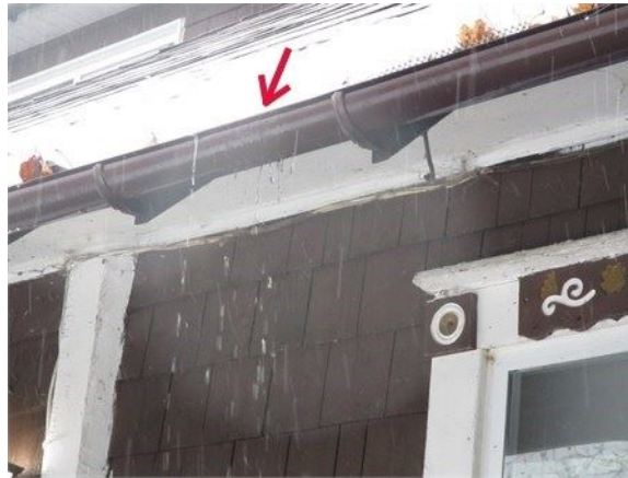
Gouttière en PVC à l'avant qui déborde
