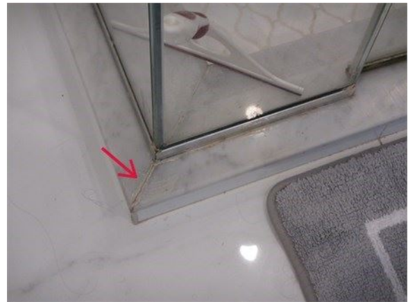
Joint de coulis sur un coin de la douche à refaire
