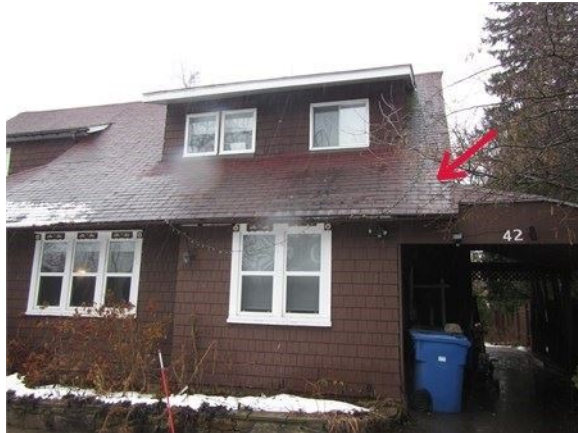
Affaissement de la toiture à l'avant droit
