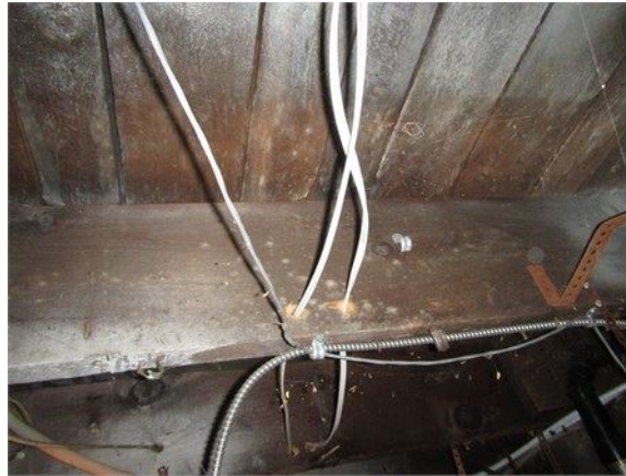
Taches qui pourraient comporter des moisissures dans la structure du plancher du rez-de-chaussée
