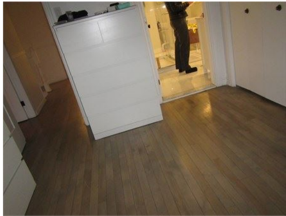
Le plancher de la chambre des maîtres près de la salle de bains et de la porte d'entrée penche vers l'arrière
