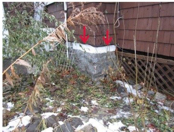
Fondation de pierres en saillie sur le revêtement extérieur : Installer un solin d'étanchéité lors du remplacement du bardage sur les murs extérieurs
