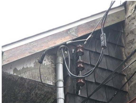
Tête de mât sous les soffites
