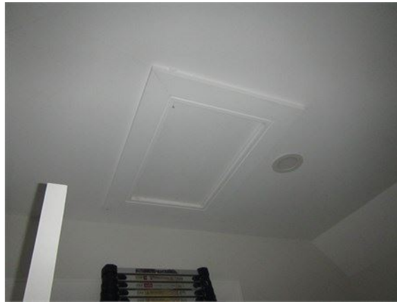
Trappe d'accès au plafond de la salle de bains à déplacer
