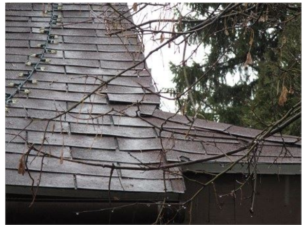
Bardeaux mal fixés et mal collés à l'avant droit
