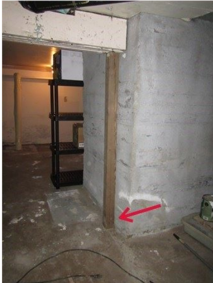
Exemple de poteau en bois qui repose au sol sans fixation
