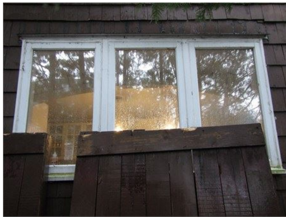
Absence de solin au-dessus de la fenêtre de la cuisine, là où des infiltrations d'eau ont été constatées
