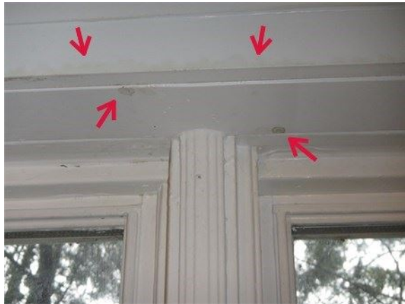
Taches d'infiltration d'eau au haut de la fenêtre de la cuisine
