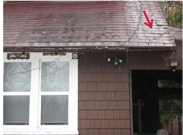
Affaissement de la toiture au niveau du débord de toit avant droit
