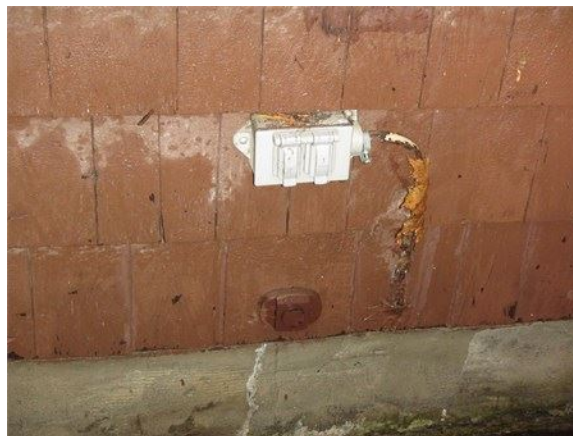
Ancienne prise extérieure à remplacer
