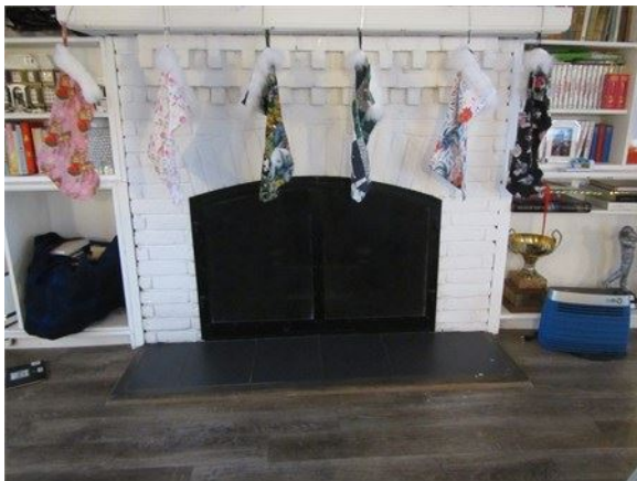
Le foyer au rez-de-chaussée à faire vérifier ou à condamner
