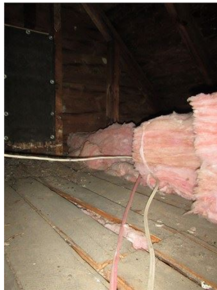
Isolation inégale de l'entretoit
