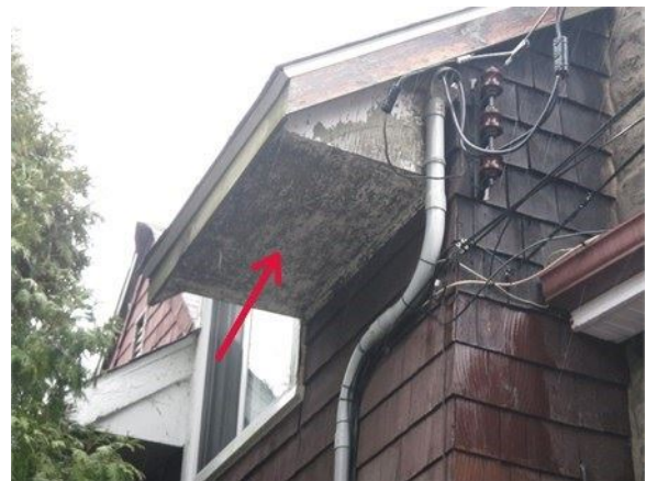
Soffites non ventilés à corriger par l'ajout de grilles de ventilation
