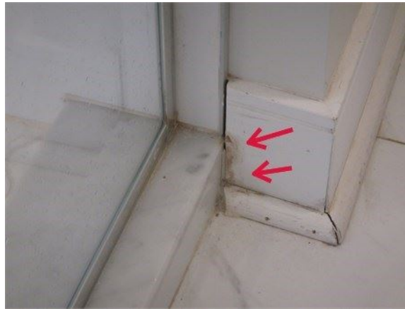
Traces d'eau hors de la douche
