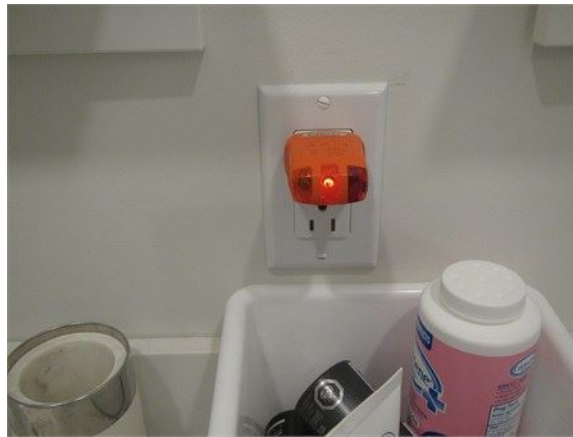
Exemple de prise sans mise à la terre dans une salle de bains de l'étage
