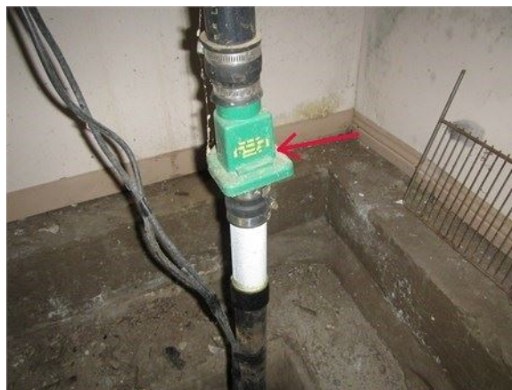
Le clapet sur la conduite d'évacuation du puisard
