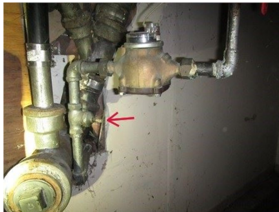
Vieille valve abandonnée laissée en place dans la conduite d'arrivée d'eau en acier galvanisé à remplacer
