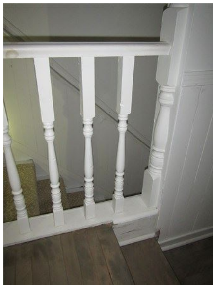
Barrotins trop espacés au haut de l'escalier de l'étage
