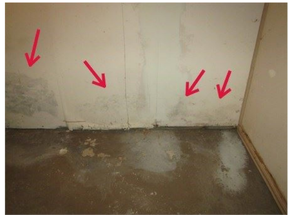
Autres taches qui pourraient comporter des moisissures dans le sous-sol
