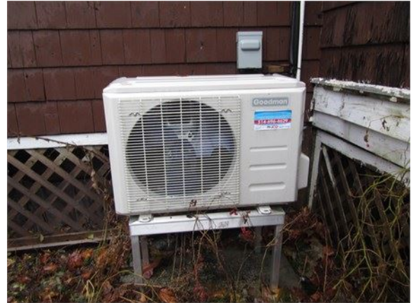
Un des compresseur à l'extérieur
