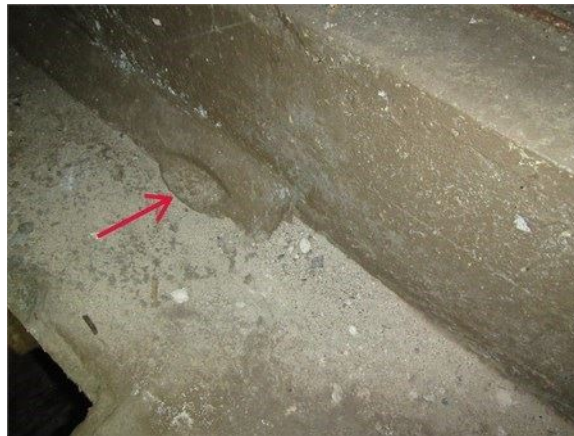
Drain qui débouche sur le palier du puisard du sous-sol
