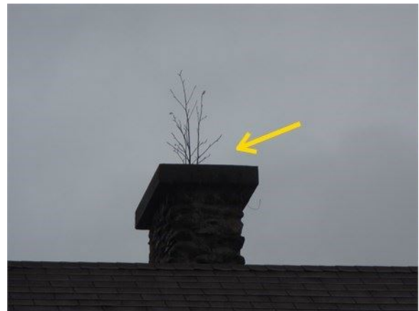
Arbre qui pousse dans la cheminée à enlever : Faire vérifier la cheminée par un spécialiste si elle est toujours en service
