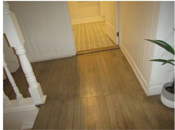
Le plancher de l'étage au haut de l'escalier penche vers l'arrière
