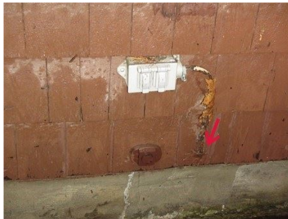
Exemple de câble qui entre dans le bâtiment sans boucle vers le bas avant de pénétrer le revêtement mural
