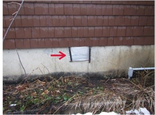
Fenêtre mal condamnée sur le mur latéral gauche à l'arrière
