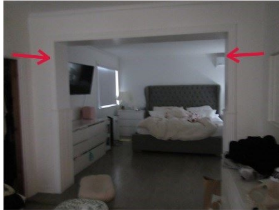
Ouverture probable créée entre des pièces à l'étage
