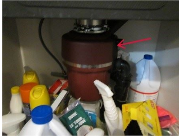
Le broyeur sous l'évier de la cuisine
