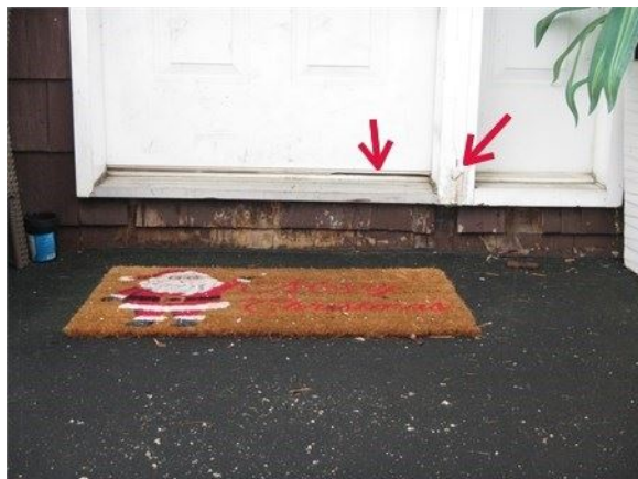
Coupe-froid endommagé sous la porte / Assemblage du montant latéral droit avec la section vitrée cassé
