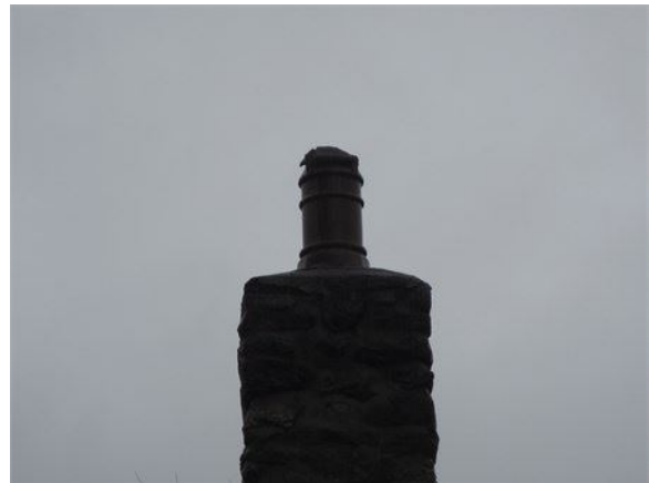
Absence de couronnement au sommet de la cheminée de maçonnerie
