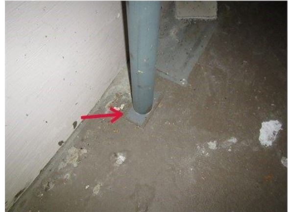
Exemple de poteau d'acier qui repose au sol sans fixation
