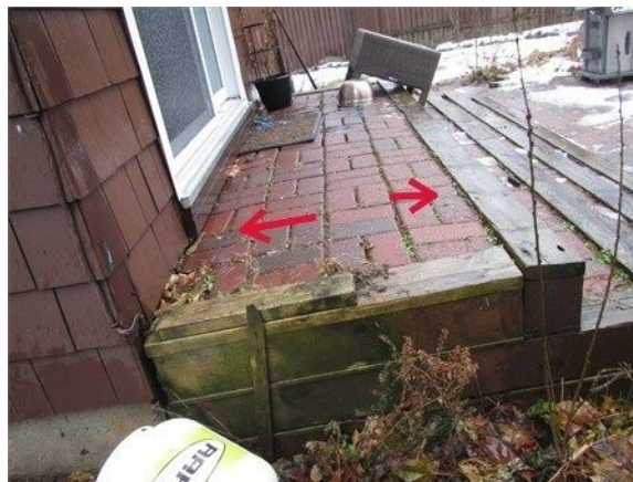
Pavé uni affaissé à refaire à l'arrière
