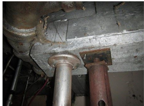
Autre exemple de plaques de poteaux de largeur insuffisante pour supporter la poutre
