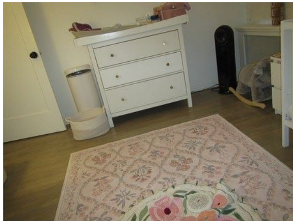
Le plancher de la chambre arrière droite de l'étage penche vers l'avant
