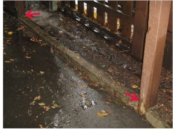
Poteaux de bois à même le sol
