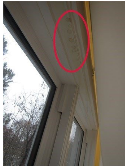
Taches d'infiltration d'eau au haut de la fenêtre de la salle de bains de l'étage
