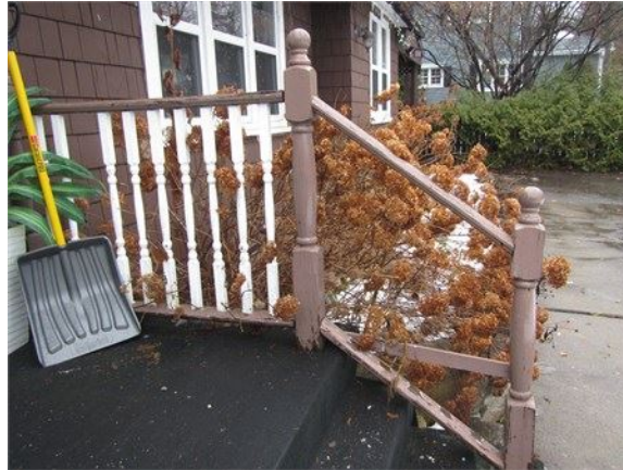
Garde-corps non sécuritaire à l'avant
