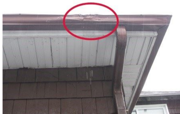
Gouttière qui coule à l'arrière
