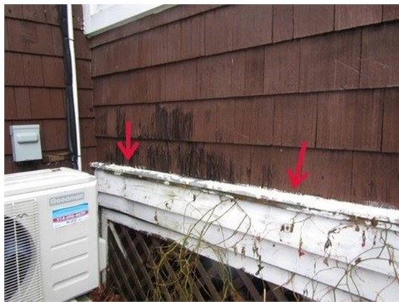
Autre platelage d'un ancien balcon apparent à l'extérieur du revêtement mural, extension gauche
