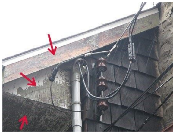
Fascia et soffites à repeindre
