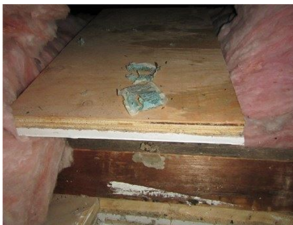
Vermine et nourriture à vermine sur la trappe d'accès à l'entretoit dans la salle de bains de l'étage
