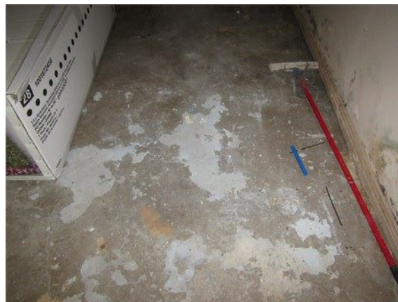
Peinture qui s'écaille sur la dalle de béton du sous-sol
