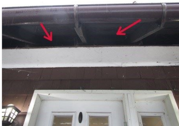
Absence de soffites apparents à l'avant, au-dessus de la porte d'entrée
