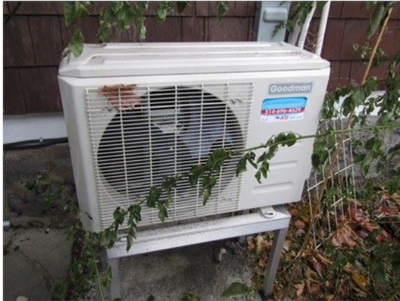
Un des compresseurs à l'extérieur
