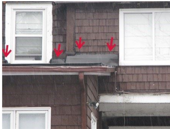
Exemple de contre-solins posés en surface du revêtement de bois des murs extérieurs, ce qui est fautif.
