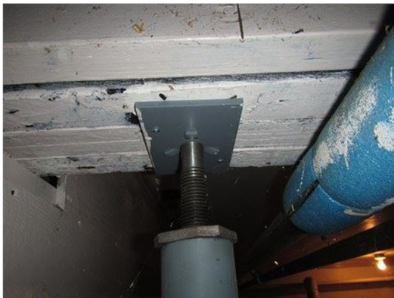
Plaque dont la largeur est insuffisante sous une poutre
