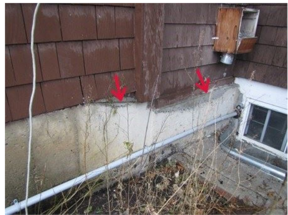
Fondatino en saillie sur les murs extérieurs : Installer un solin d'étanchéité lors du remplacement du bardage extérieur
