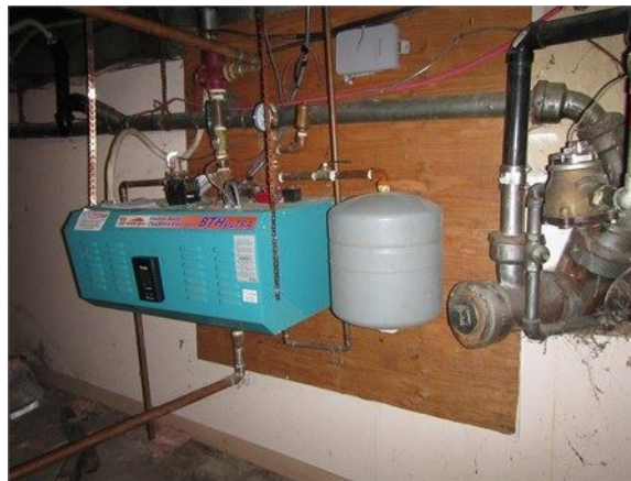
La bouilloire électrique dans le sous-sol
