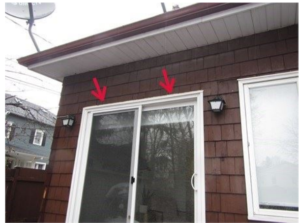
Absence de solin au-dessus de la porte-fenêtre arrière de la cuisine
