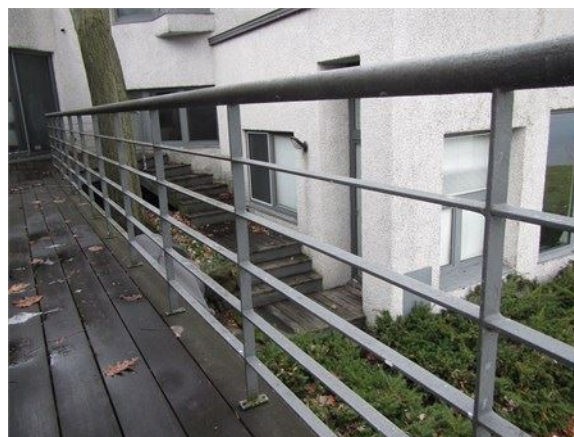
Garde-corps non sécuritaire en guise d'exemple
