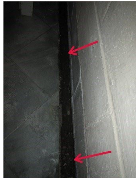
Infiltration d'eau au bas du mur latéral gauche, salle familiale dégarnie
