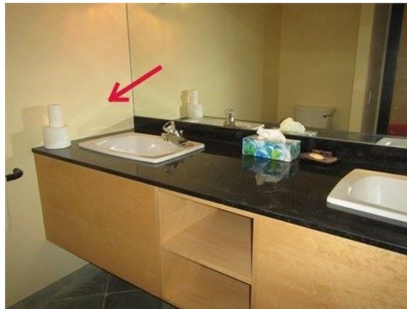
Absence de prise près des lavabos au sous-sol
