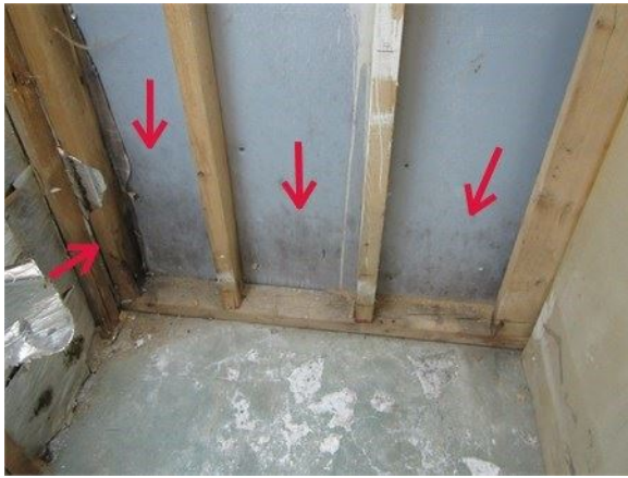
Taches sur des matériaux qui pourraient comporter des moisissures dans un rangement du sous-sol
