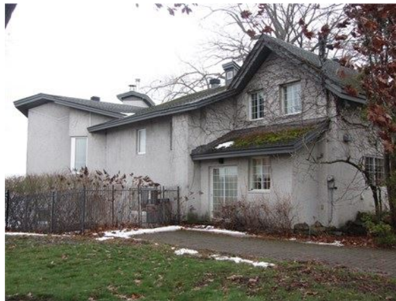
Exemple d'absence de gouttières du côté avant gauche
