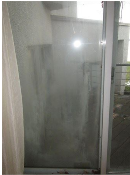
Double-vitrage descellé dans la porte-fenêtre arrière centre
