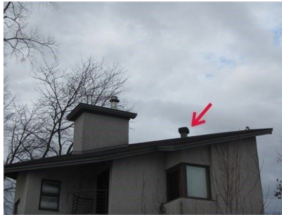
Un des aérateurs observé sur l'extension arrière
