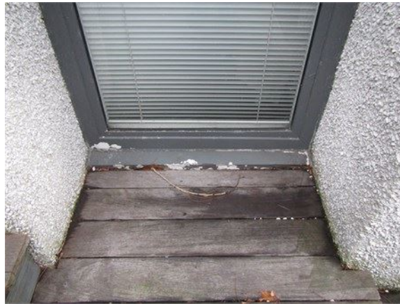
Fenêtre sur le mur latéral droit de l'aile arrière gauche trop près du balcon
