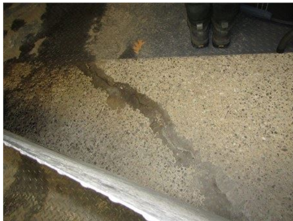
Exemple de fissures dans le garage
