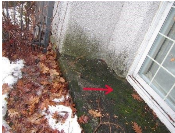
Pente négative de la dalle devant la porte-fenêtre à gauche de la cuisine
