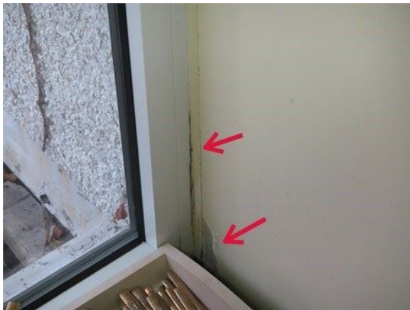
Condensation et/ou infiltration d'eau près d'une fenêtre de la salle à manger
