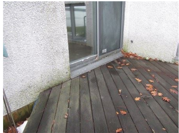
Porte-fenêtre trop près du balcon à l'arrière centre
