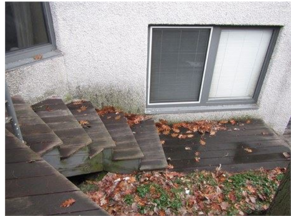
Absence de solin entre le platelage d'un escalier/balcon et le mur extérieur recouvert de stuc / Noter les taches foncées et la présence de mousse ce qui peut causer des dommages au mur derrière le stuc / Noter l'absence de main courante et de garde-corps
