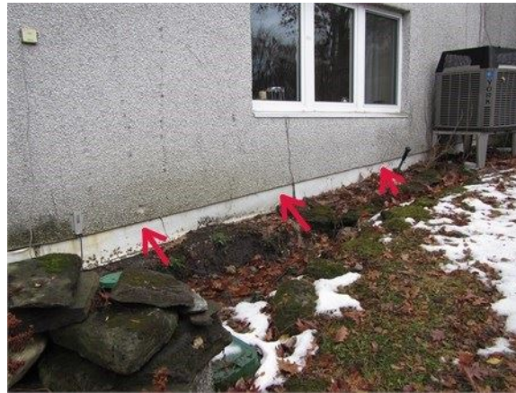
Absence de ventilation au bas du mur latéral gauche, en guise d'exemple
