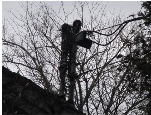
Plantes grimpantes sur les mâts électriques
