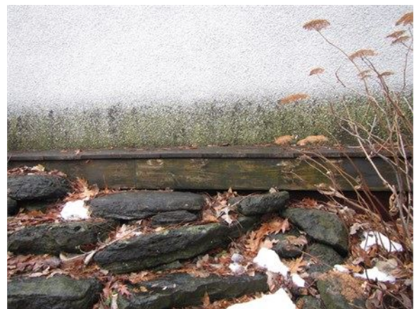
Niveau du sol trop haut sur le mur latéral droit
