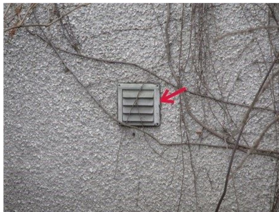
Registre d'entrée d'air à vérifier : Il pourrait s'agir de la sècheuse
