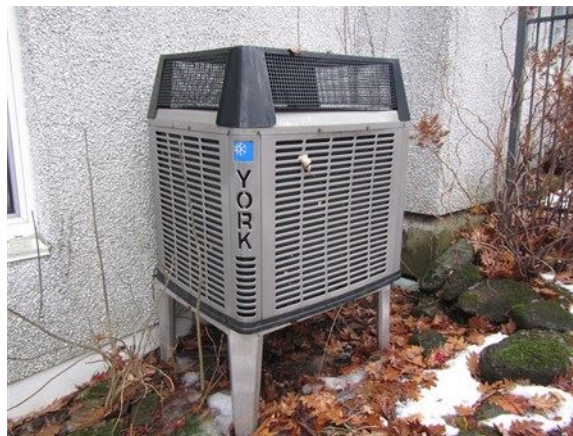
La thermopompe sur le mur latéral gauche
