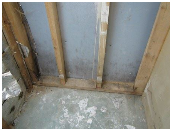
Taches sur des matériaux dans un rangement partiellement dégarni
