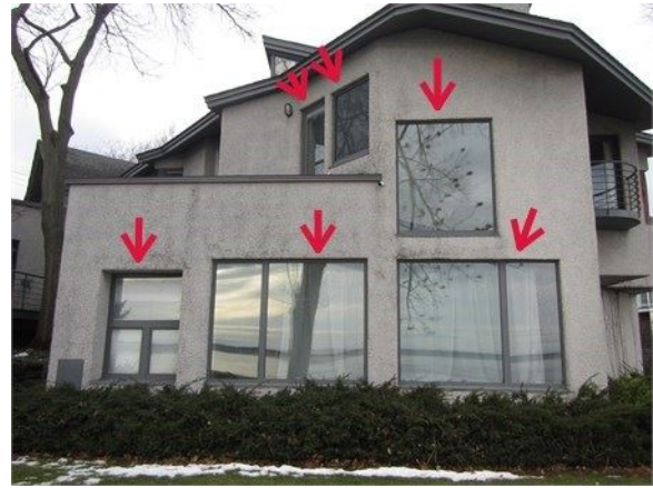
Absence de solins au-dessus des ouvertures à l'arrière
