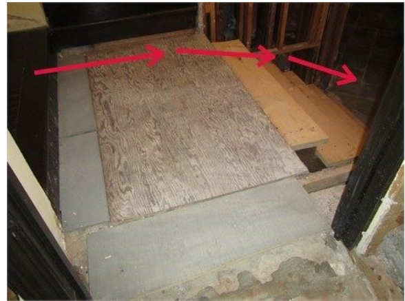
L'eau coulait comme une rivière du sous-sol avant vers le sous-sol central et le vide sanitaire arrière
