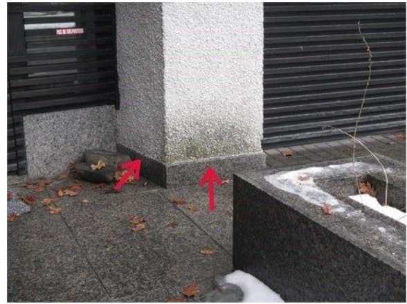
Absence de ventilation au bas de murs extérieurs entre l'entrée principale et le garage / Noter les taches foncées qui pourraient indiquer des infiltrations d'eau dommageables
