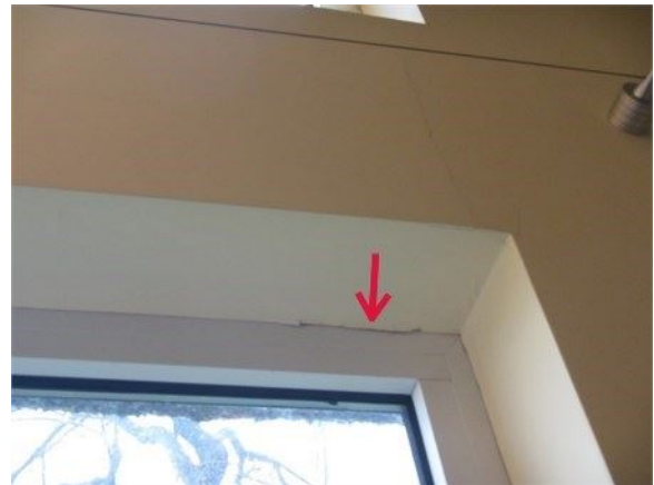
Peinture qui s'écaille au haut d'une fenêtre
