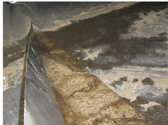
Exemple de fissures et de soulèvement sur la dalle du garage
