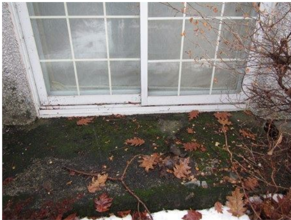
Porte-fenêtre trop près du palier de béton (avec pente négative à corriger) sur le mur latéral gauche de la cuisine
