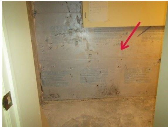
Polystyrène extrudé à protéger dans un rangement du sous-sol du bâtiment d'origine
