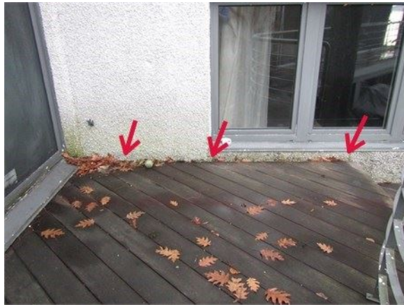
Absence de solin entre le platelage d'un balcon et le mur extérieur recouvert de stuc
