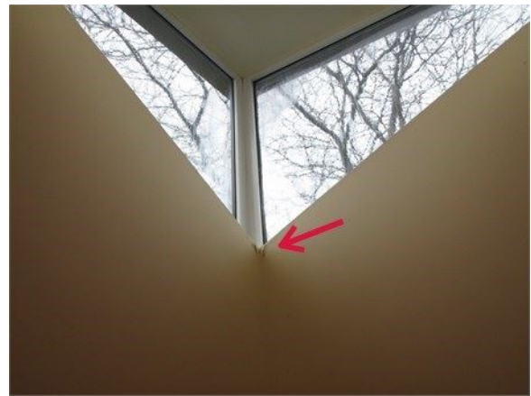
Taches probables de condensation au haut de l'escalier
