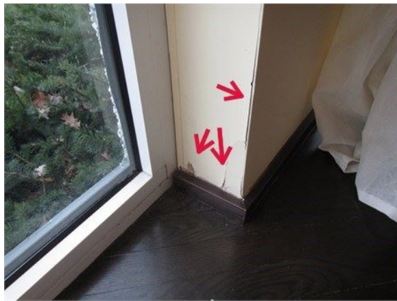
Peinture qui s'écaille près d'une fenêtre au rez-de-chaussée
