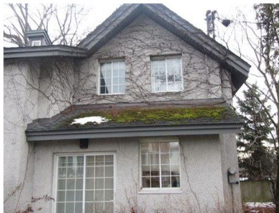
Exemple de mousse sur la pente avant gauche du toit
