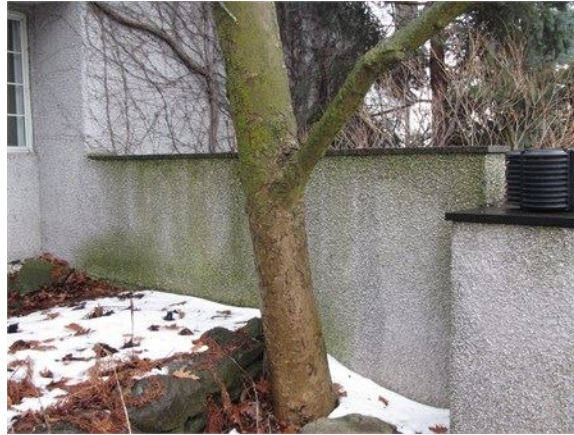
Taches importantes sur les murets à l'avant
