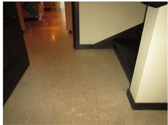
Fissures sur le palier au bas de l'escalier principal
