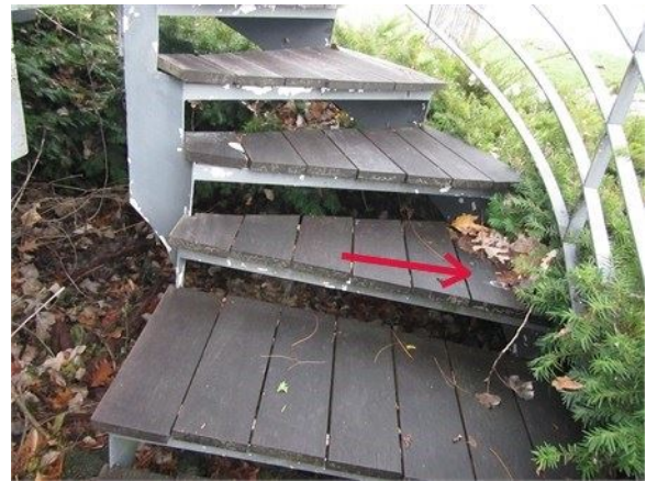
L'escalier est affaissé vers l'arrière
