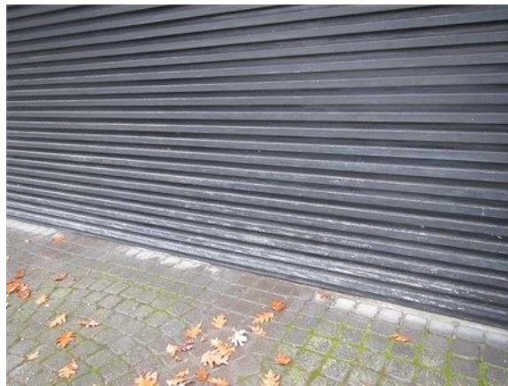
Porte du garage à repeindre/teindre
