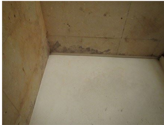
Joints de coulis à refaire et carreaux à nettoyer au bas des murs de la douche
