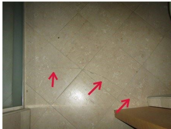
Fissure dans la salle de bains des maîtres
