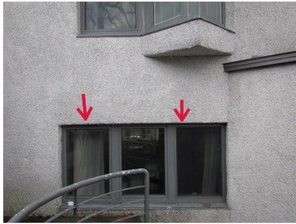
Exemple d'absence de solin au-dessus d'une ouverture
