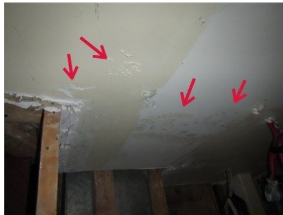
Taches au plafond du sous-sol dégarni
