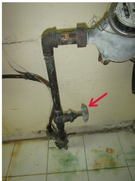
Vieux robinet d'arrêt d'eau à remplacer
