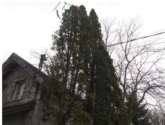
Les câbles passent dans les arbres à l'avant gauche
