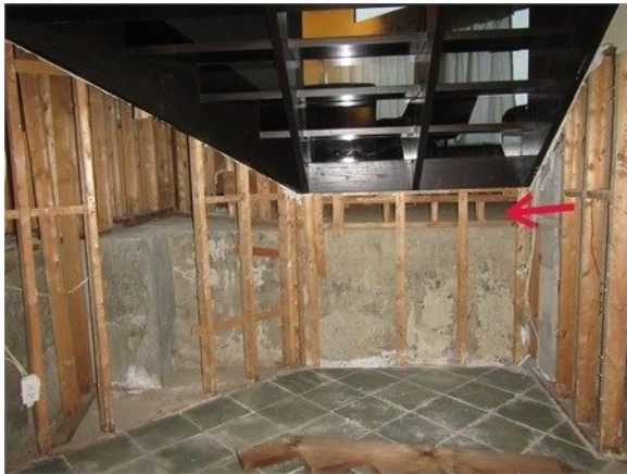
Le sous-sol central (avec les tuiles vertes), point de vue vers l'arrière vers le vide sanitaire où l'eau s'est infiltrée puisque le sous-sol s'est rempli d'eau
