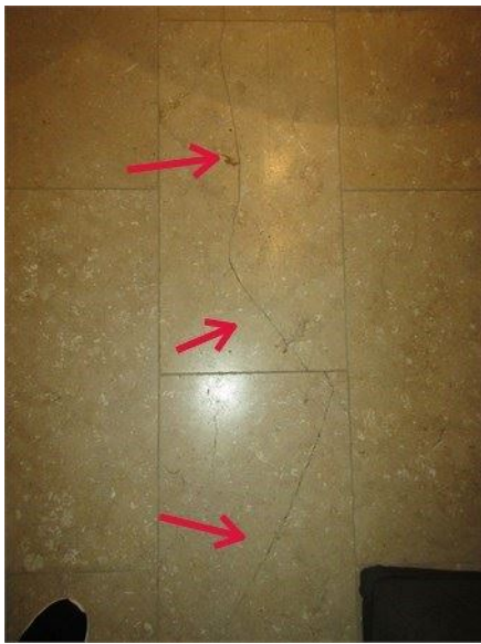
Exemple de fissure dans la cuisine
