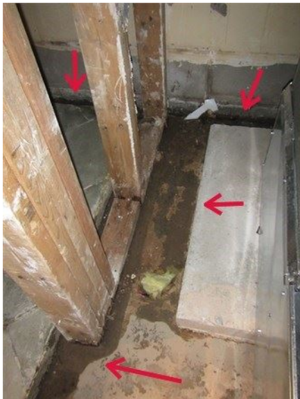
Des infiltrations d'eau se produisent le long du mur latéral gauche, espace de la fournaise
