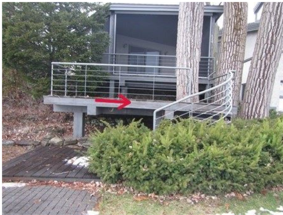
La terrasse à l'arrière du garage penche vers la gauche
