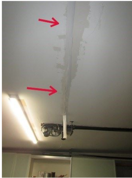
Joint à refaire au plafond du garage
