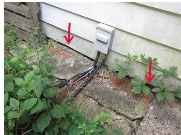
Revêtement trop près du sol à l'arrière droit
