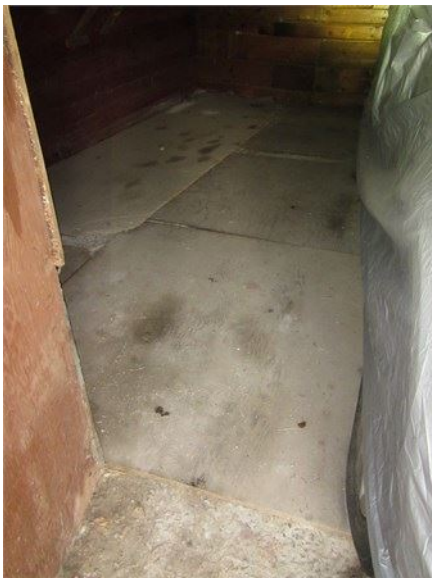
Contreplaqué sur terre battue, ce qui peut contaminer le sol si des voitures sont entreposées
