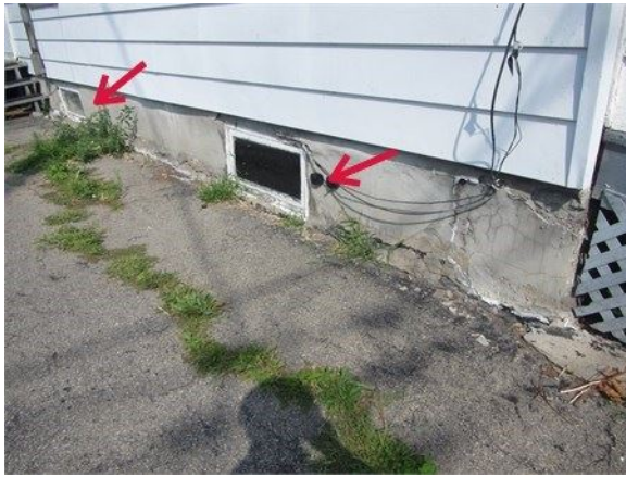
Fenêtres du vide sanitaire sur le mur latéral gauche trop près du sol
