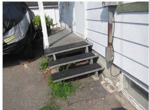
Affaïssement important du perron latéral
