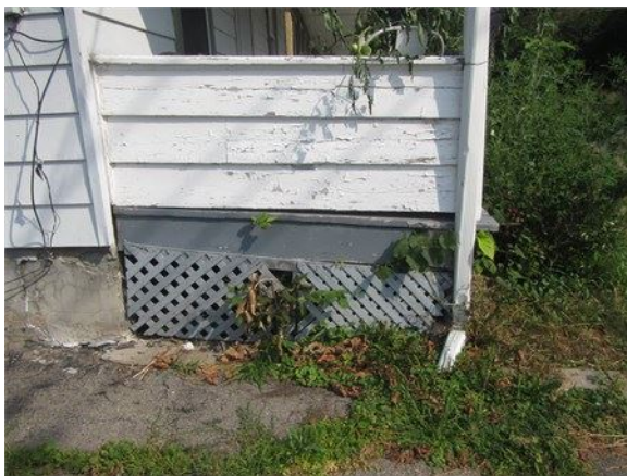
La galerie avant du rez-de-chaussée penche vers l'avant
