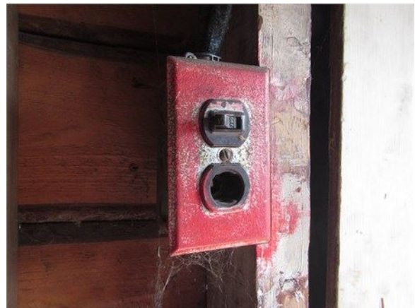
Vieille électricité à mettre à niveau
