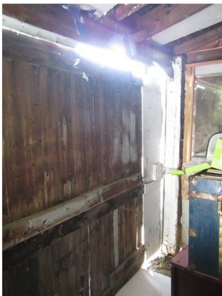
Les portes du garage ne sont pas étanches
