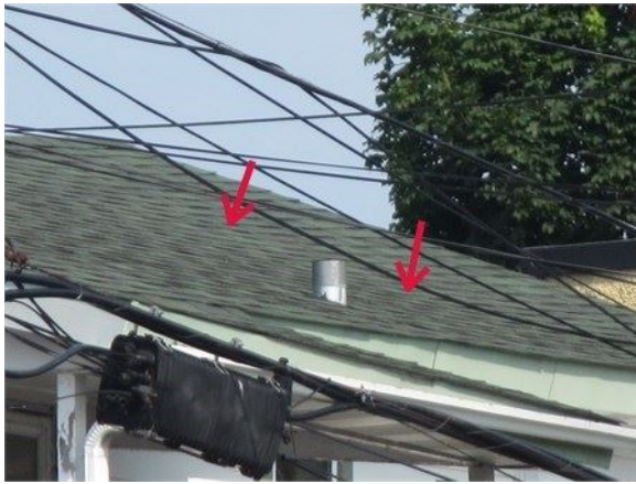
Affaissement de la toiture, pente avant
