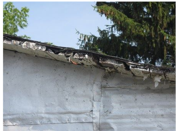
La structure du toit en planches est en mauvais état à l'extérieur
