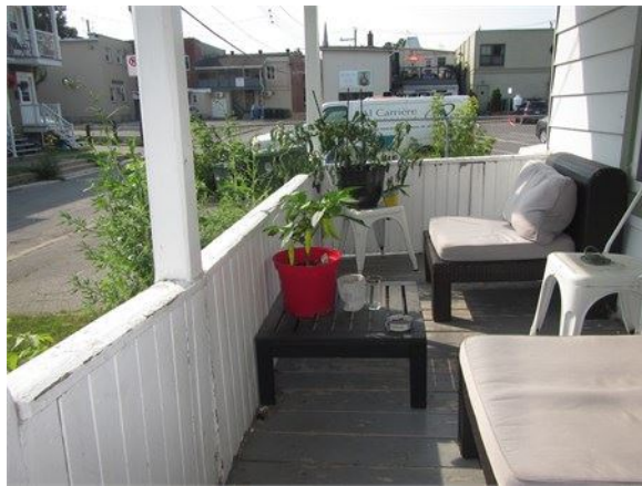
Garde-corps trop bas sur la galerie avant
