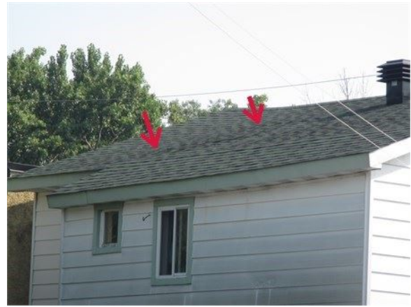
Affaissement de la toiture, pente arrière
