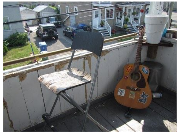
Garde-corps trop bas sur le balcon avant de l'étage
