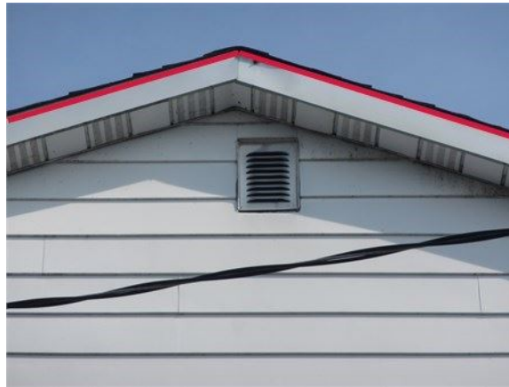
Absence de solins entre le fascia et les bardeaux de la toiture
