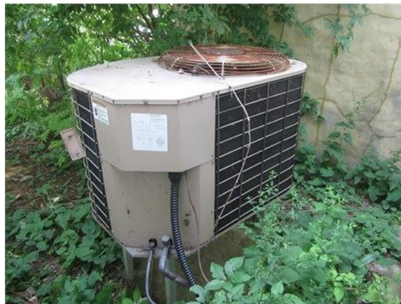
Le compresseur de la thermopompe
