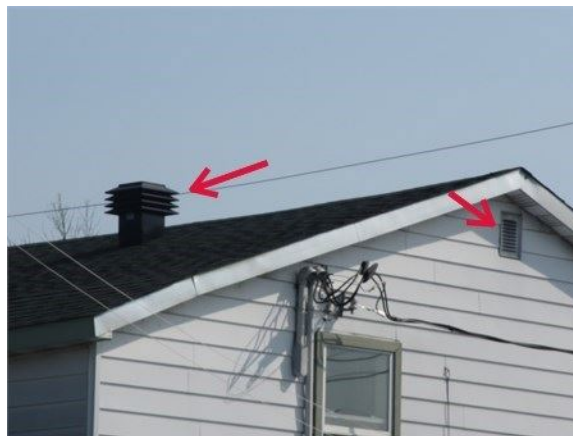
Aérateur de toit et grille de pignon
