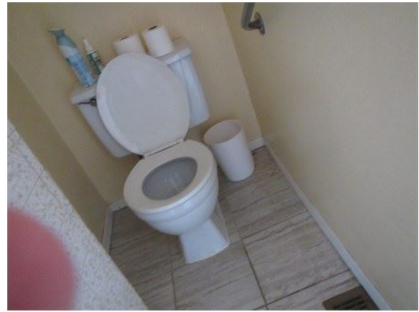
Le plancher de la salle de bains du rez-de-chaussée penche vers l'arrière
