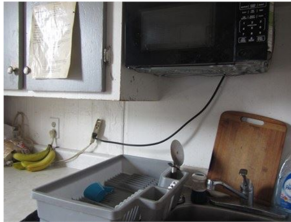
Le four à micro-ondes branché à l'aide d'une extension sur le comptoir de la cuisine
