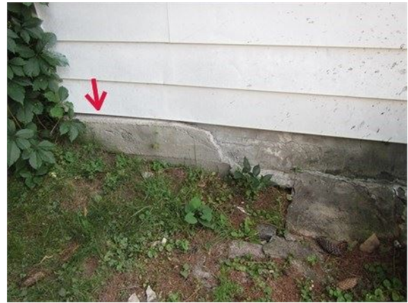
Autre mur de fondation qui excède le bardage d'aluminium
