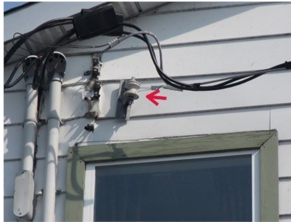
Support des conducteurs qui ne semble pas stable sur le mur
