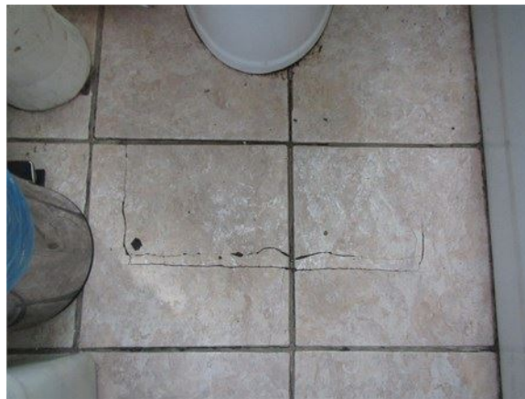
Carreaux endommagés dans la salle de bains de l'étage
