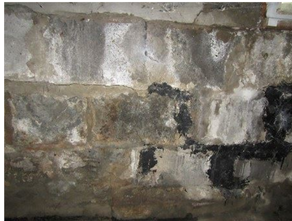
Exemple d'infiltrations d'eau par un mur de fondation
