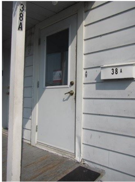
Porte de l'étage posée à l'envers, partiellement protégée par la marquise
