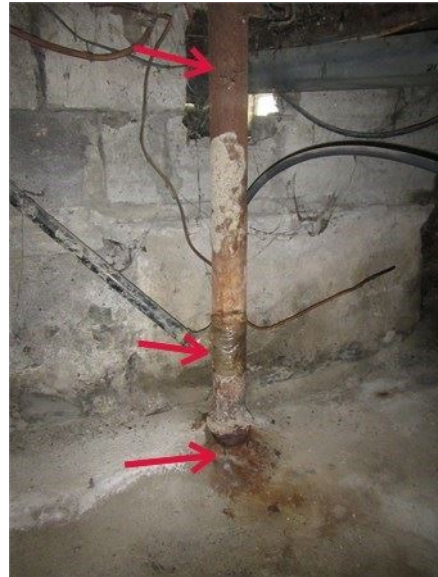
Colonne de chute rouillée à remplacer par prudence
