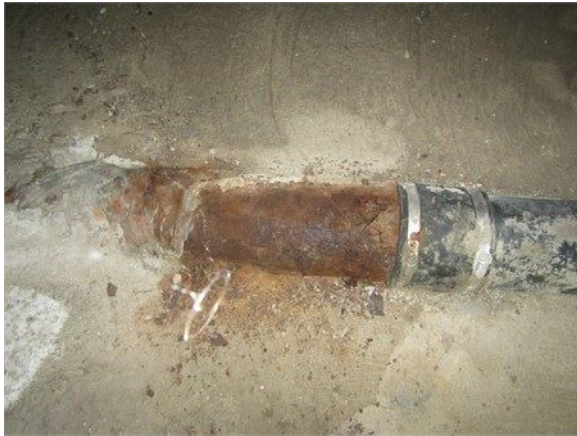
Section du collecteur qui n'a pas été remplacée et qui est très rouillée dans la dalle du vide sanitaire
