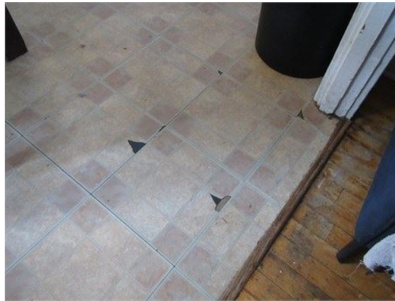
Tuiles de vinyle endommagées dans la cuisine de l'étage
