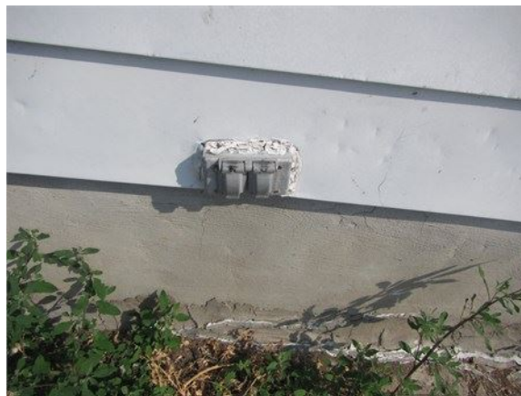
Prise extérieure à remplacer
