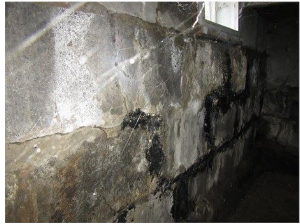
Déplacement important et infiltrations d'eau dans le mur arrière de l'extension arrière à faire expertiser
