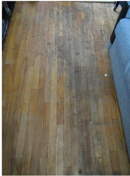
Vernis du parquet de l'étage usé
