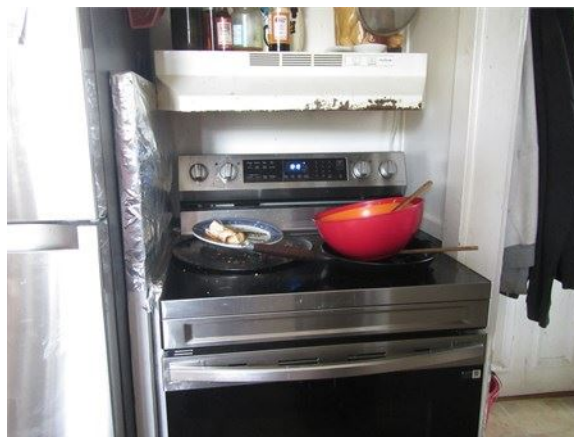
Hotte sans sortie extérieure à l'étage
