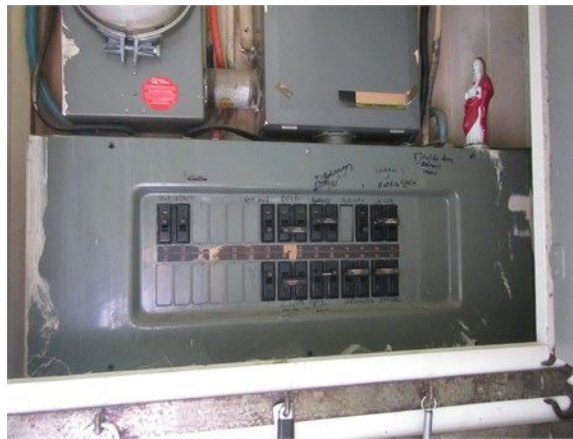
Panneau partiellement coincé dans l'armoire de la cuisine
