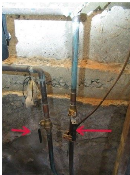
Les deux entrées d'eau dans le vide sanitaire
