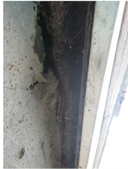
Absence de ventilation de la lame d'air / Absence de moulure anti-rongeurs / Carton fibre intermédiaire ondulé
