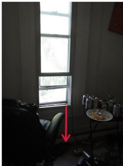
Exemple de fenêtre dont l'appui est trop bas : Protéger l'ouverture pour éviter les chutes accidentelles
