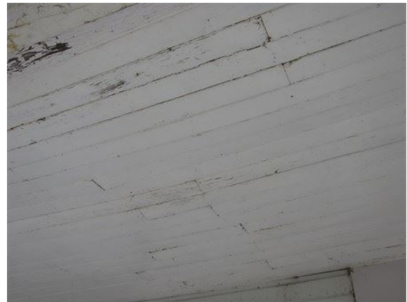
Autres taches d'infiltration d'eau sous le balcon avant de l'étage
