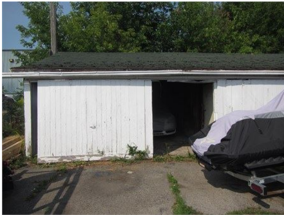
La section gauche du garage vue de face / Noter les bardeaux vieillissants sur la toiture
