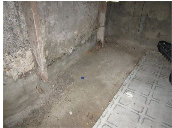
Autres poteaux en contact avec l'humidité du sol
