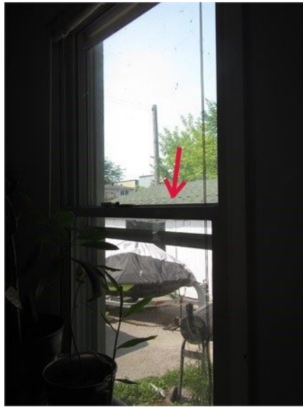
Exemple de fenêtre à guillotine difficile à fermer de manière étanche
