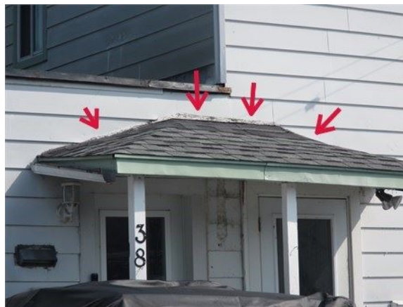
Absence de solins entre la marquise d'entrée latérale et le mur extérieur du bâtiment
