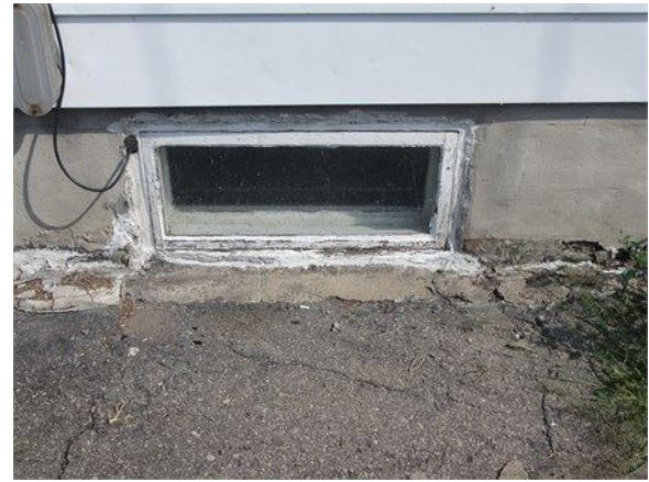
Exemple de fenêtre trop près du sol à dégager
