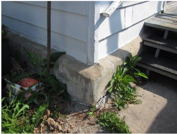
La fondation excède le bardage d'aluminium et ce dernier est à tort scellé avec la fondation, ici le coin arrière gauche
