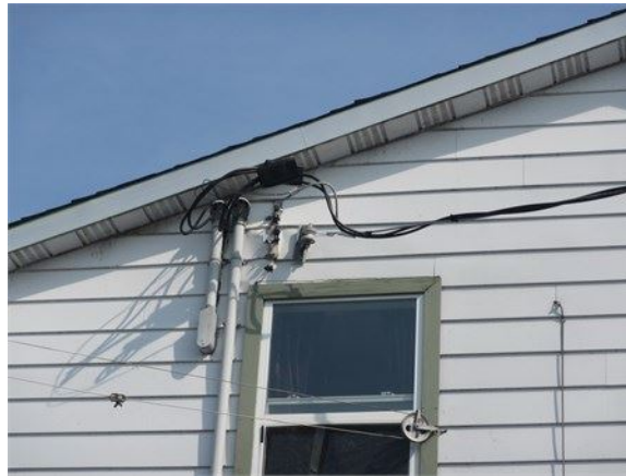
Têtes de mâts électriques trop près d'une fenêtre de l'étage sur le mur latéral gauche
