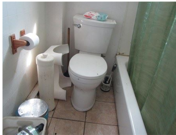
Le plancher de la salle de bains de l'étage penche vers la gauche (droite sur la photo)
