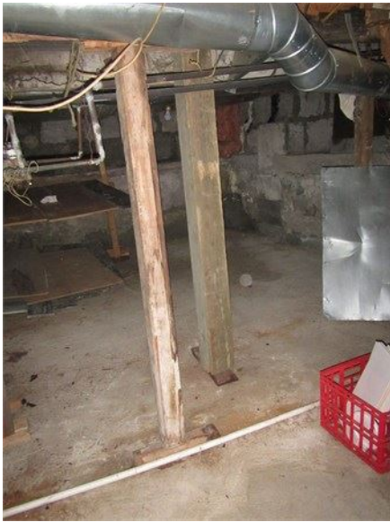
Exemple de poteaux en contact avec l'humidité du sol
