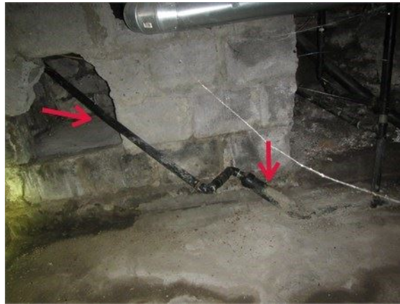
Pente abrupte avec changement de direction qui pourrait causer des blocages
