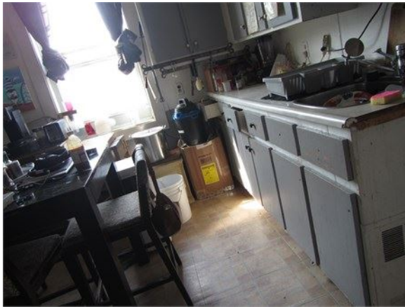
Le plancher de la cuisine penche également vers l'avant
