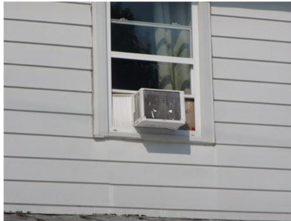
Unité de climatisation dans une fenêtre qui cause habituellement des infiltrations d'eau sous la fenêtre
