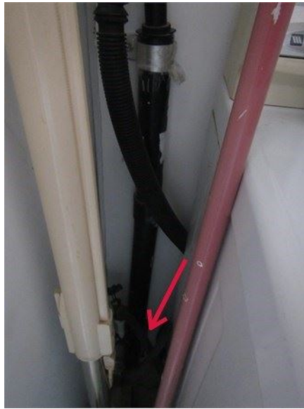
Absence de siphon sur la conduite d'évacuation de la machine à laver au rez-de-chaussée
