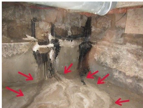
Traces d'infiltration d'eau séchées et actives sur la dalle devant des murs de fondation
