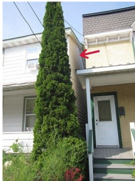
Dégagement limité devant le mur latéral droit
