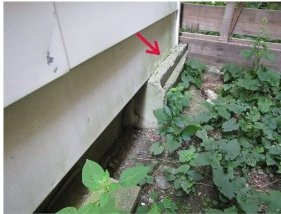
Autre exemple d'une section de mur de fondation qui excède le bardage d'aluminium
