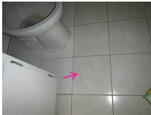
Carreau fissuré dans la salle de bains principale
