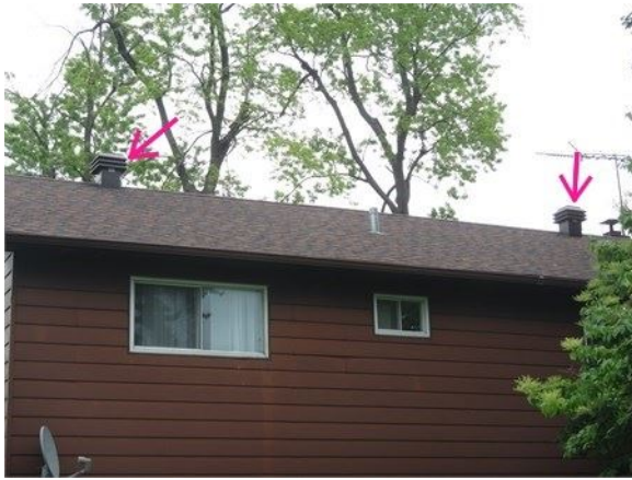
Les deux aérateurs de type "Maximum" sur la pente arrière du toit
