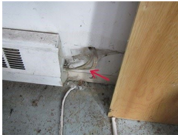
Câbles apparents dans le garage à protéger
