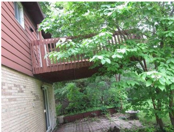
Pente négative de la terrasse arrière exagérée par la photo
