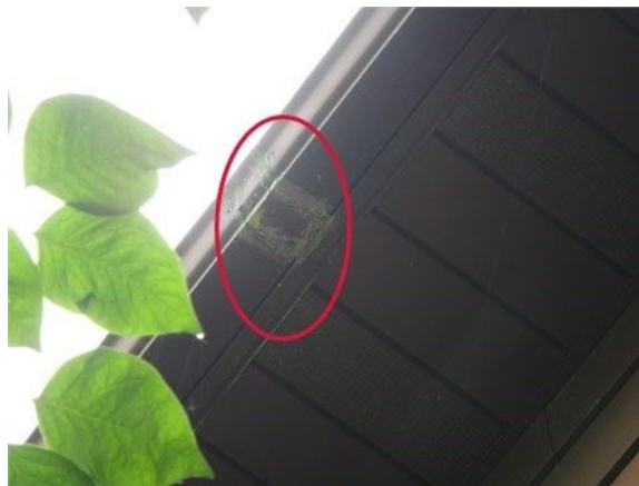
La gouttière arrière fuit
