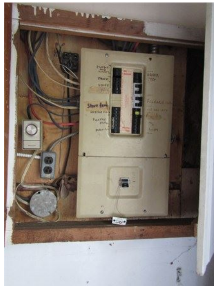
Le panneau de distribution électrique sur le mur droit du garage
