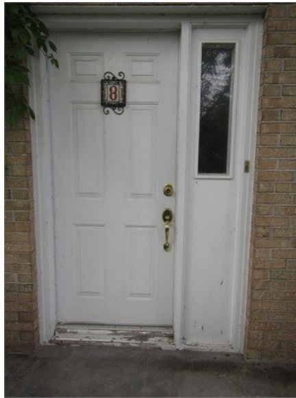
Porte avant et caisson adjacent à remplacer
