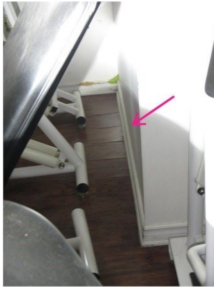
Parquet déformé le long du mur de l'escalier à investiguer
