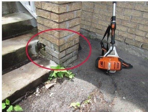
Base du pilier de briques à l'avant à rejointoyer
