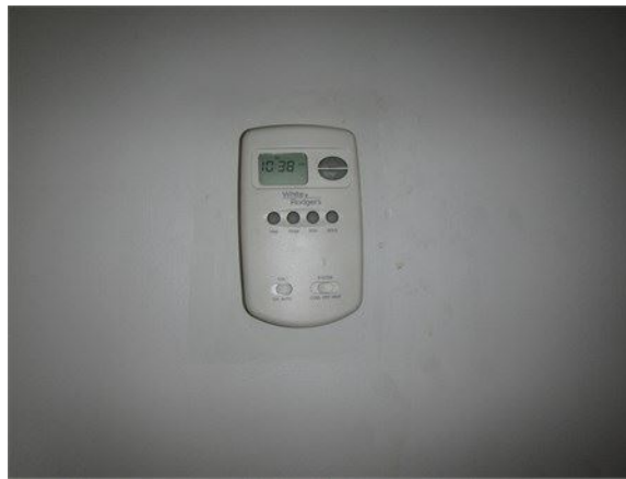
Le thermostat central au rez-de-chaussée
