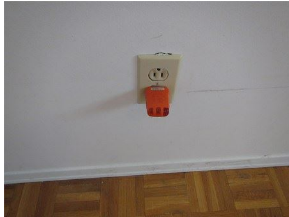
Prise défectueuse dans une des chambres avant
