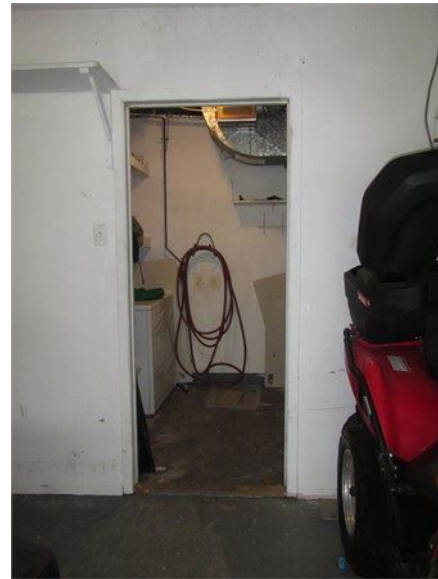
La porte entre la salle de la fournaise et le garage : Installer un ferme-porte et un coupe-froid tout autour de la porte y compris sur le seuil
