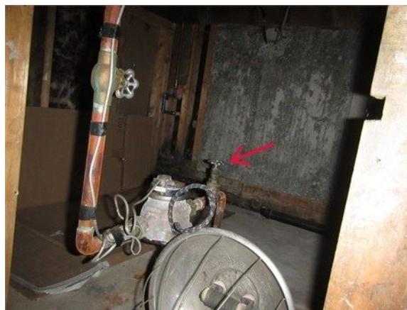
Le robinet d'arrêt d'eau principal
