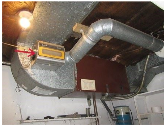
L'humidificateur rotatif sur le système de chauffage
