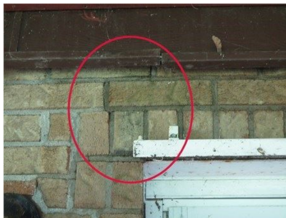
Fissure en escalier au coin supérieur droit de la porte-fenêtre du rez-de-jardin
