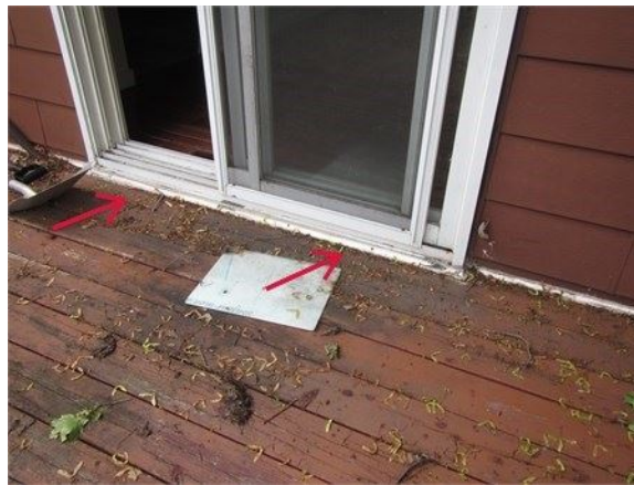
Seuil de la porte-fenêtre trop près de la surface de la terrasse
