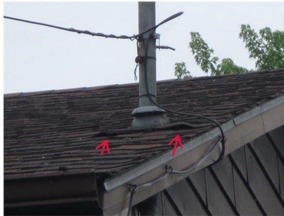
Solin sous les bardeaux et bardeaux soulevés : Vérifier l'installation
