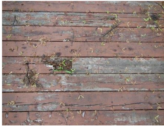
Exemple de lattes à remplacer et à repeindre
