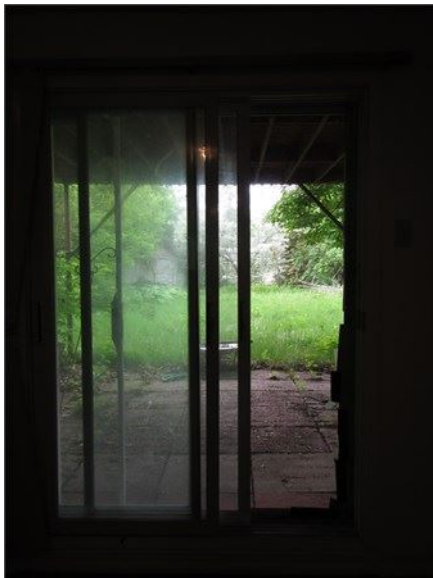
Porte-fenêtre du rez-de-jardin difficile à ouvrir
