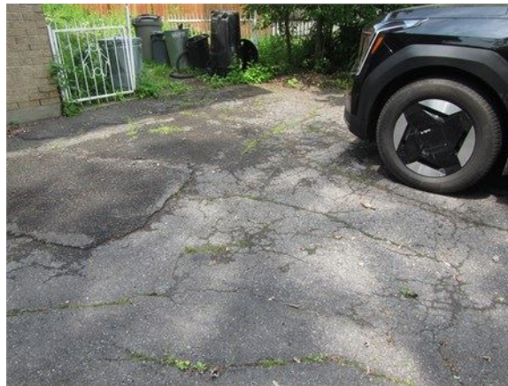
Entrée d'asphalte fissurée à réparer
