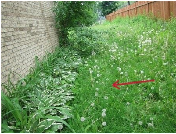
Pente négative sur le mur latéral droit
