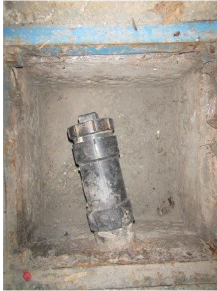
Fosse de retenue vide dans le garage : remettre de l'eau propre
