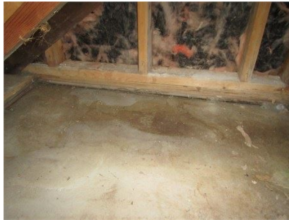
Taches séchées sur la dalle sous l'escalier du sous-sol à surveiller
