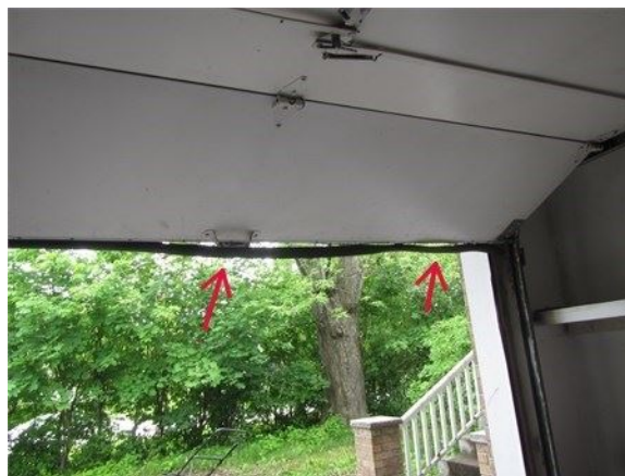
Coupe-froid à remplacer sous la porte du garage
