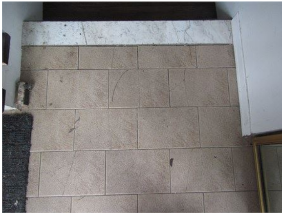
Carreaux à remplacer dans le portique d'entrée
