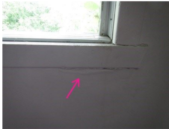
Gypse et peinture déformés
