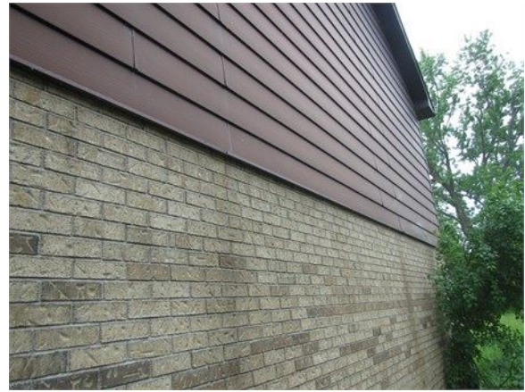
Bardage d'aluminium trop près du parement de briques pour ventiler la lame d'air derrière le bardage d'aluminium, ici le mur latéral droit
