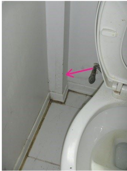
Gypse déformé le long du meuble lavabo à surveiller par prudence
