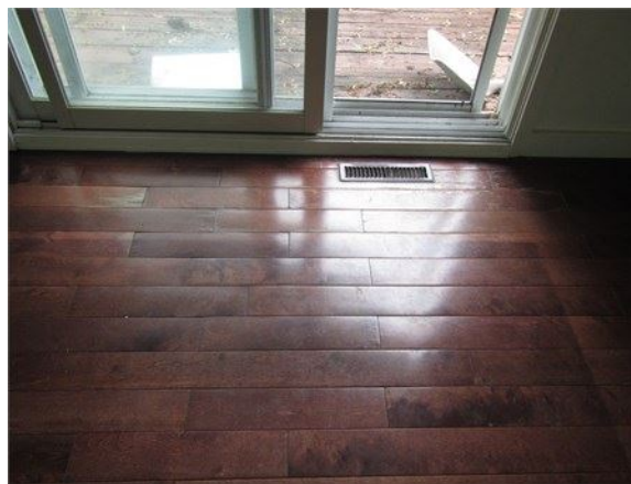
Parquet déformé probablement par des infiltrations d'eau
