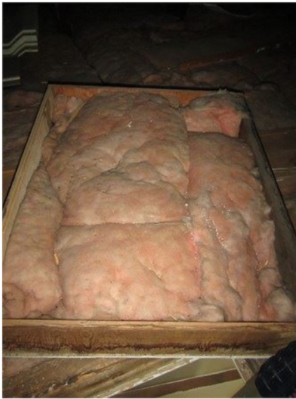
La trappe d'accès à l'entretoit est peu isolée
