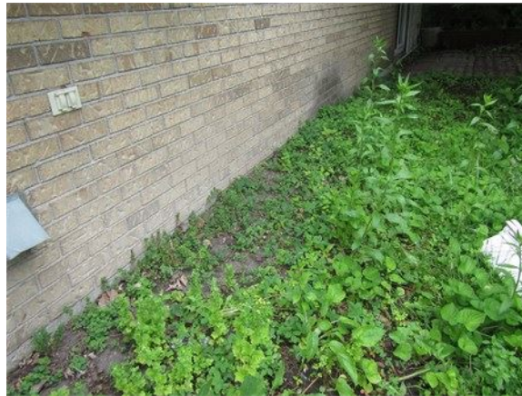
Exemple de parement de maçonnerie trop près du sol à l'arrière
