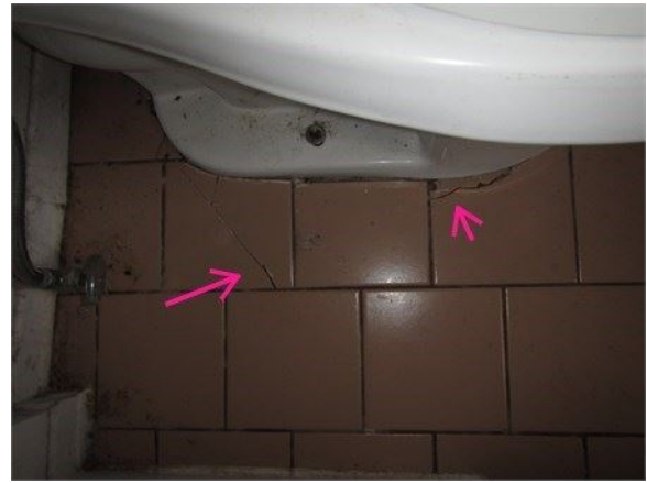
Quelques carreaux fissurés autour de la toilette au rez-de-jardin
