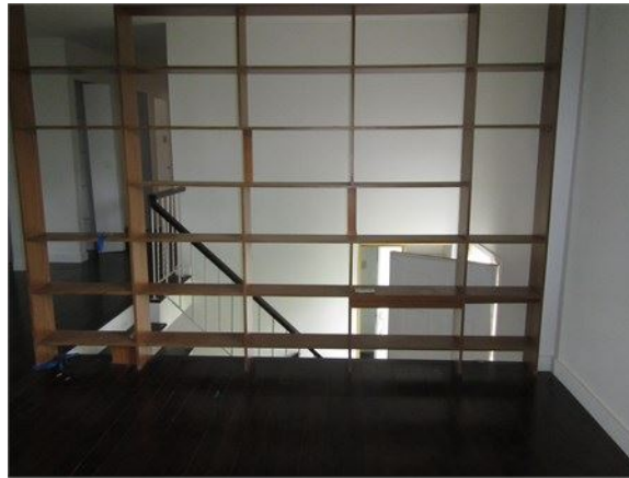
Absence de garde-corps entre le séjour et l'escalier
