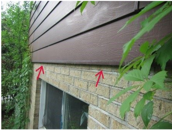
Bardage d'aluminium trop près du parement de briques pour ventiler la lame d'air derrière le bardage d'aluminium, ici le mur avant
