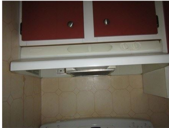
Hotte non fonctionnelle à l'inspection
