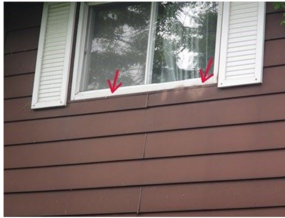
Exemple d'absence de solin sous une fenêtre dans le bardage d'aluminium
