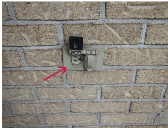
Exemple de prise extérieure sans DDFT
