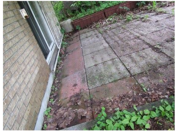
Pente négative sur le mur arrière et sol trop haut sur le mur
