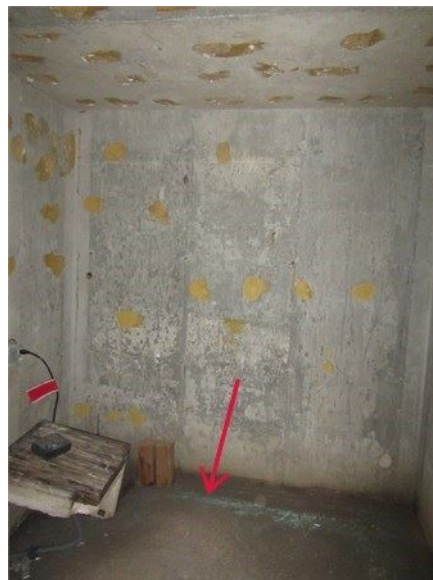
Dalle de la chambre froide saturée d'eau
