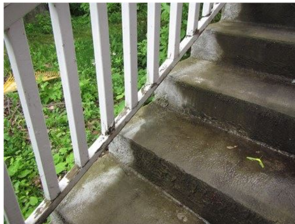
Section de garde-corps en bois à remplacer à l'avant
