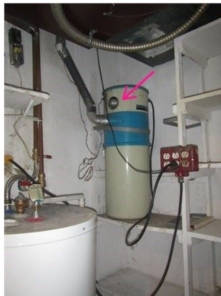
L'aspirateur central rejette son air à l'intérieur de la salle de la fournaise, ce qui n'est pas souhaitable
