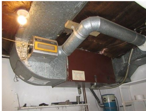
Le système de chauffage au plafond de la pièce à l'arrière du garage
