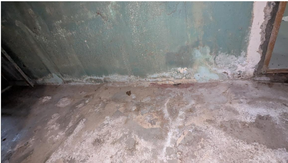
Efflorescence sur de la dalle de béton en sous-sol à cause de l'humidité
