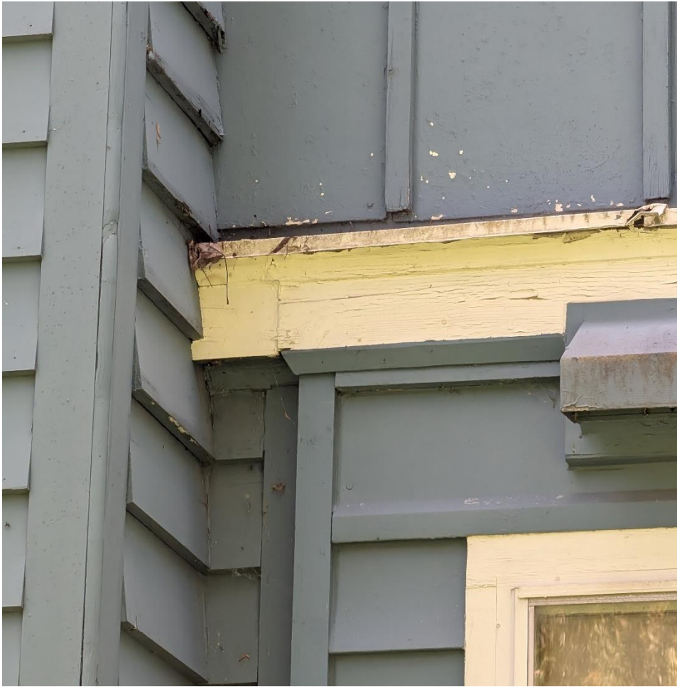
Exemples de manque des joints de scellement
