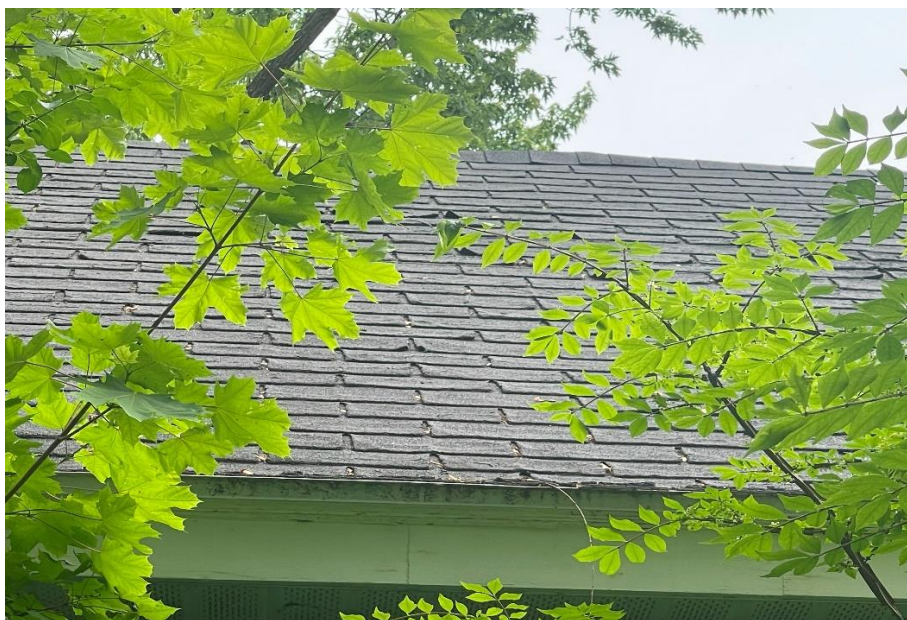
Bardeaux décollés et manque des gouttières.
