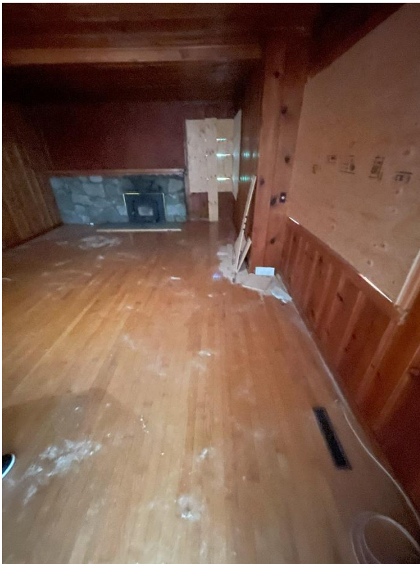
Exemple de penchement dans le plancher vers le mur du foyer
