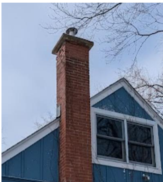
Exemple des briques cassés et manquantes
