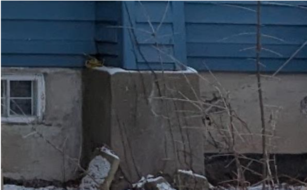
Exemple du manque des solins à la transition entre les matériaux et murs de bois en retrait vis-à-vis la face du béton
