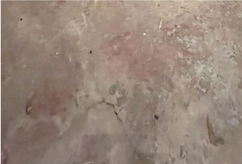
Exemple fissures dans la dalle du sous-sol
