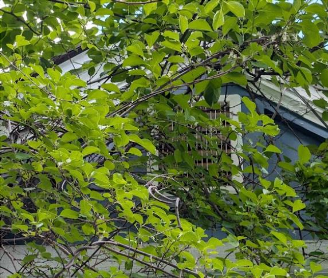
Grille de ventilation de l'entretoit
