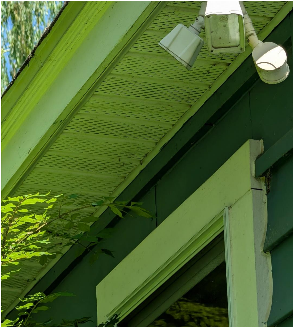
Exemples des soffites et fascias détériorés
