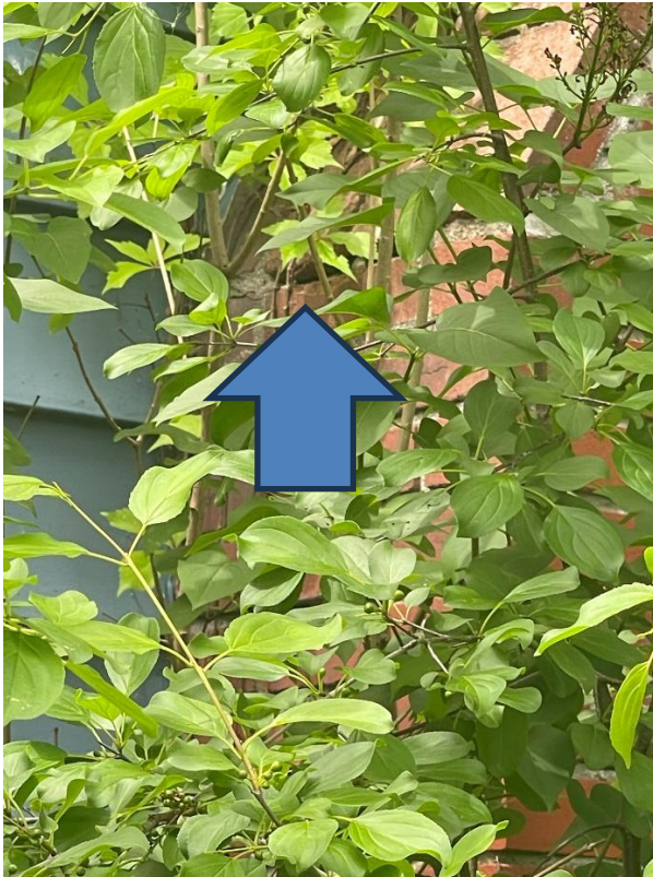
Exemple des briques cassés et manquantes
