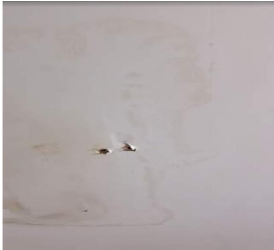
Traces d'humidité sur le plafond de RDC
