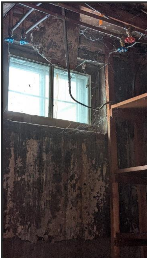
Exemple des taches d'humidité sur le mur de fondation en béton
