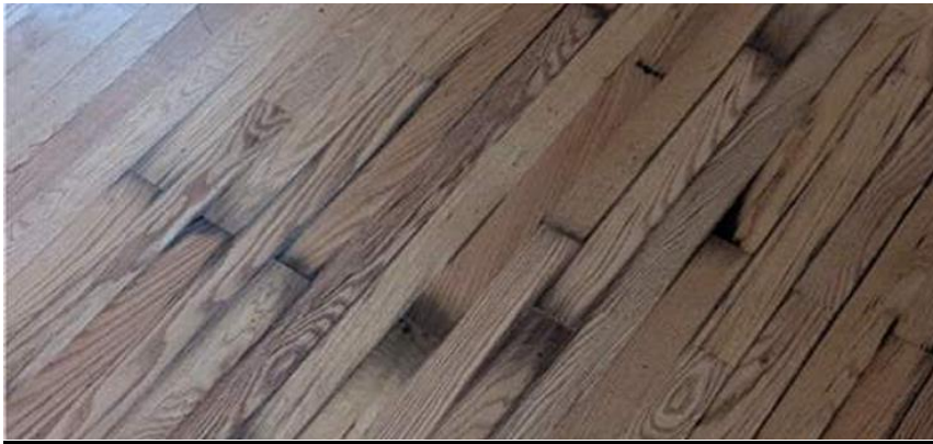
Exemple de noircissement des planches de bois du plancher
