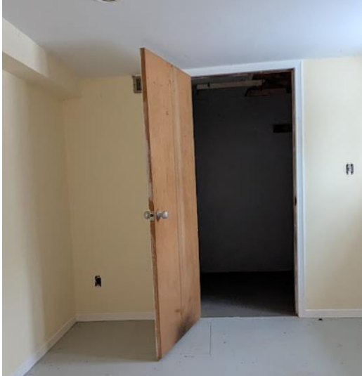
Exemple de porte tachée à cause de l'humidité
