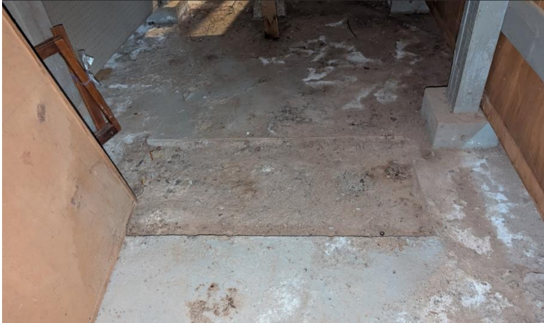
Exemple des fissures et efflorescence dans dalle de béton du sous-sol
