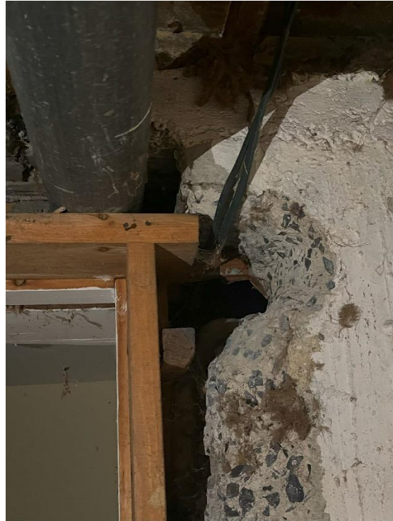
Mur intérieur de béton cassé
