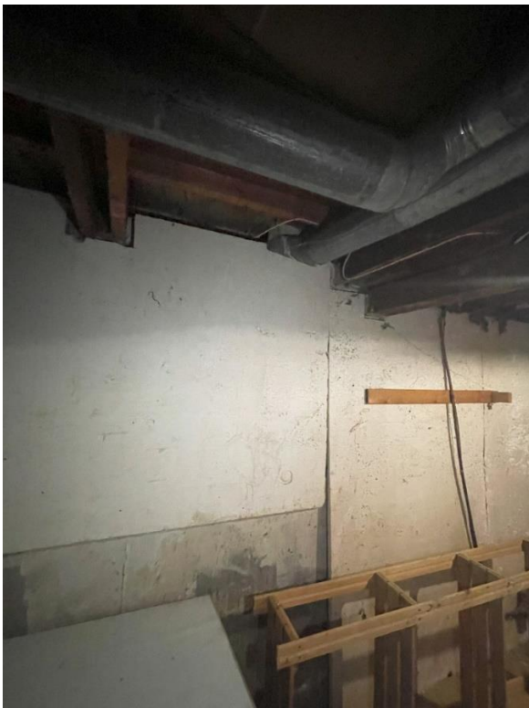
Exemple du manque d'isolation sur les murs
