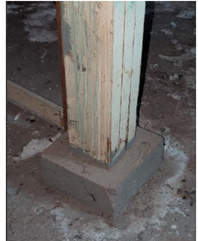
fissures dans la base de béton
